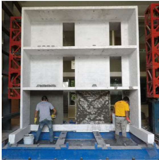
Figura 1.4 Modelo MCR2 de mampostería rehabilitado por encamisado de malla tomada de (Gonzalez Parra, 2020)
