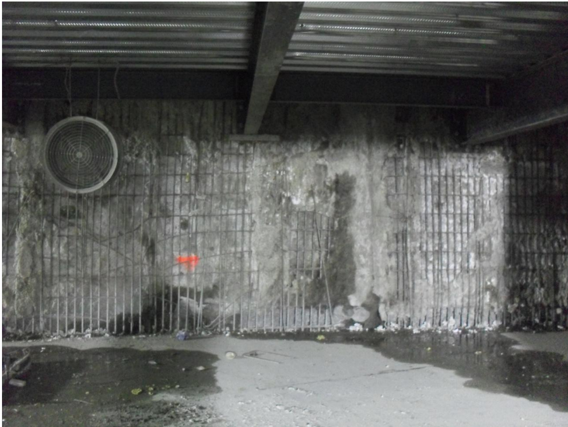
Fotografía 57.- Acero de refuerzo expuesto muro Milán.
