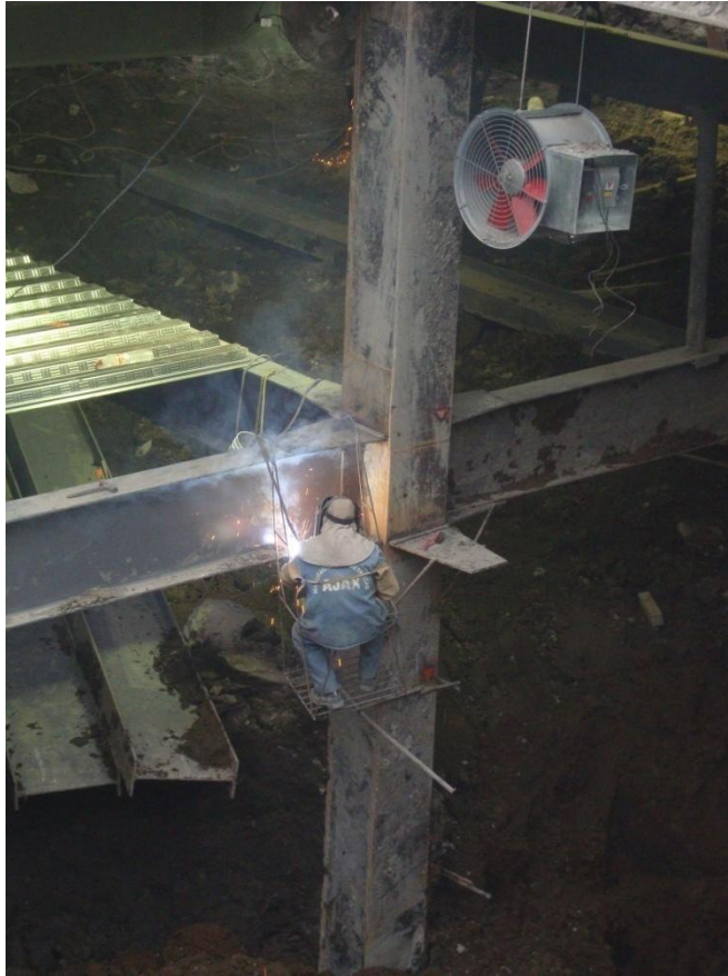
Fotografía 56.- Ventilador de extracción
