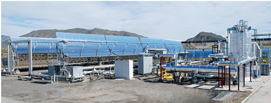
Figura 2.7 Vista del lazo de ensayos.
