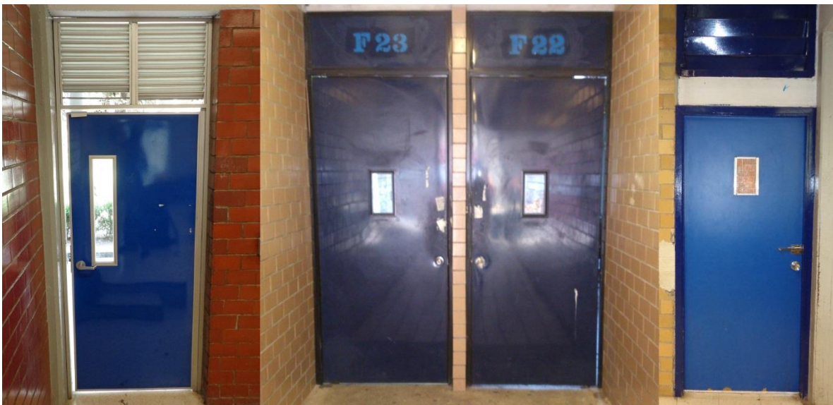
Figura 5.40. Mal aislamiento acústico en puertas de los tres tipos de salones.
