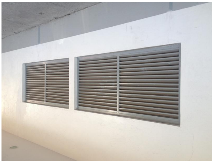
Figura 2.4. Ventana tipo louver del cuarto de máquinas.
