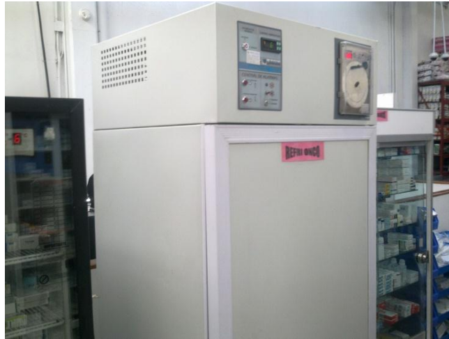
Figura 2.3. Equipo de refrigeración.
