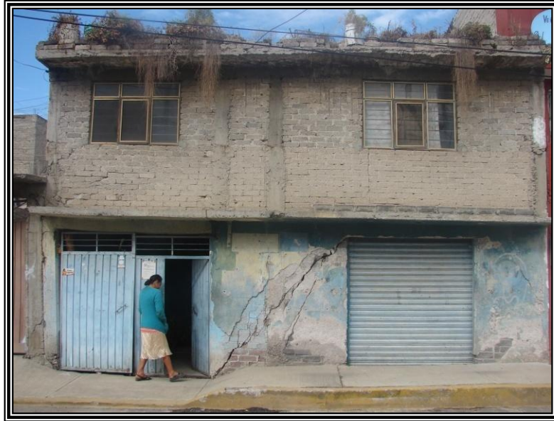
Figura 6.3. Ejemplo de los daños estructurales en la colonia El Edén.
