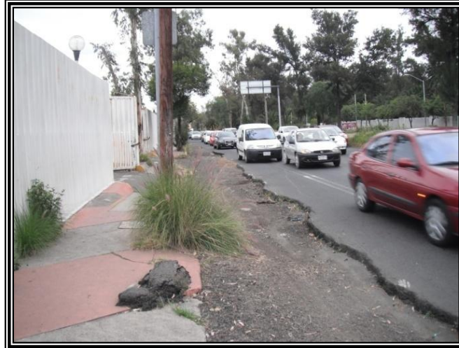
Figura 6.9. Ejemplo de los daños estructurales en la calle José Loreto Fabela, inmediaciones del Bosque de Aragón.
