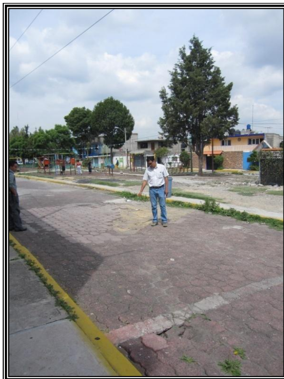
Figura 3.32. Imagen que muestra el daño en el adoquín de Avenida de las Torres, en la colonia Lomas de San Lorenzo.
