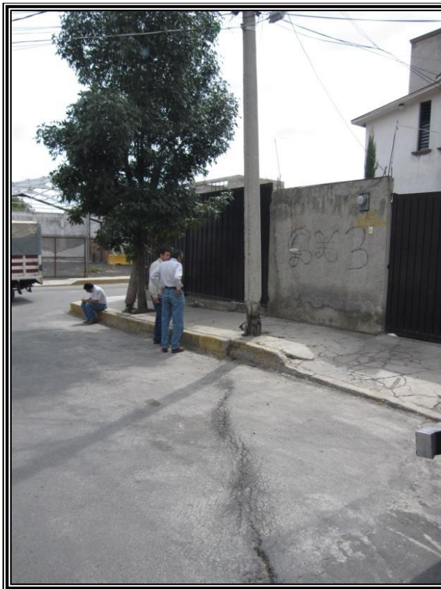
Figura 3.28. Imagen que muestra el daño en el pavimento de la calle Guadalupe Victoria, en la colonia Lomas de San Lorenzo.
