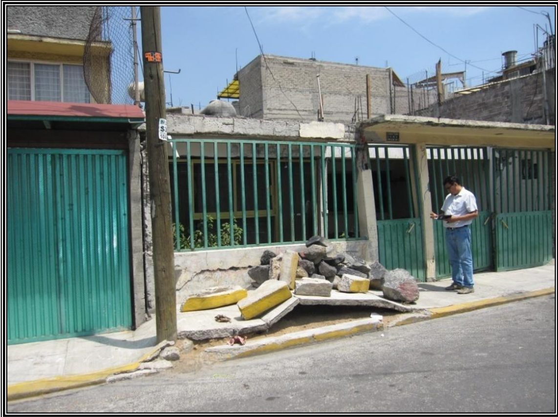
Figura 3.23. Imagen que muestra el daño existente en una banqueta de la calle María Isabel, en la colonia El Edén.
