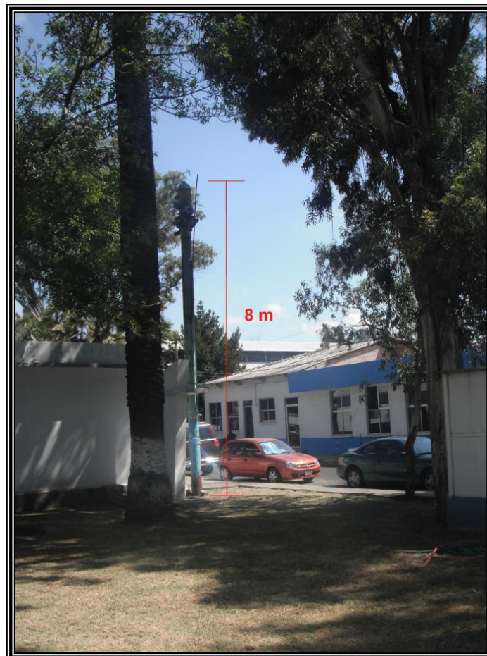
Figura 5.14. Imagen que muestra un equipo de bombeo a una altura aproximada de 8 metros, y que debería estar a nivel del piso.
