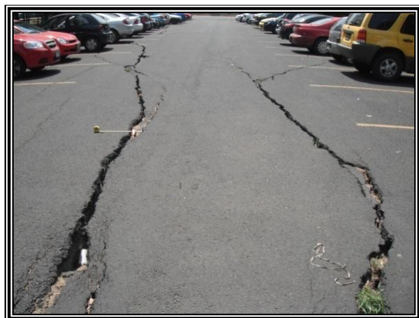
Figura 6.19. Ejemplo de los daños estructurales en la Alameda del Norte, Pueblo Santa Bárbara.
