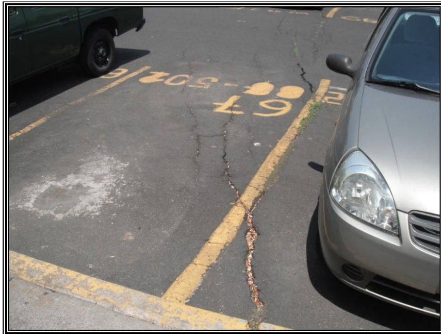
Figura 3.85. Imagen que muestra el daño en el pavimento de la calle Retorno 3, ocasionado por fracturas.
