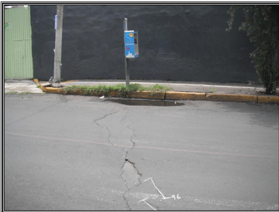
Figura 3.78. Imagen que muestra el daño en el pavimento y en las guarniciones de las banquetas en Av. México, barrio de San Marcos.
