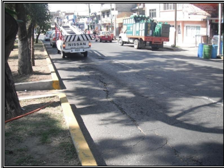
Figura 6.11. Ejemplo de los daños estructurales en la colonia Ampliación Casas Alemán.
