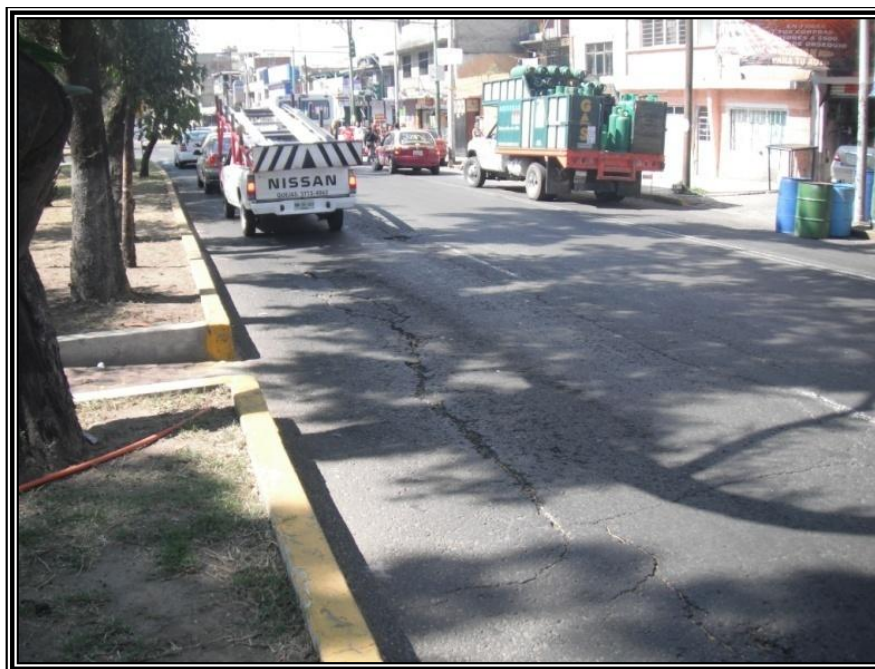
Figura 3.66. Fotografía que muestra daños en el pavimento de la calle José Loreto Fabela, en la colonia Ampliación Casas Alemán.
