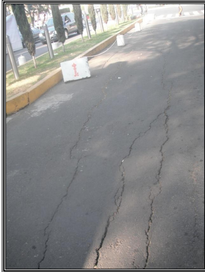
Figura 3.75. Fracturas en el pavimento de Avenida de Tzinnias, colonia Jardines de Coyoacán.
