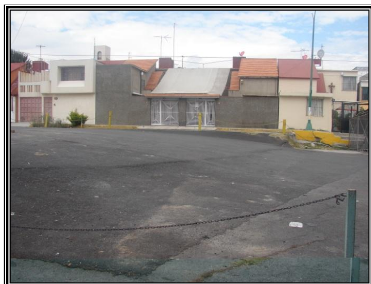
Figura 3.20. Imagen que muestra una falla en calle José Pagola, colonia Popular Ermita Zaragoza.
