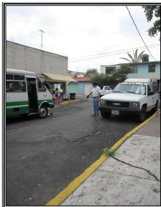
Figura 6.8. Ejemplo de los daños estructurales en la colonia Jacarandas.
