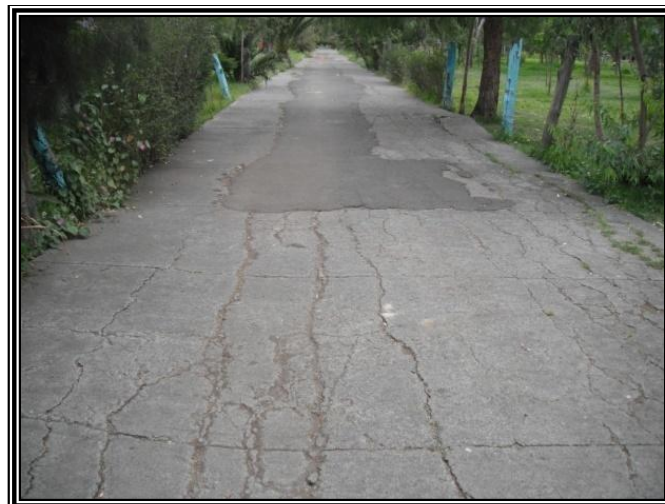
Figura 3.52. Imagen que muestra los daños en el pavimento de las calzadas del Bosque de Aragón, en Gustavo A. Madero.
