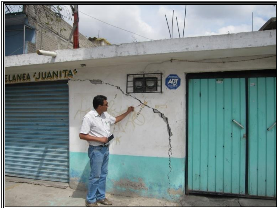
Figura 3.31. Imagen que muestra el daño en la pared de una casa en Avenida de las Torres, en la colonia Lomas de San Lorenzo.
