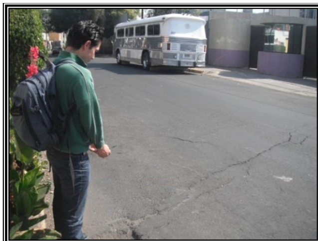
Figura 1.4.4. Toma de rumbo de fracturas en el pavimento de Av. México, Xochimilco D.F.
