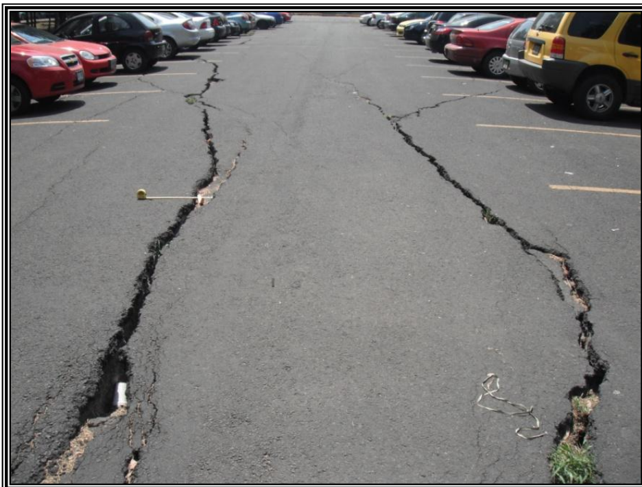
Figura 3.88. Imagen que muestra el daño ocasionado en el pavimento del estacionamiento de la Alameda Norte, Pueblo Santa Bárbara.
