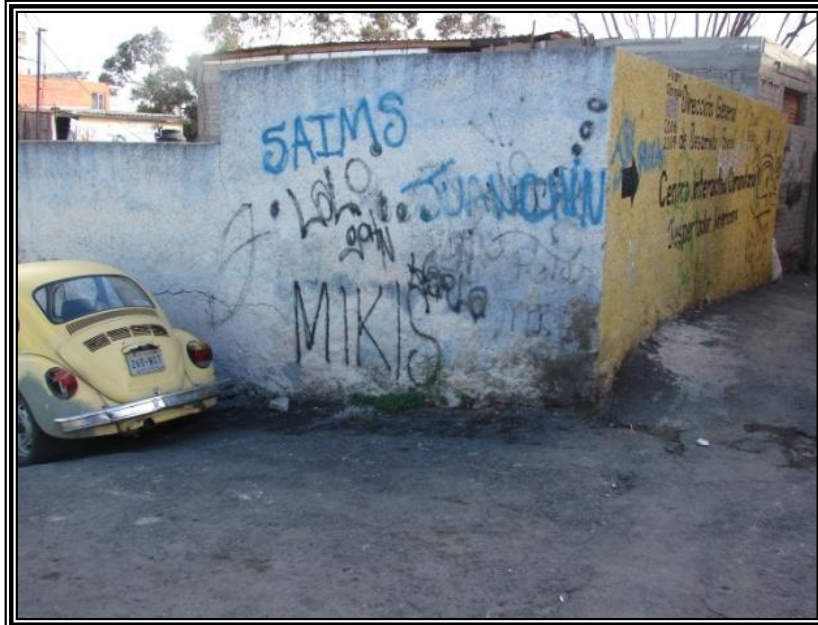
Figura 3.100. Imagen que muestra el daño en la pared de una casa en calle Despertador Americano, en la colonia Barrio Norte.
