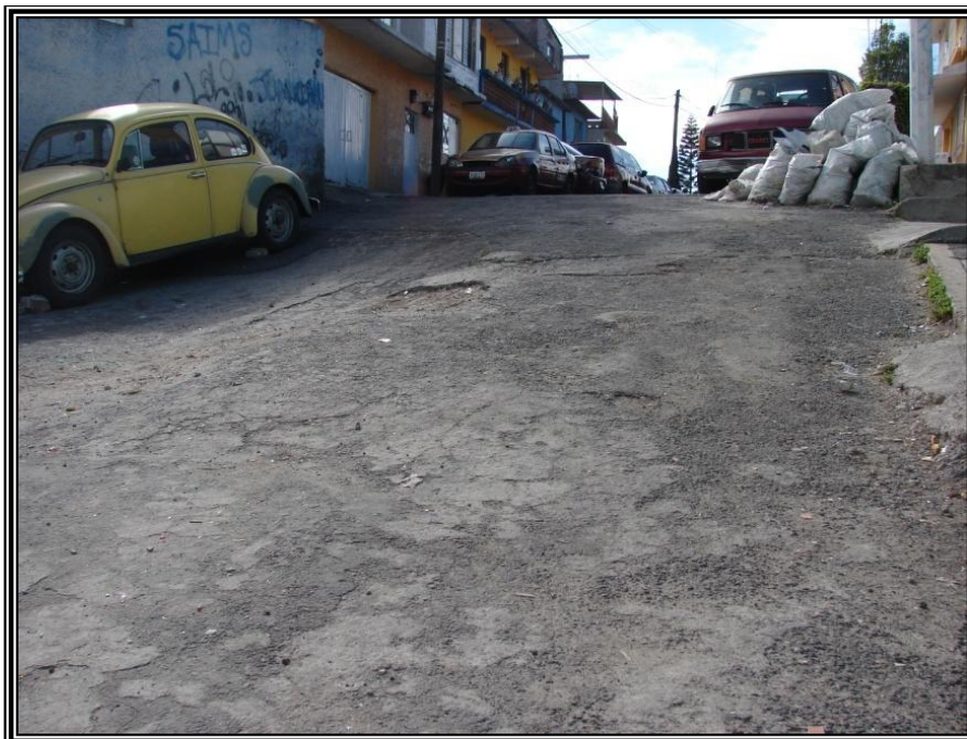
Figura 3.99. Imagen que muestra el daño en el pavimento de la calle Despertador Americano, en la colonia Barrio Norte.
