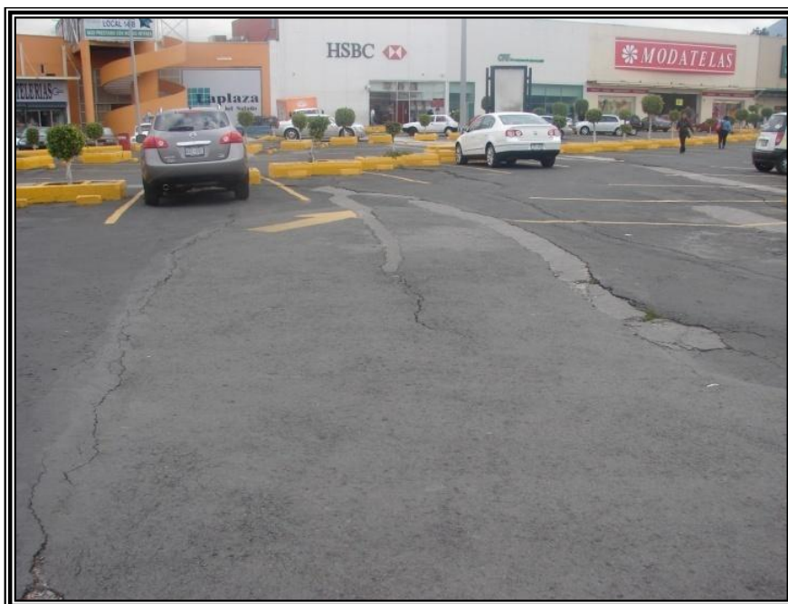
Figura 3.14. Imagen que muestra las fracturas en el estacionamiento de la plaza comercial El Salado, Concordia Zaragoza.
