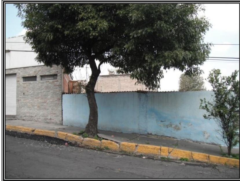
Figura 3.11. Fractura y levantamiento ocasionado por el efecto de raíces.
