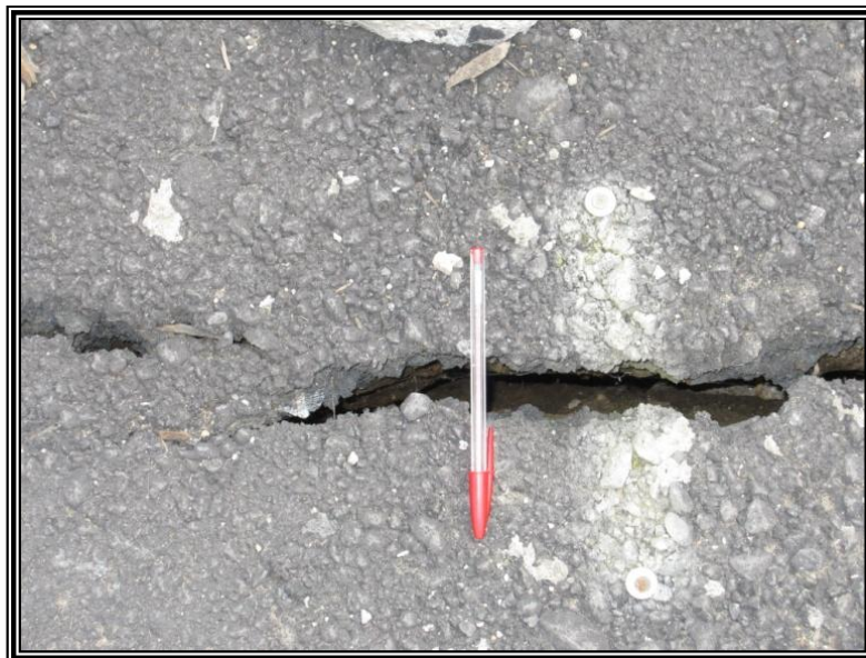
Figura 3.30. Imagen que muestra el daño en el pavimento del estacionamiento en calle Vista Hermosa, en la colonia Lomas de San Lorenzo.
