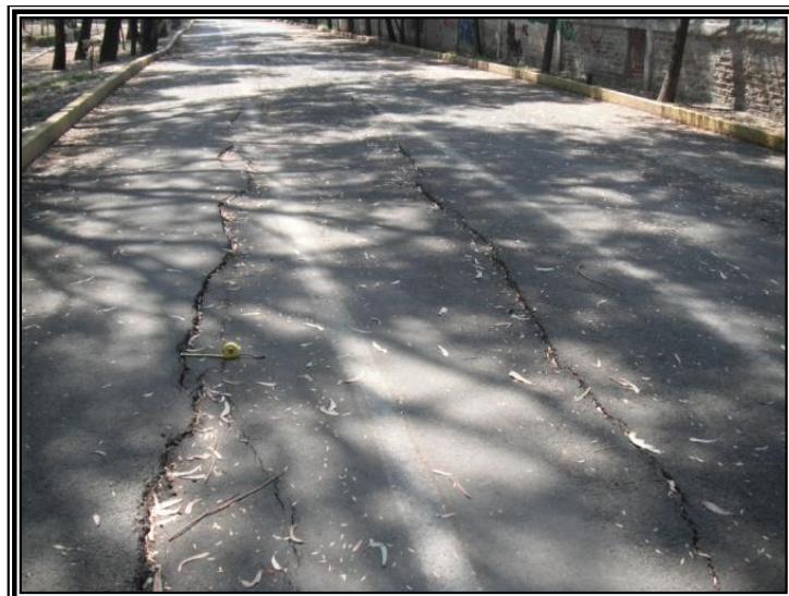
Figura 1.4.12. Fotografía en la que se muestra la dirección del fracturamiento en un sitio en Azcapotzalco D.F.
