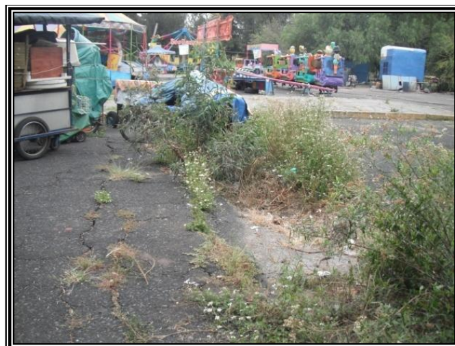
Figura 3.53. Imagen que muestra los daños ocasionados en el pavimento por una falla normal, en el Bosque de Aragón.
