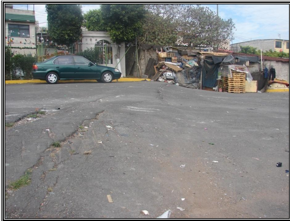
Figura 3.17. Imagen que muestra una falla en calle Cedros, colonia Concordia Zaragoza.
