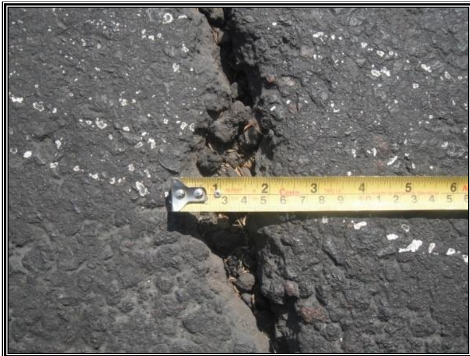
Figura 1.4.7. Medición de la abertura de una fractura en el pavimento de Av. México, Xochimilco D.F.
