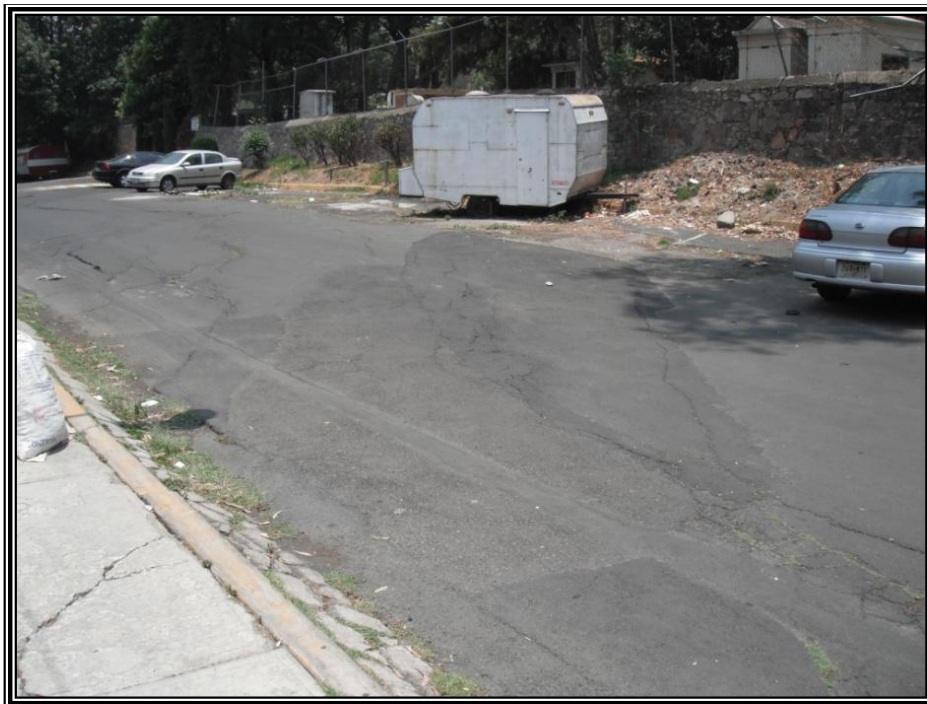
Figura 3.82. Imagen que muestra el daño en el pavimento en Mártires de Río Blanco, U. H. Rinconada del Sur.
