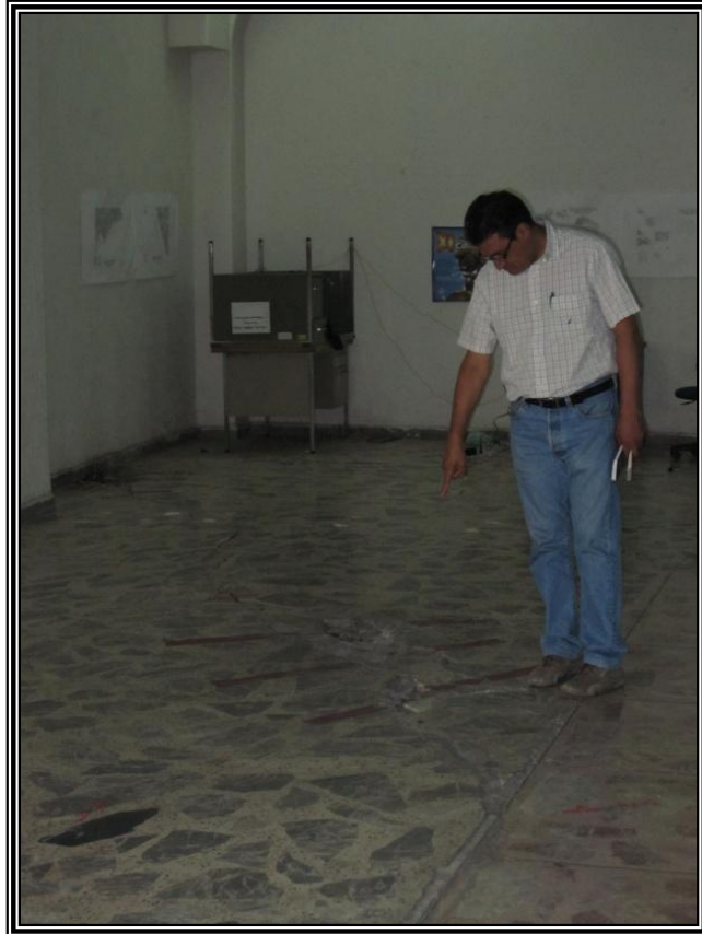
Figura 3.27. Imagen que muestra el daño dentro del salón de fiestas, en la calle Vista Hermosa, colonia Lomas de San Lorenzo.
