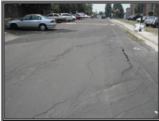
Figura 6.18. Ejemplo de los daños estructurales en la U.H. Rinconada del Sur, en la colonia Huichapan.
