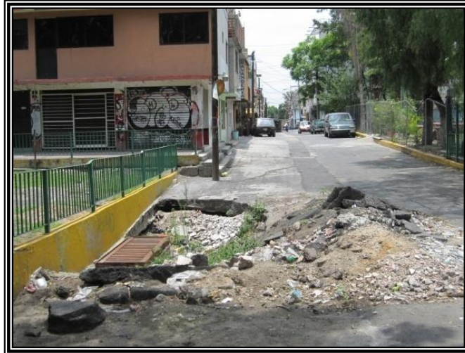
Figura 6.7. Ejemplo de los daños estructurales en la colonia Santa Cruz Meyehualco.
