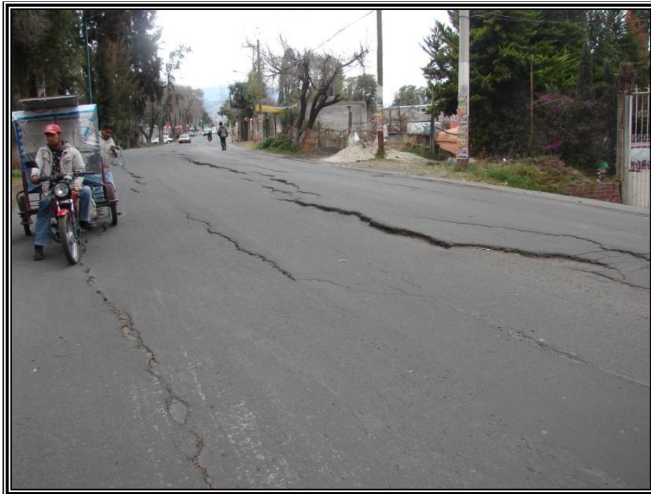
Figura 3.97. Imagen que muestra el daño en la calle Emiliano Zapata, en el Pueblo San Andrés Mixquic.
