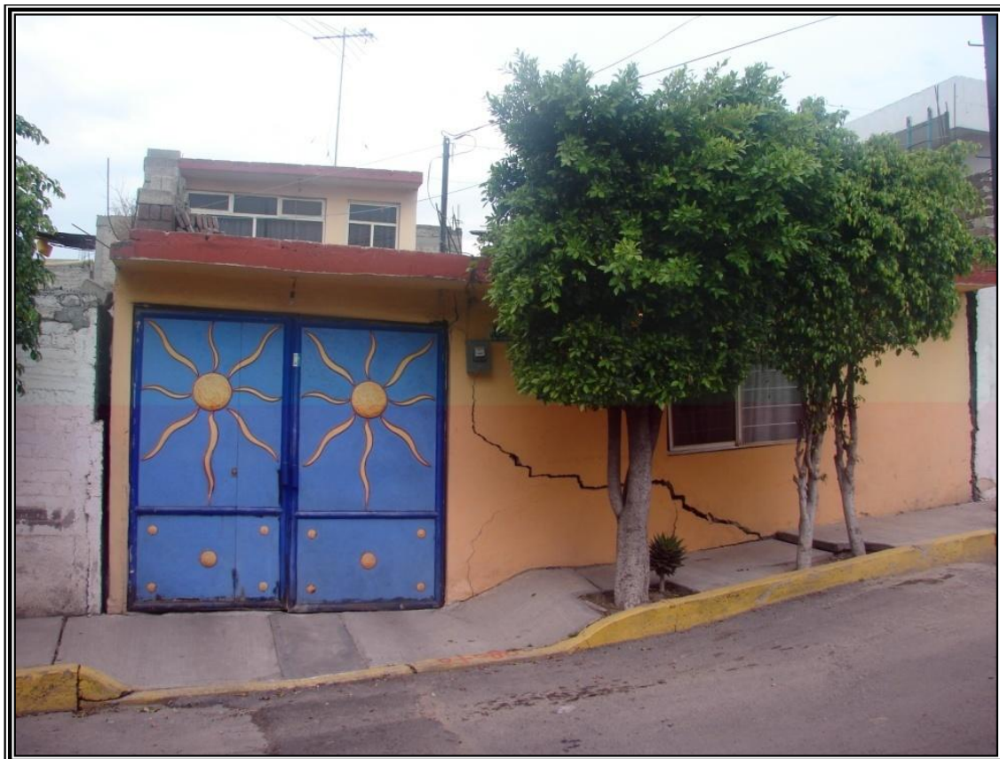
Figura 3.24. Imagen que muestra daños estructurales en una casa ubicada en la calle María Eugenia, colonia El Edén.
