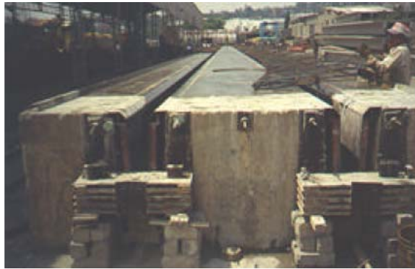
FIGURA 28. MESAS DE COLADO
