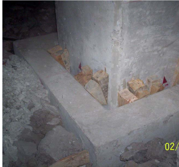
FIGURA 21. UNIÓN DE COLUMNA A LA CIMENTACIÓN
