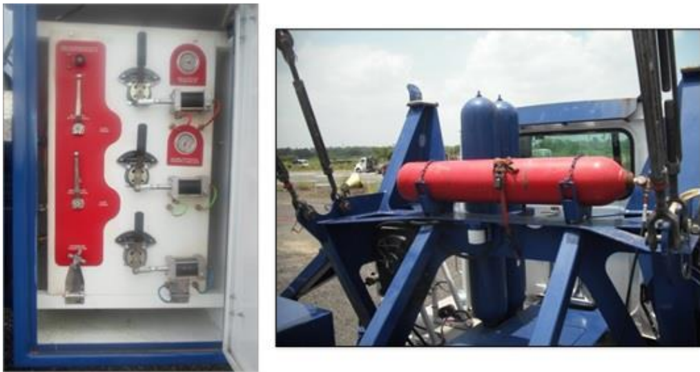
Figura 2.29 Sistema de Acumuladores
