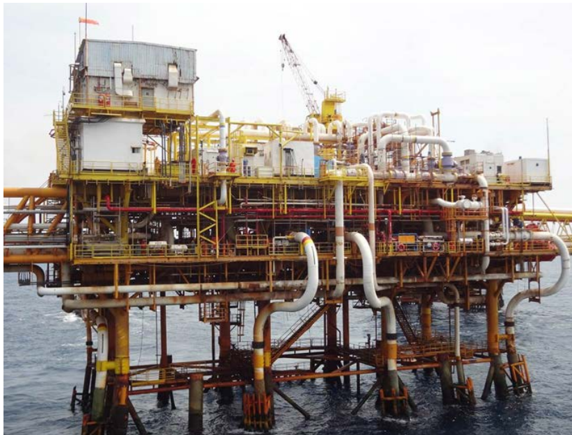
Figura 2.32. Plataforma de Enlace. (PE-Abkatún-A)
