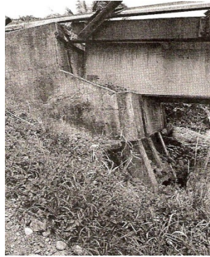
Figura1.4 Rotación del estribo (Costa Rica 1990)
