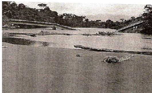
Figura1.2 Pérdida de apoyo de la Subestructura (Costa Rica 1990)
