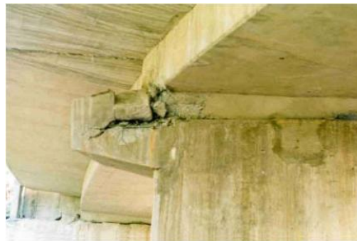
Figura 1.5 Falla en topes (México 1985)
