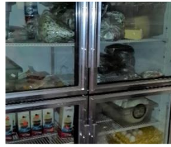
Equipos de refrigeración
