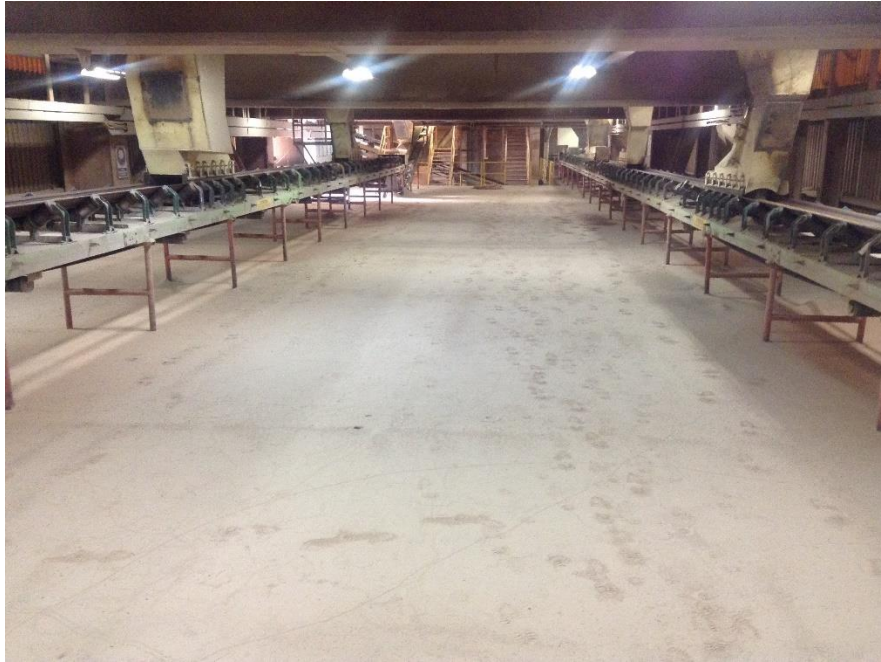
IMAGEN 4.7.3.3. BANDAS TRANSPORTADORAS DE MATERIAS PRIMAS, PARA MOLIENDA DE HARINA CRUDA.
