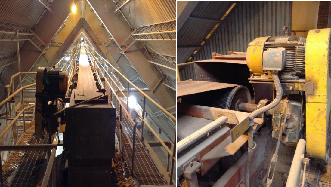
IMAGEN 7.3.1. BANDA 9 – 10, TRANSPORTE DE MATERIAS PRIMAS, ABRASIVOS.
