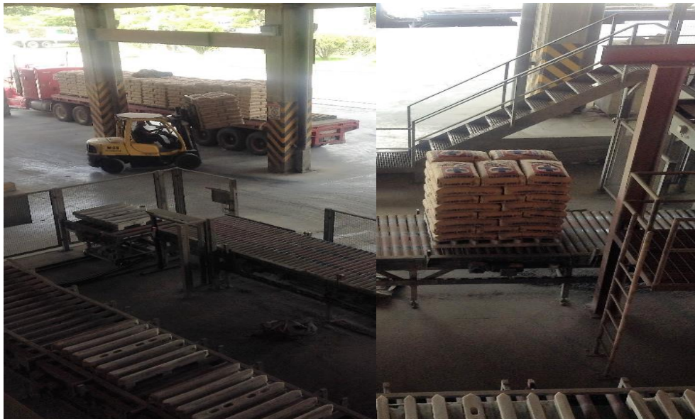
IMAGEN 4.14.4. SISTEMA 1 AUTOMATIZADO DE ESTIBADO.
