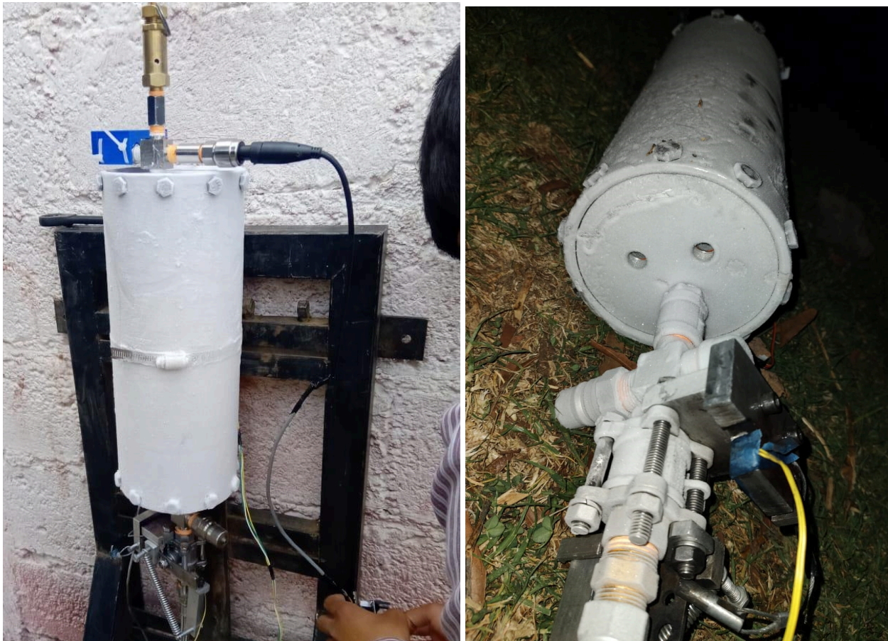
Figura 52. Sistema provisional cubierto de escarcha por el enfriamiento de la expansión de los gases.
