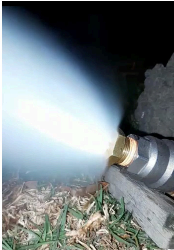
Figura 51. Fuga en tubería debido a la mala aplicación de teflón y bajo torque (Arriba) y prueba exitosa de inyectores (Abajo).
