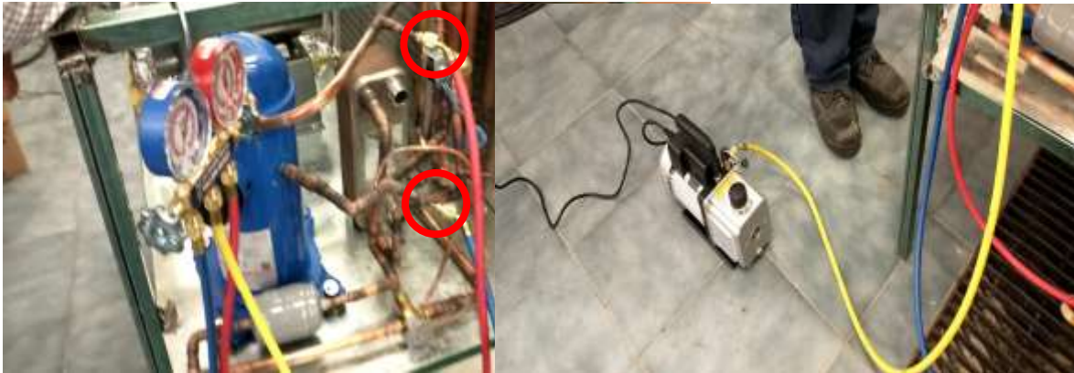
Imagen 157 Conexiones del manifold con las tuberías de alta y baja, así como la bomba de vacío
