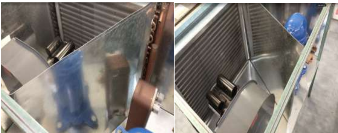
Imagen 148 Pared en el interior de la BCG para la separación del ventilador y el radiador
