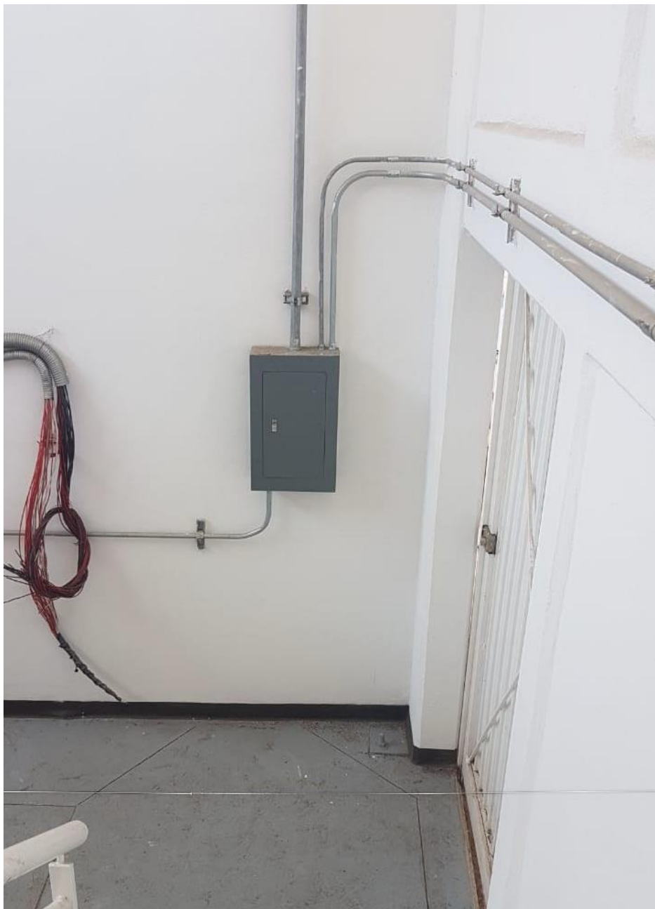
Figura 3.14 Instalación eléctrica final
