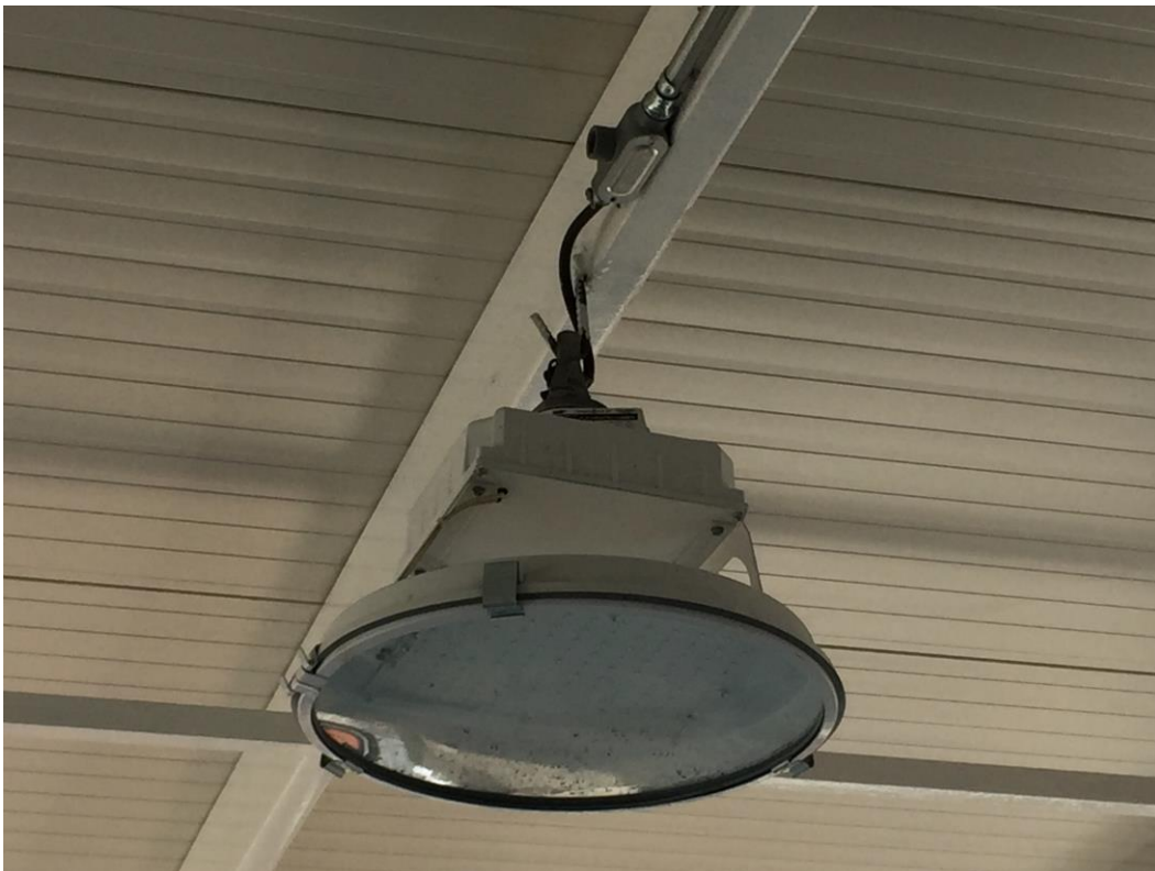
Figura 3.8 Instalación de luminario solaled de 150 W
