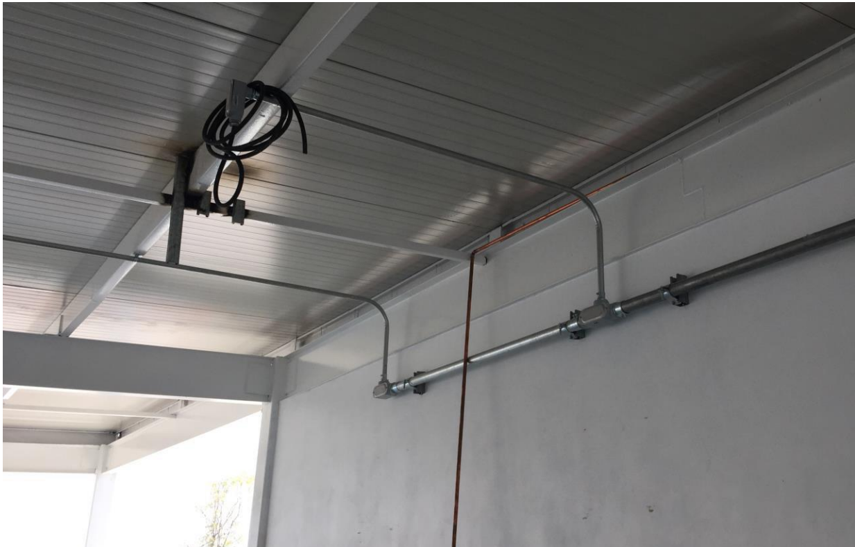
Figura 3.6 Instalación de cable de uso rudo para alimentar motores y bancos de resistencias
