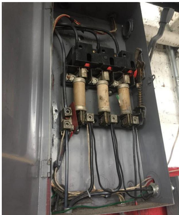
Figura 3.10 Acometida principal del taller mecánico
