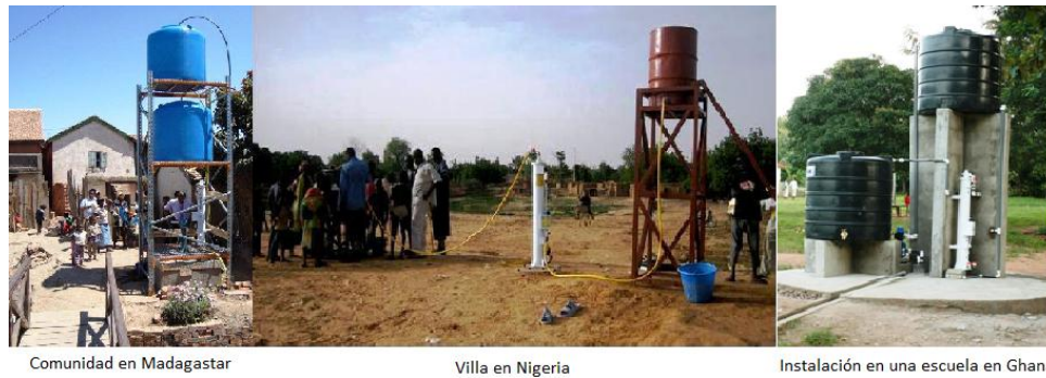
Figura 4.13 Ejemplos de instalaciones de SkyHydrant™/SkyStation™ en África.
