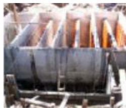
Figura 4.31 Construcción del reactor anaerobio con deflectores en un mercado público en Negros Oriental, Filipinas.
