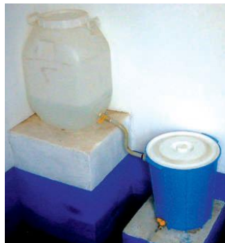
Figura 4.24 Hipoclorador en el municipio boliviano Sica Sica.
