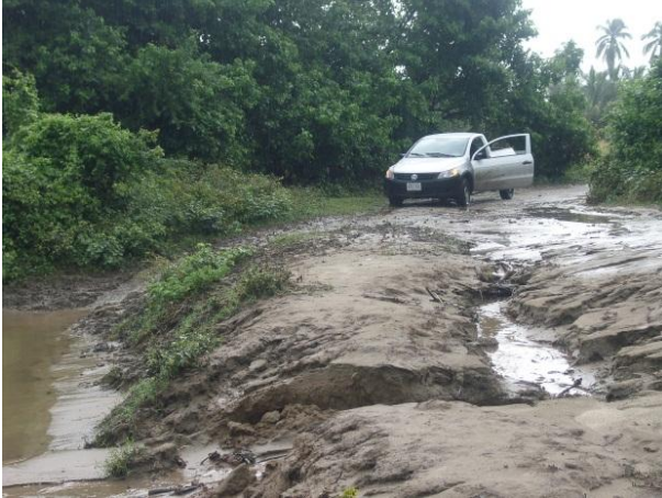
Fotografía 20- Erosión en las laderas del Rio Coyula
