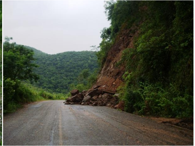
Fotografía 8.- Derrumbe en la comunidad del Jardín
