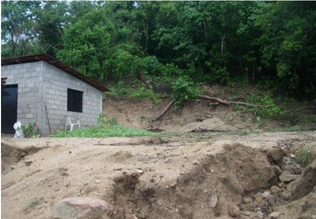
Fotografía 9.- Deslizamiento Bajos del Arenal
