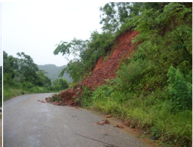
Fotografía 6.- Derrumbe rumbo a la comunidad Benito Juárez
