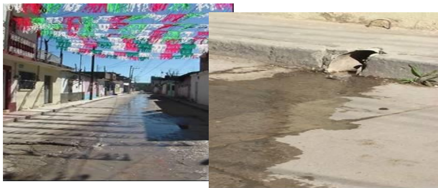
El agua residual en calles
