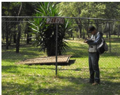
Fotografía 7. Hundimiento relleno y resguardado con malla ciclónica, con la finalidad de evitar accidentes.
