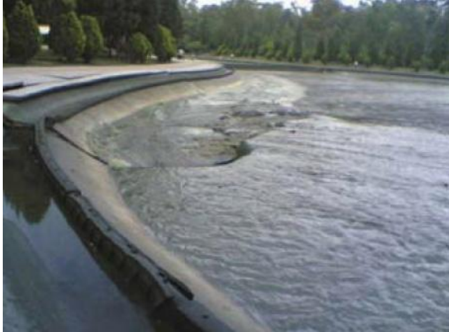
Fotografía 10. Fuga del Agua del Lago Mayor. BCH. 2006
