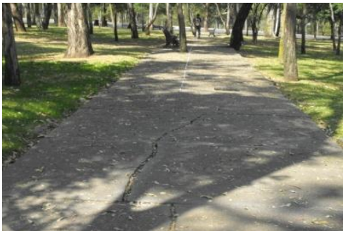
Fotografía 5. Se observa que la loza ésta completamente rota a los costados del camino, también presenta pequeños hundimientos diferenciales de 3cm a 6 cm de profundidad.
