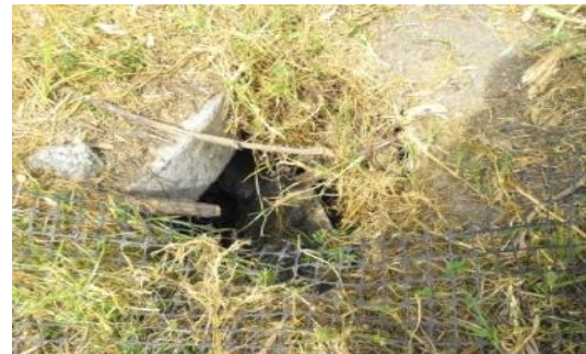
Fotografía 6. Hundimiento en la superficie del terreno junto al él se denota una Oquedad y Hundimiento de una profundidad de 1.20 m, él cual ha sido rellenado de basura y madera
