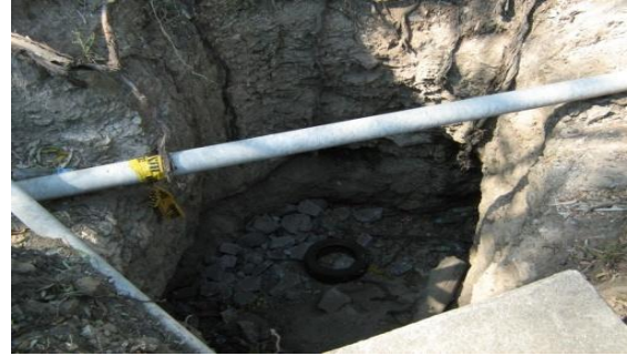
Fotografía 2. Se observa que al fondo del hundimiento existen fragmentos de roca que se han ido cayendo de las paredes debido a lo deleznable de las arcillas y limos que contienen los diferentes estratos de la roca.
