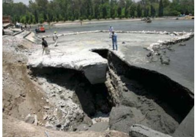
Fotografía 11. Dimensión que alcanzó la fisura por la presión del agua.
