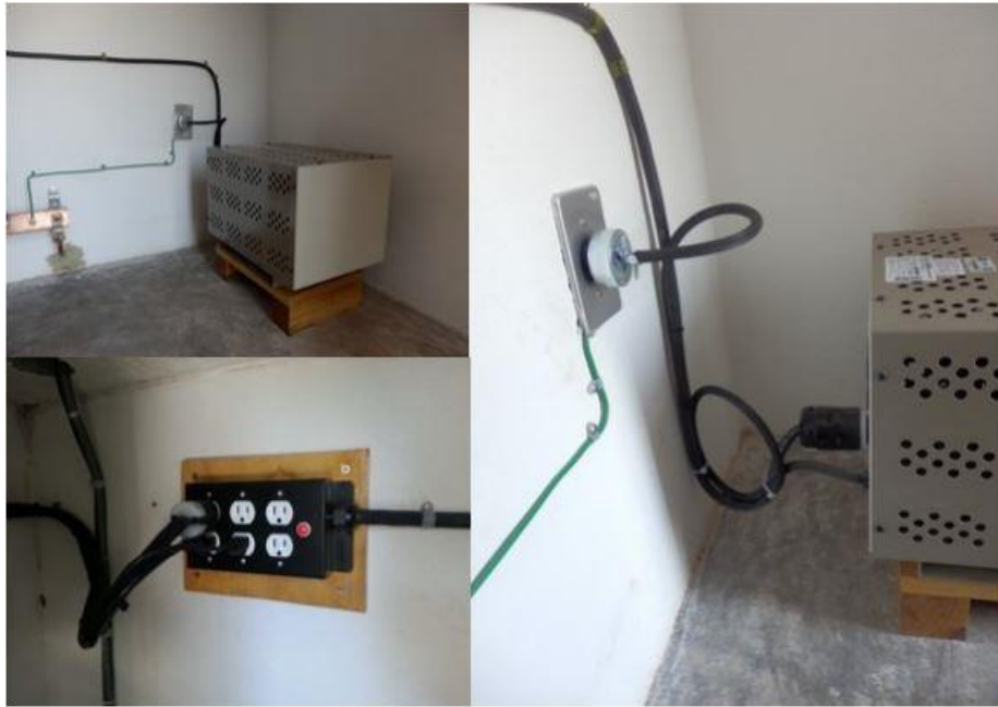
Fig. 3.6 Conexión del regulador y de la caja de distribución. Proporcionada por F. Navarro.
