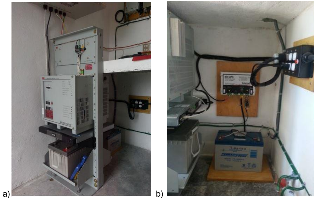
Fig. 3.7 a) Rectificador y el UPS de AC. b) Conexión del UPS de DC. Fotografías proporcionadas por F. Navarro.
