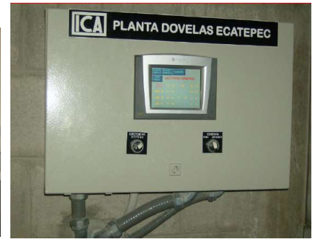
Figura III.114 Tablero de control de temperatura en la cámara de curado
