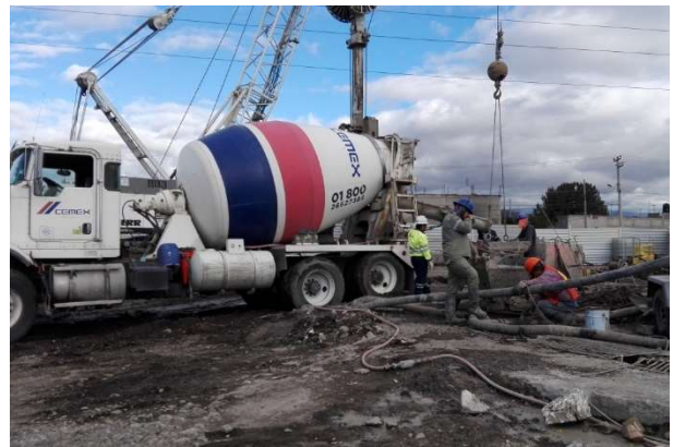
Figura III.51 Colado de Muro Milán con tubería Tremie [Cortesía Ing. Rosalba Trujillo Pech]
