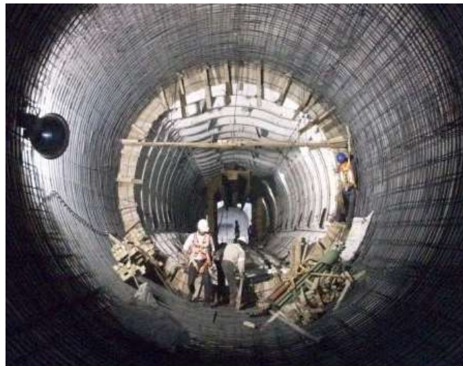
Figura III.155 Encofrado de madera de frente de la cimbra telescópica [Cortesía M.I Mario A. Aguilar Téllez].
