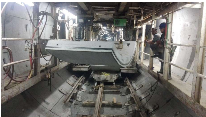
Figura II.9. Grúa (Polipastos de cadenas) para dovelas del escudo EPB (HK-S364), [Propia]
