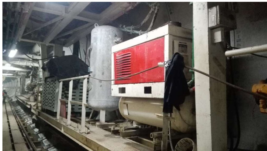
Figura II.13. Sistema de aire comprimido del escudo EPB (HK-S364), [Propia]
