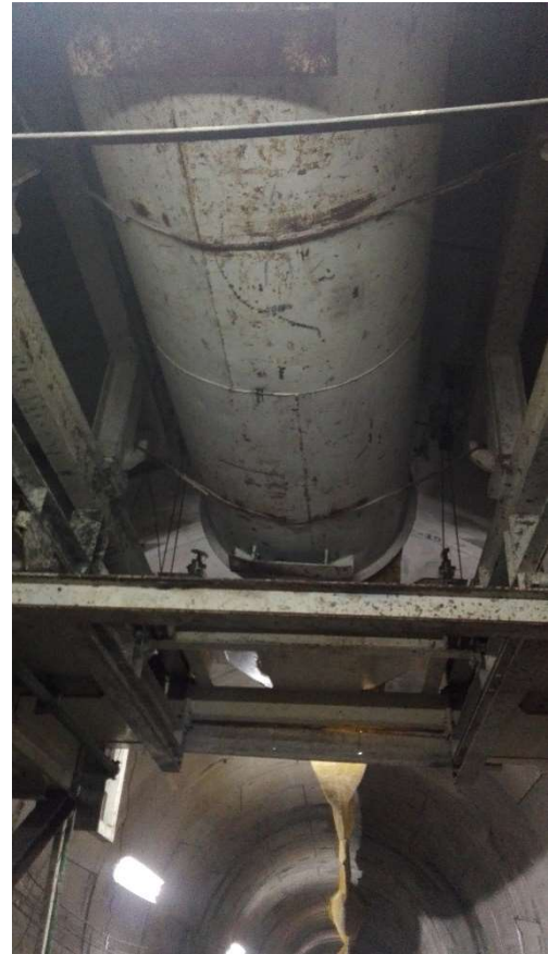
Figura II.15. Cassete de ventilación del escudo EPB (HK-S364), [Propia]
