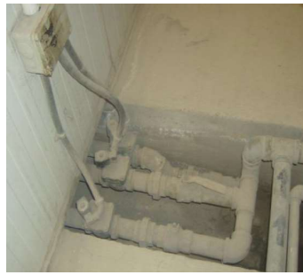
Figura III.113 Válvulas de control de vapor
