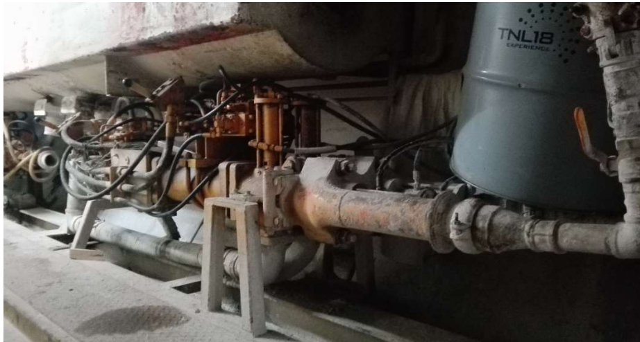
Figura II.11. Bomba de inyección del escudo EPB (HK-S364) bajo el tanque de mortero, [Propia]
