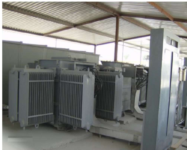
Figura II.47. Subestación de energía eléctrica de la planta de dovelas, [Cortesía ICA]
