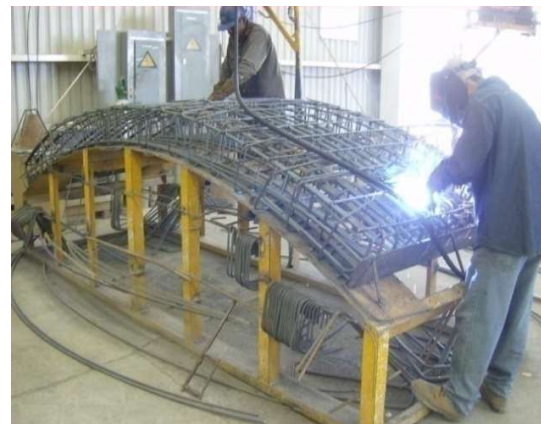
Figura III.99 Habilitado de acero de refuerzo de dovela. [Cortesía Ing. Carlos J. Ilhuicatzí González].
