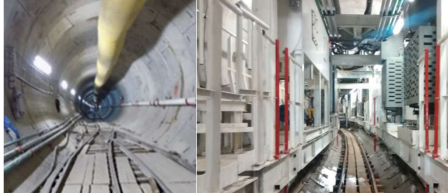
Figura 1.61. Túnel Canal General, Chalco, Estado de México, Estados Unidos Mexicanos. [Cortesía: SUCOCO].
