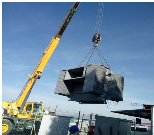
Figura II.7. Subestación eléctrica, ubicada en patio de Lumbraera, [Cortesía Ing. Daniel Lara].
