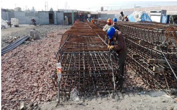
Figura III.45 Habilitado de armado de acero de muro Milán [Cortesía Ing. Rosalba Trujillo Pech]
