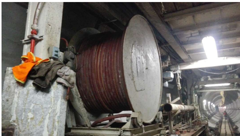
Figura II.18. Carretes de extensión de las líneas eléctricas del escudo EPB (HK-S364), [Propia]
