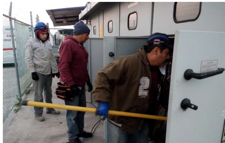
Figura II.8. Subestación eléctrica, ubicada en patio de Lumbraera, [Cortesía Ing. Jairo Trujillo].
