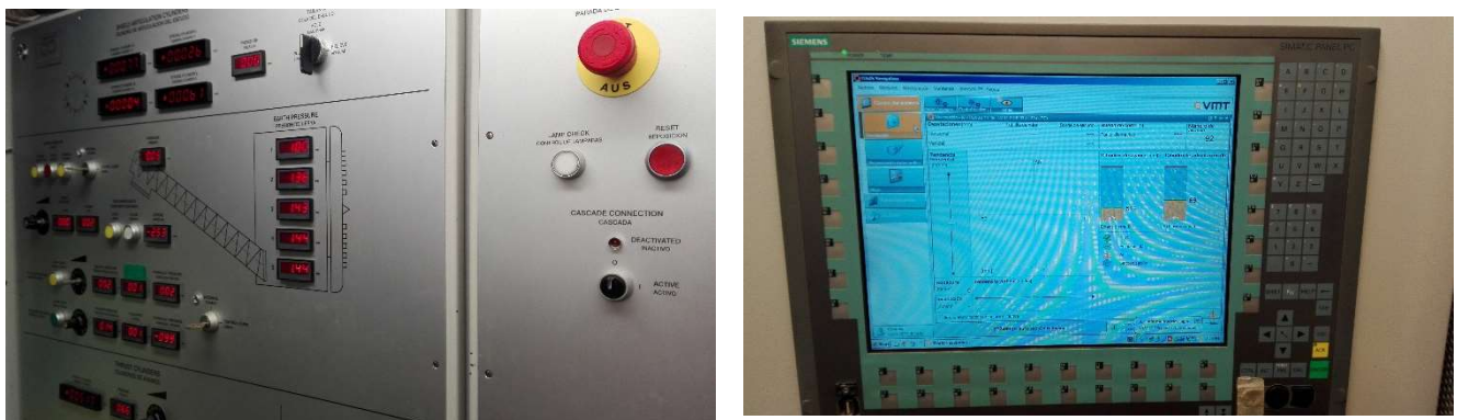
Figura II.22. Interior de la cabina de control del escudo EPB (HK-S364), [Propia]
