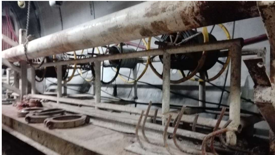
Figura II.17. Carretes de extensión de las líneas eléctricas del escudo EPB (HK-S364), [Propia]
