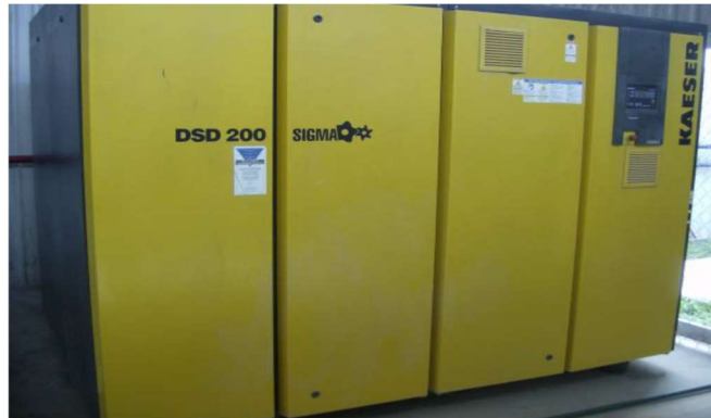
Figura II.35. Compresor de aire marca KAESER, modelo DSD 200, [Cortesía ICA]
