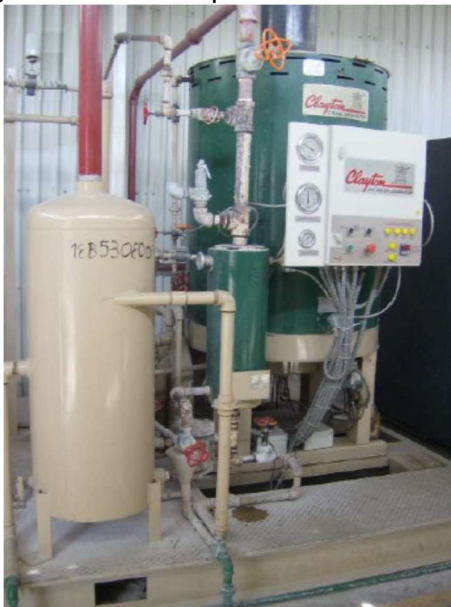
Figura II.41. Caldera o Vaporizador Clayton, mod. E100. [Cortesía ICA]
