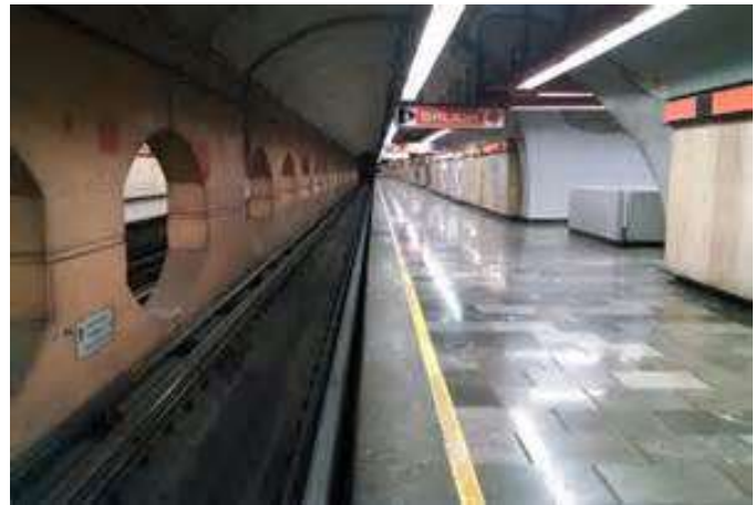
Figura 1.48. Túnel de la estación Aquiles Serdán de la línea 7 del STCM. Ref. [82].
