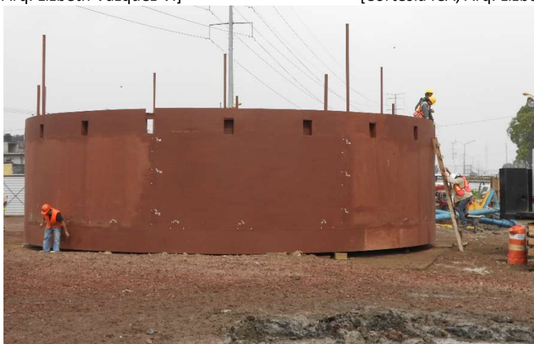
Figura II.85. Tanque de flotación, [Cortesía ICA, Arq. Lizbeth Vazquez V.]
