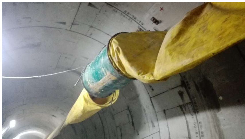
Figura II.16. Ventilador intermedio ubicado en el Cad. 12+400 (tramo L2-L0), [Propia]
