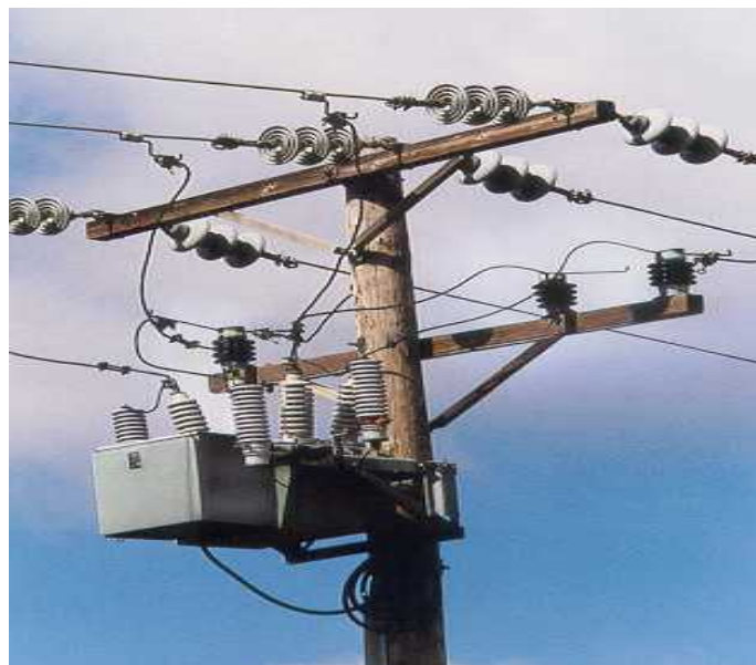
Figura 1.20. Restaurador instalado en línea aérea de 23 [kV], 2007.
