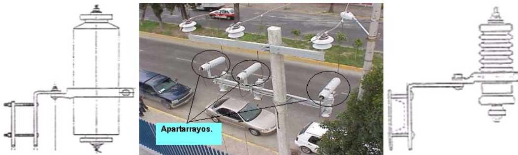
Figura 1.21. Esquemas y fotografía de apartarrayos instalados en líneas de 23 [kV].
