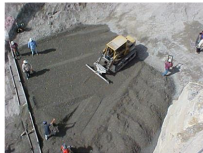
fig. 2.17 POSY TRACK SOBRE ORUGAS CON ZAPATAS DE NEOPRENO EXTENDIENDO CCR EN LA CORTINA
