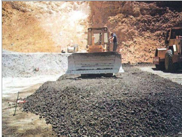
Fig.2.1 CONCRETO DE CONSISTENCIA SECA, REVENIMIENTO CERO
