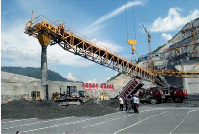
FIG. 3.17 PARA EL CCR ES POSIBLE EMPLEAR TANTO PARA EL TRANSPORTE, COLOCACIÓN Y COMPACTACIÓN DEL CONCRETO LOS MISMOS MÉTODOS USADOS HABITUALMENTE PARA EL MOVIMIENTO DE TIERRAS, ESTO SUMADO A MÉTODOS PATENTES DE FABRICACIÓN CONLLEVA A OBTENER ALTOS RENDIMIENTOS DE CONSTRUCCIÓN.
