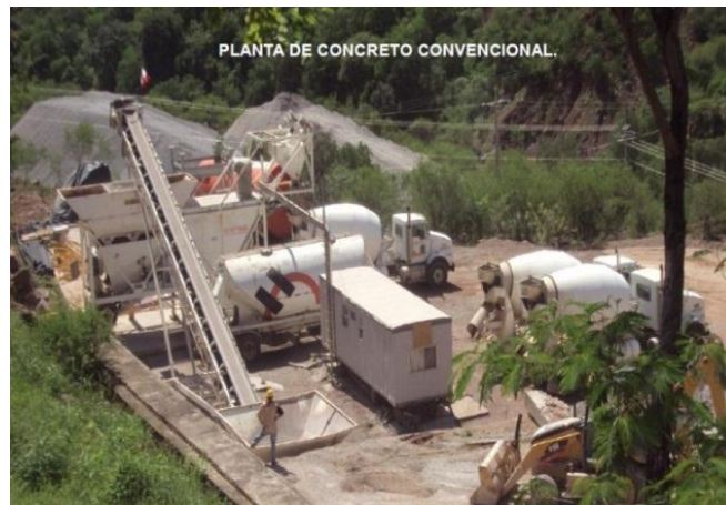
FIG. 5.27 PLANTA DE CONCRETO CONVENCIONAL
