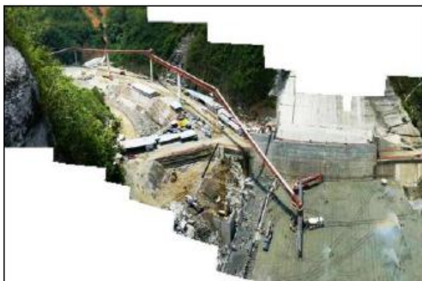
FIG. 4.22 BANDA ROTEC DE APROXIMADAMENTE 600 M DE LONGITUD, 90 CM DE ANCHO Y UNA CAPACIDAD NOMINAL DE TRANSPORTE DE 400 M 3 /HR. ESTÁ COMPUESTA POR SECTORES DE BANDA, TOLVAS, ELEMENTOS DE TRANSFERENCIA Y SOPORTES METÁLICOS SENCILLOS O TELESCÓPICOS. EN EL ÁREA DE LA PRESA SE DISPUSO DE UN DISTRIBUIDOR DE CONCRETO SOBRE ORUGAS COMPUESTO POR BANDAS TRANSPORTADORAS TELESCÓPICAS, CON ALCANCE A CASI TODA EL ÁREA DE TRABAJO Y CAPACIDAD DE HASTA 400 M 3 /HR (CRAWLER).
