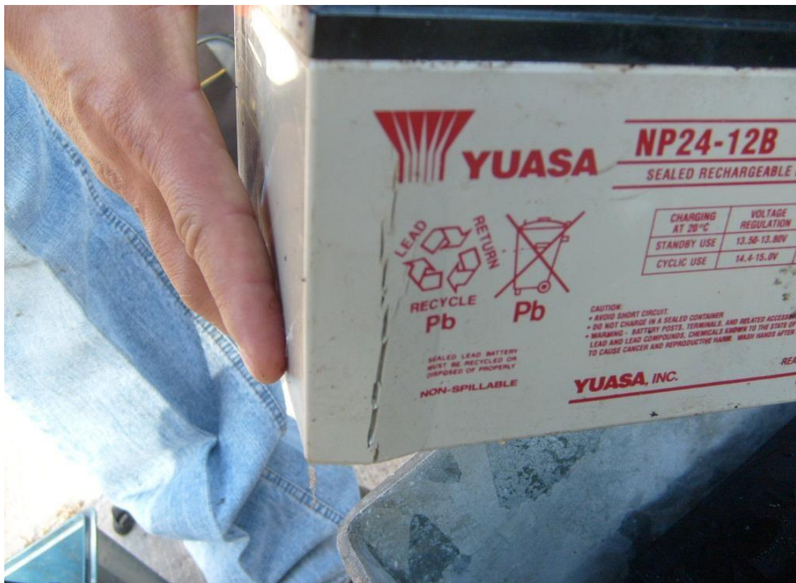
Figura 3.3 Aspecto que muestra el deterioro de las baterías en campo.
