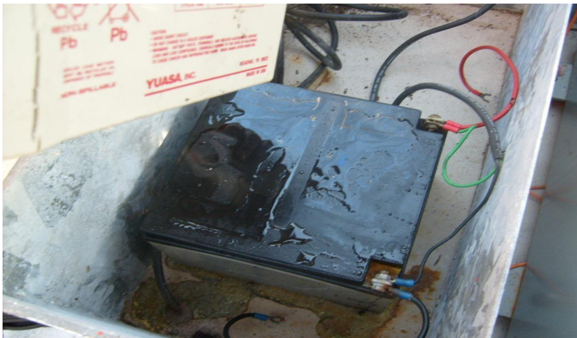
Figura 3.2 Aspectos generales del deterioro de las baterías. Derramamiento del ácido
