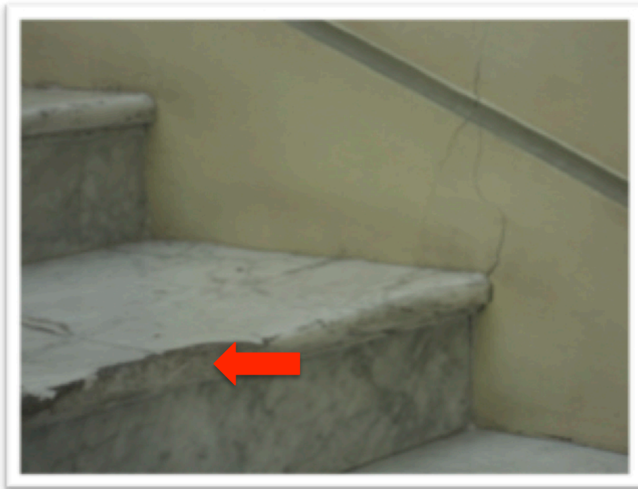
Fig. 13 Pérdida de sección en escalera.
