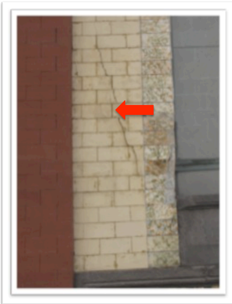
Fig. 16 Grieta en diagonal, se localiza en fachada.
