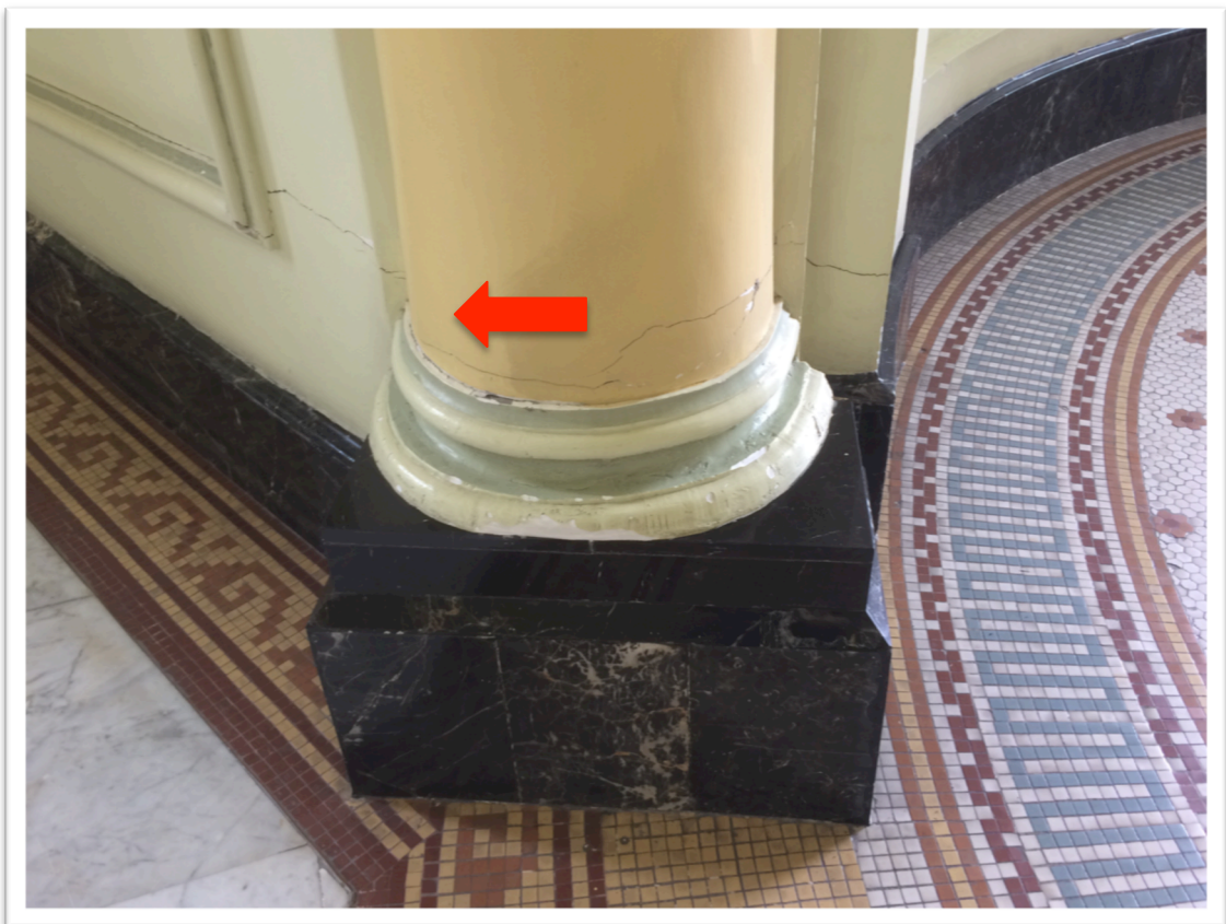
Fig. 10 Grietas en la parte baja de las columnas del vestíbulo principal.
