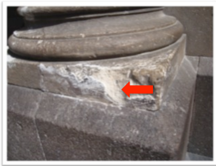
Fig. 17 Pérdida de sección en columna de la fachada
