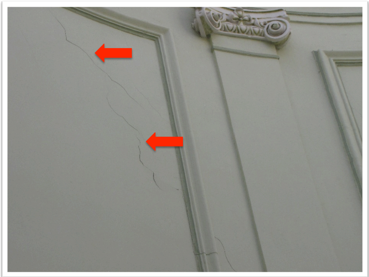
Fig. 11 Grietas con trayectoria diagonal en muros de escalera.
