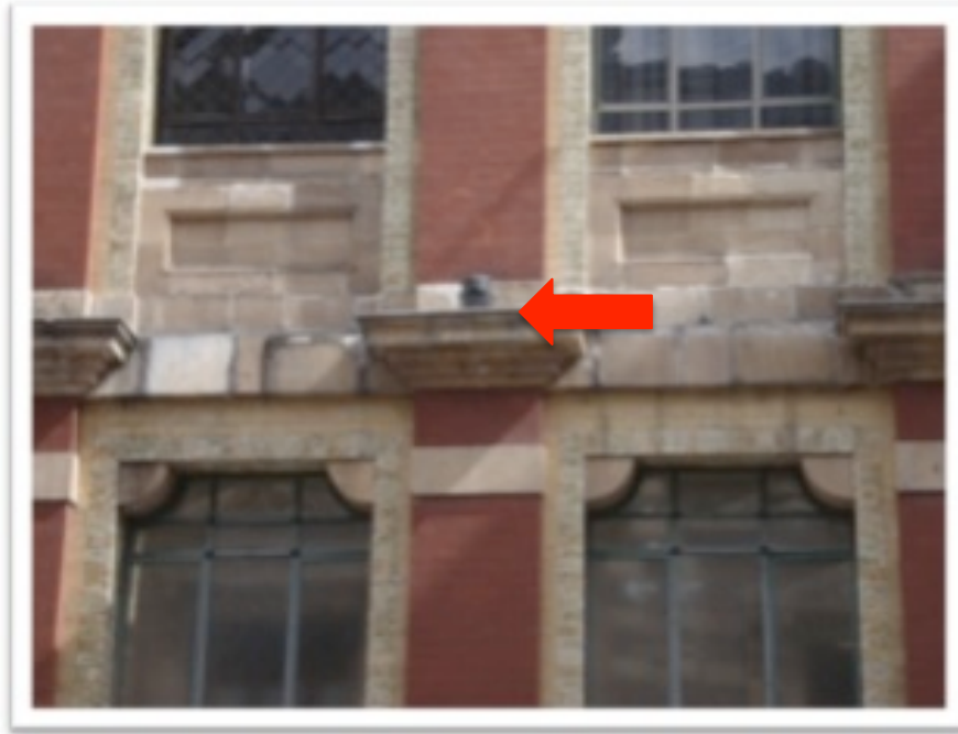
Fig. 16 Esgurrimientos y erosión de cantera.
