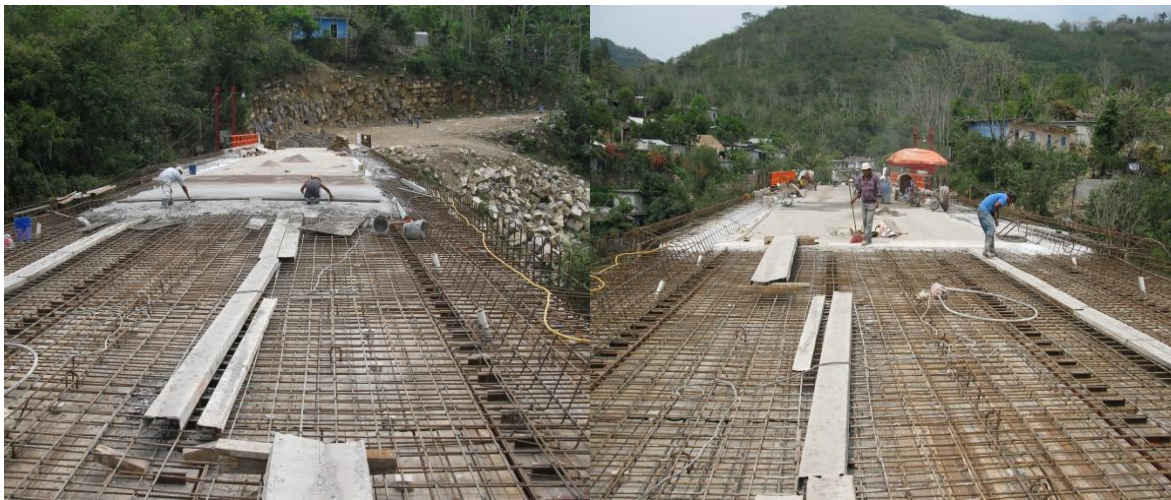
Figura 5.52 Armado de losa y banquetas listo para realizar el colado, asimismo se pueden visualizar los conectores a cortante y los drenes de pvc (ambos extremos de la losa central).
