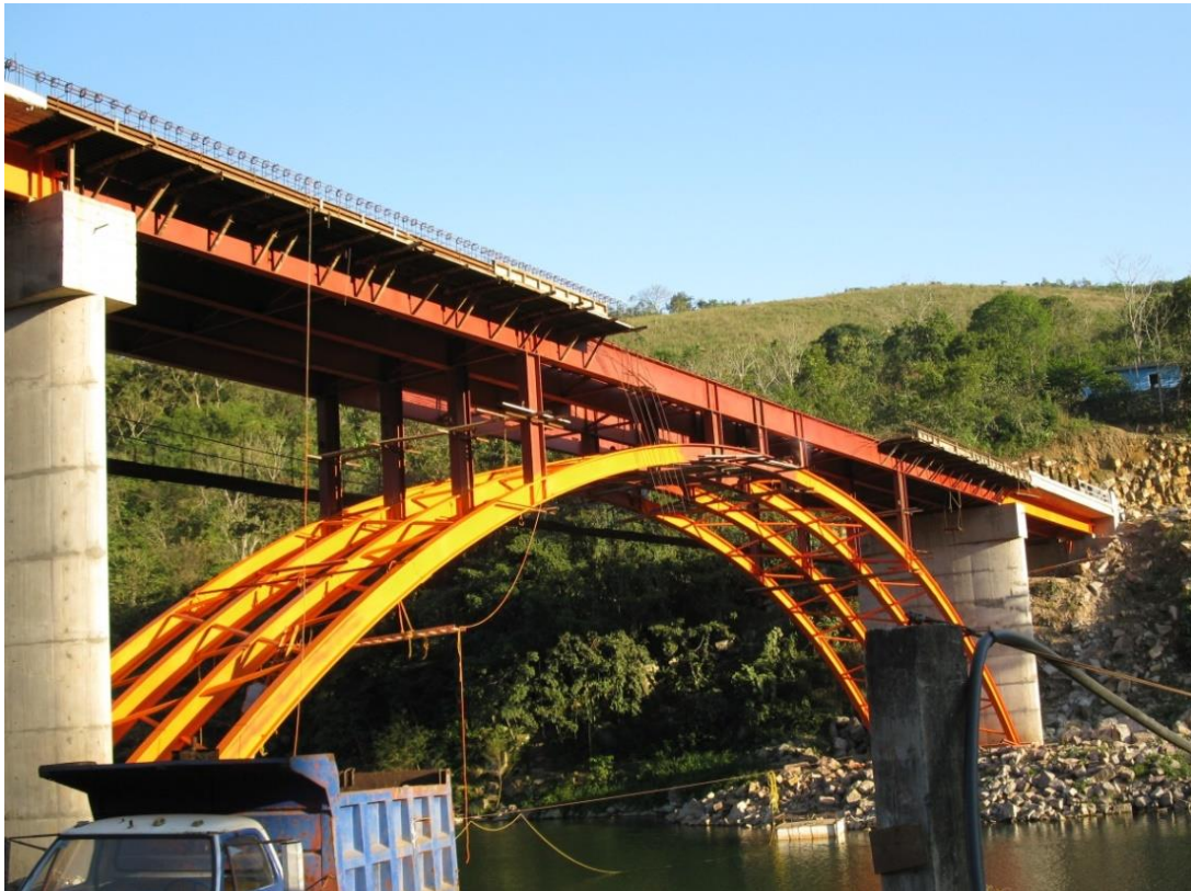
Figura 5.48 Ensamblado de atizadores del arco y colocación de cimbra de madera en el tramo central del puente.
