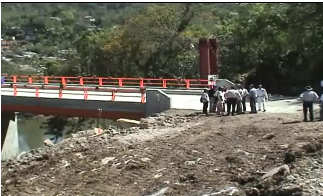
Figura 5.62 Salida del puente (margen izquierda) donde se observan el camino de terracería existente y el aproche construido siguiendo el alineamiento horizontal del puente.
