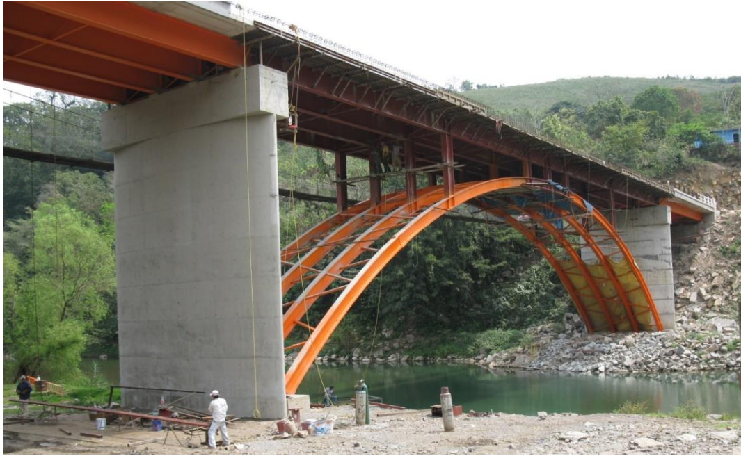
Figura 5.49 Cimbra de madera en el tramo central del puente lista para construir la losa de concreto.
