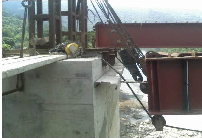
Figura 5.38 Par de travesaños llegando al punto de apoyo de la pila No. 2, se observan los cables guía debajo de las mismas.
