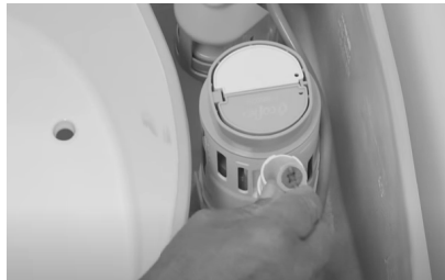
Figura 36. Interior del tanque con el dispositivo para la doble descarga del inodoro (Home Depot, 2022).
