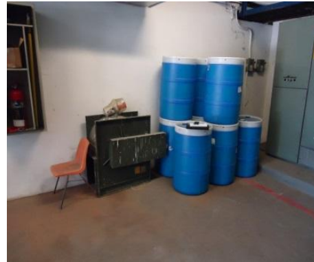
Objetos Almacenados Dentro de la Subestación.
