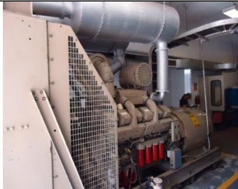
Planta de Emergencia.
