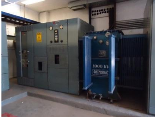
Transformador M.T. 1000 [kVA].
