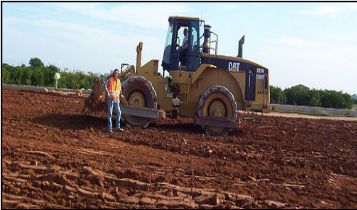
FOTOGRAFÍA III.1 “DISGREGADO DE MATERIALES”
