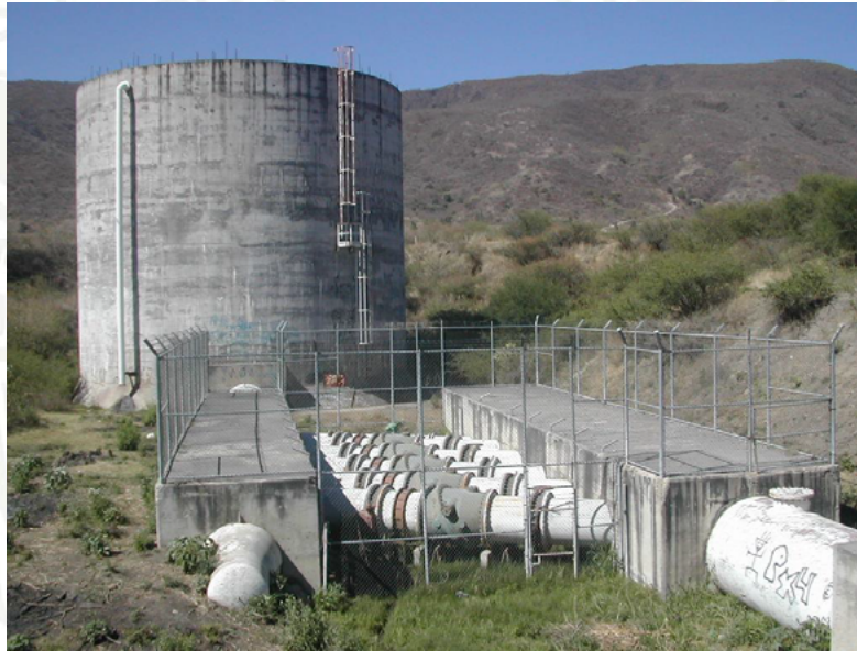
FIGURA 5.34 TANQUE UNIDIRECCIONAL DE 18 M DE DIÁMETRO Y 18 M DE ALTURA
