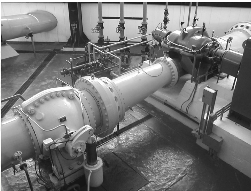
FIGURA 4.34 VÁLVULA ESFÉRICA DE LA PLANTA DE BOMBEO DEL SISTEMA CUTZAMALA
