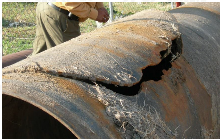
FIGURA 5.3 FALLA EN UN CONDUCTO DEBIDA A LA SOBREPRESIÓN
