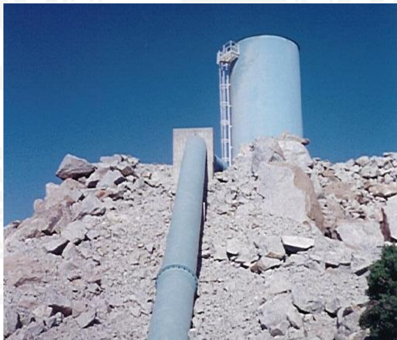
FIGURA 5.32 ASPECTO DE UNA TORRE DE OSCILACIÓN DE 7 m DE DIÁMETRO Y 40 m DE ALTURA
