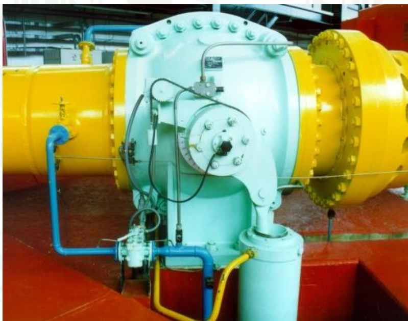
FIGURA 5.17 VÁLVULA DE CONTROL DE FLUJO EN LA DESCARGA DE UNA BOMBA
