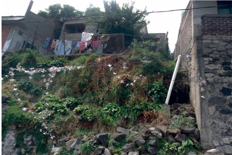
Figura 4.16. Fotografía G de la Zona 1, vivienda que comienza a tener pérdida de su basamento debido a la remoción de los materiales del talud en el que se encuentra.
