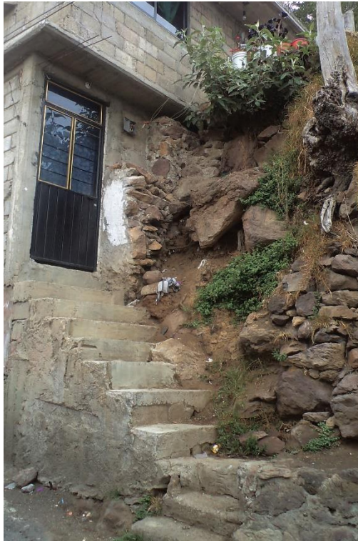
Figura 4.25. Fotografía B de la Zona 2, bloques expuestos con peligro de caída. Se localizan en los cortes realizados sobre la ladera debido a las construcciones. Es importante notar la ausencia de obras para mitigar el peligro.
