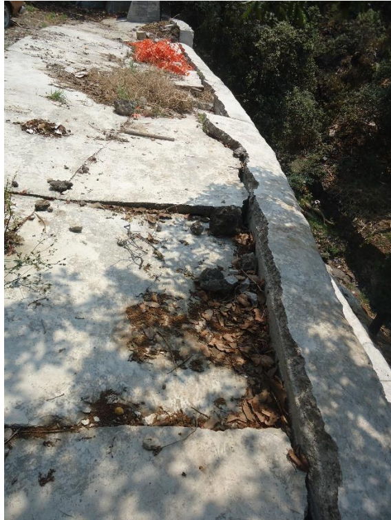
Figura 5.70. Fotografía C de la Zona 8, vista de la parte superior del muro de contención. Se pueden observar fracturas significativas que obedecen un desplazamiento a favor de la pendiente.
