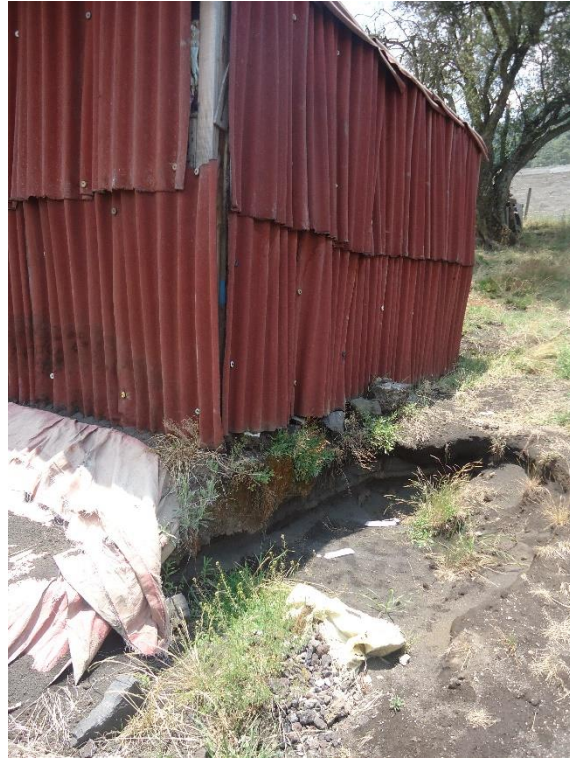
Figura 4.57. Fotografía D de la Zona 6, ejemplo de la fácil erosión que se presenta en los depósitos de ceniza, la cual ya está comenzando a dejar sin basamento a la vivienda precaria.
