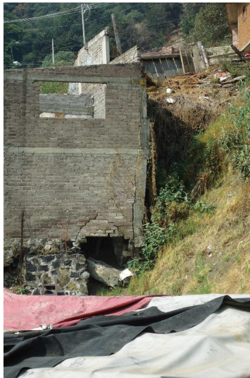
Figura 4.11. Fotografía B de la zona 1, muestra el peligro que representa el movimiento de la ladera y la inestabilidad que genera el fenómeno antrópico al realizar taludes y a su vez se muestra los daños que provoca una ladera que presenta movimiento.
