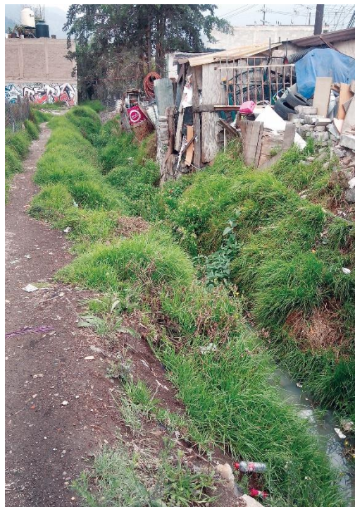
Figura 4.61. Fotografía D de la Zona 7, vivienda desplantada a orillas del río, se nota una ligera inclinación de los materiales que la delimitan.
