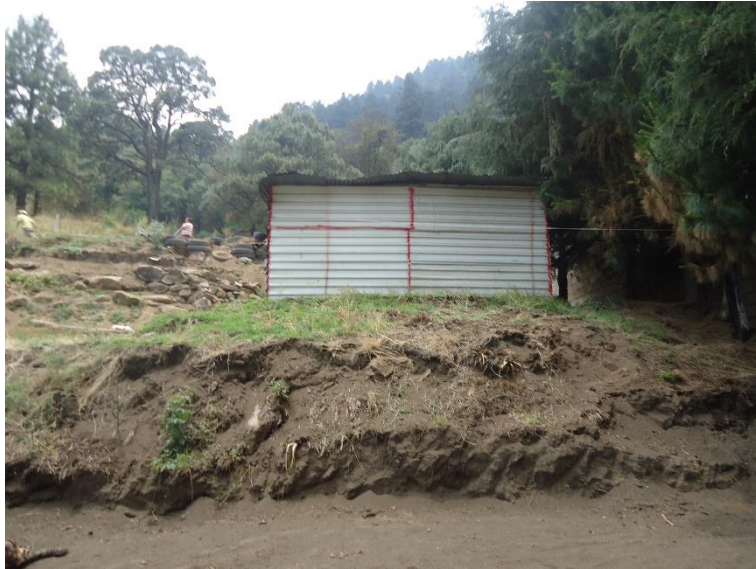
Figura 4.54. Fotografía A de la Zona 6, se muestra el corte de un camino el cual refleja la inestabilidad de la ladera, compuesta de ceniza que presenta deslizamiento y el parte superior las rocas están expuestas para presentar un derrumbe.
