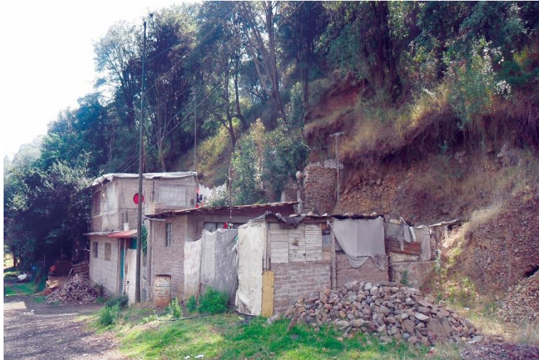
Figura 4.43. Fotografía A de la Zona 4, los taludes producidos por actividad antrópica representan un peligro alto por derrumbe y potencializa la inestabilidad de la ladera para generar un deslizamiento mayor.
