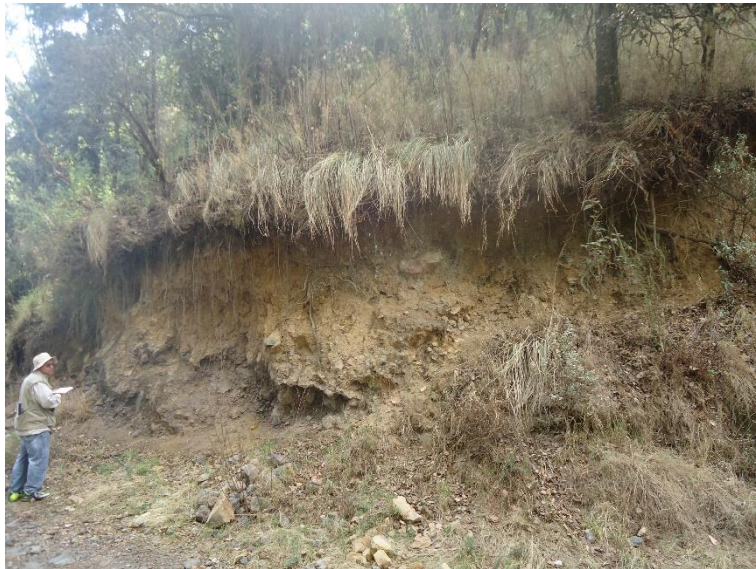
Figura 4.44. Fotografía B de la Zona 4, se observa como ya hay rocas en la parte baja que han caído de partes más altas, lo cual demuestra la inestabilidad del corte.
