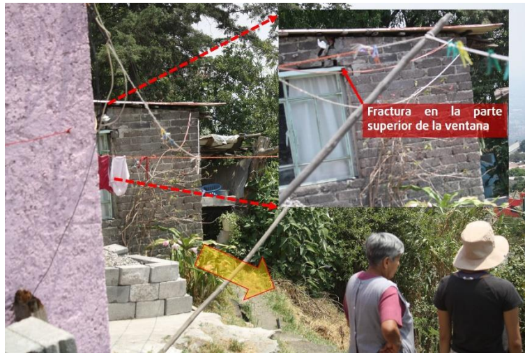
Figura 4.12. Fotografía C de la zona 1, muestra la fractura de la barda sobre la ventana, a pesar de que las condiciones de la construcción no son las idóneas debido a que no tiene castillo en la esquina, evidencia el movimiento de la ladera.
