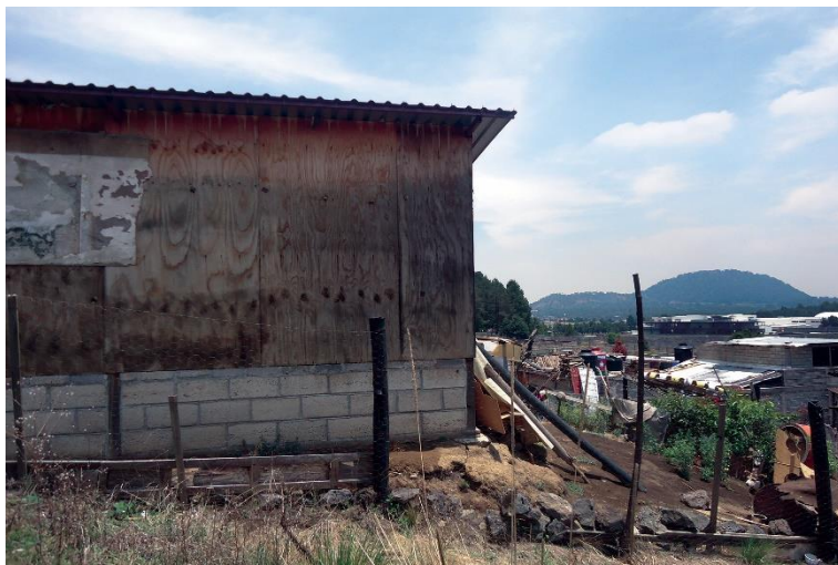
Figura 4.55. Fotografía B de la Zona 6, las viviendas se encuentran construidas sobre cenizas que son fácilmente removidas por el agua y también por el paso de las personas al transitar en la zona, presentando así un peligro por deslizamiento.
