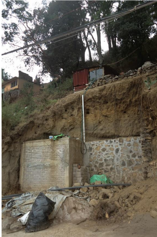
Figura 4.40. Fotografía B de la Zona 3, se aprecia el corte en la ladera y los depósitos compuestos por suelo y bloques de distintos tamaños que representan un peligro alto por derrumbe para la construcción que se encuentra en la parte baja de la fotografía.
