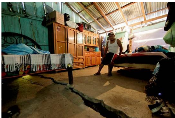
Figura 2.2. La fotografía muestra la grieta en una vivienda que se encuentra en una ladera y evidencia el movimiento de la misma.
