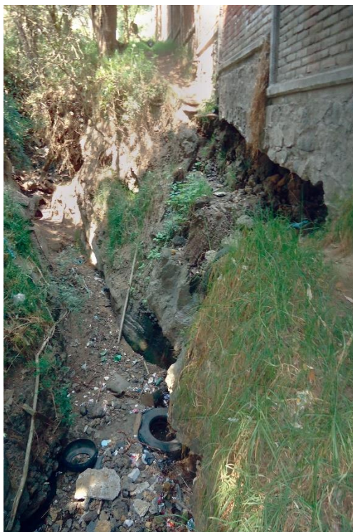
Figura 4.17. Fotografía H de la Zona 1, barda que delimita a la secundaria 151. A un costado de la barda se encuentra un canal donde en temporada de lluvias fluye una corriente que erosiona el suelo.
