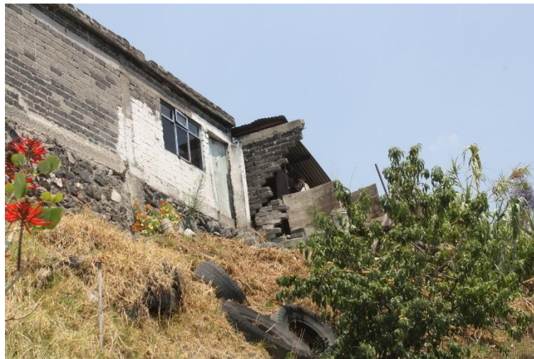
Figura 4.13. Fotografía D de la zona 1, se puede ver el colapso de una barda la cual perdió el suelo donde se apoyaba y cedió al movimiento de la ladera.
