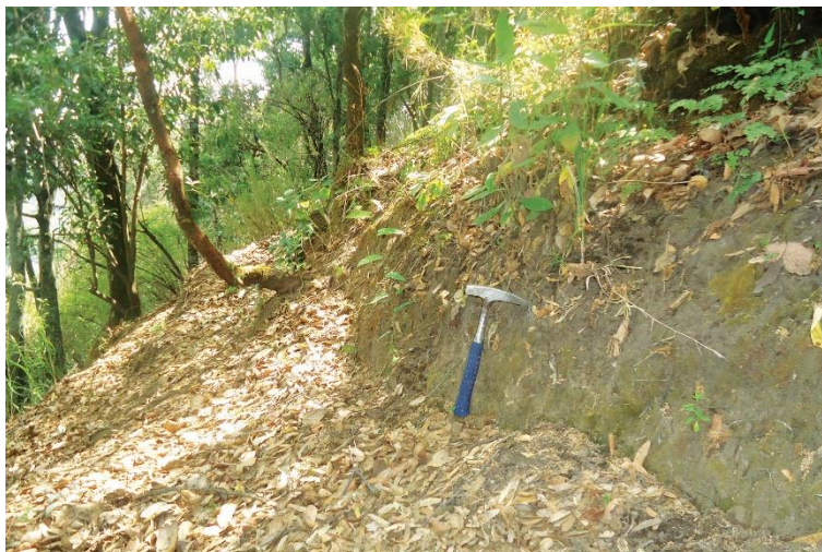
Figura 4.45. Fotografía C de la Zona 4, los desplazamientos verticales que se presentan en la ladera y que tienen presencia de musgo indican que el terreno se ha estabilizado y que el movimiento de reptación ha dejado de ocurrir.
