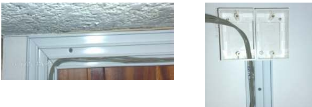
Figura 76. Cableado en el área de ventas.
