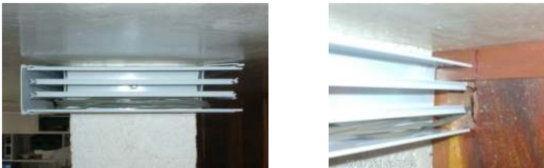
Figura 75. Cableado en el área de almacén.
