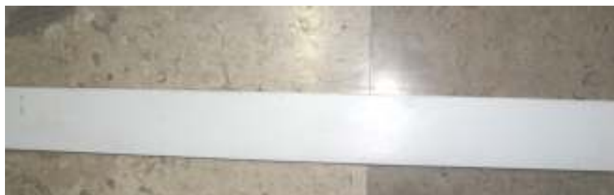
Figura 45. Canaleta en la dirección general.
