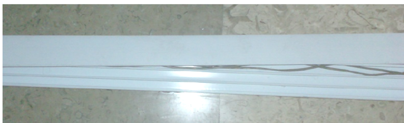
Figura 77. Cableado del área de la dirección general.
