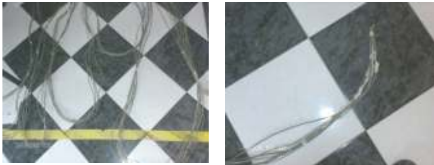
Figura 71. Cable telefónico unido mediante cinta adhesiva.
