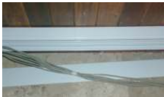
Figura 72. Cable telefónico en la canaleta.
