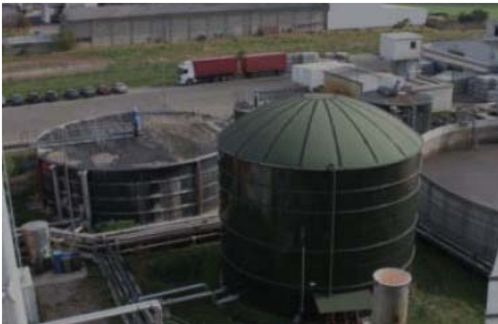
Figura 2.16 Digestor industrial en España
