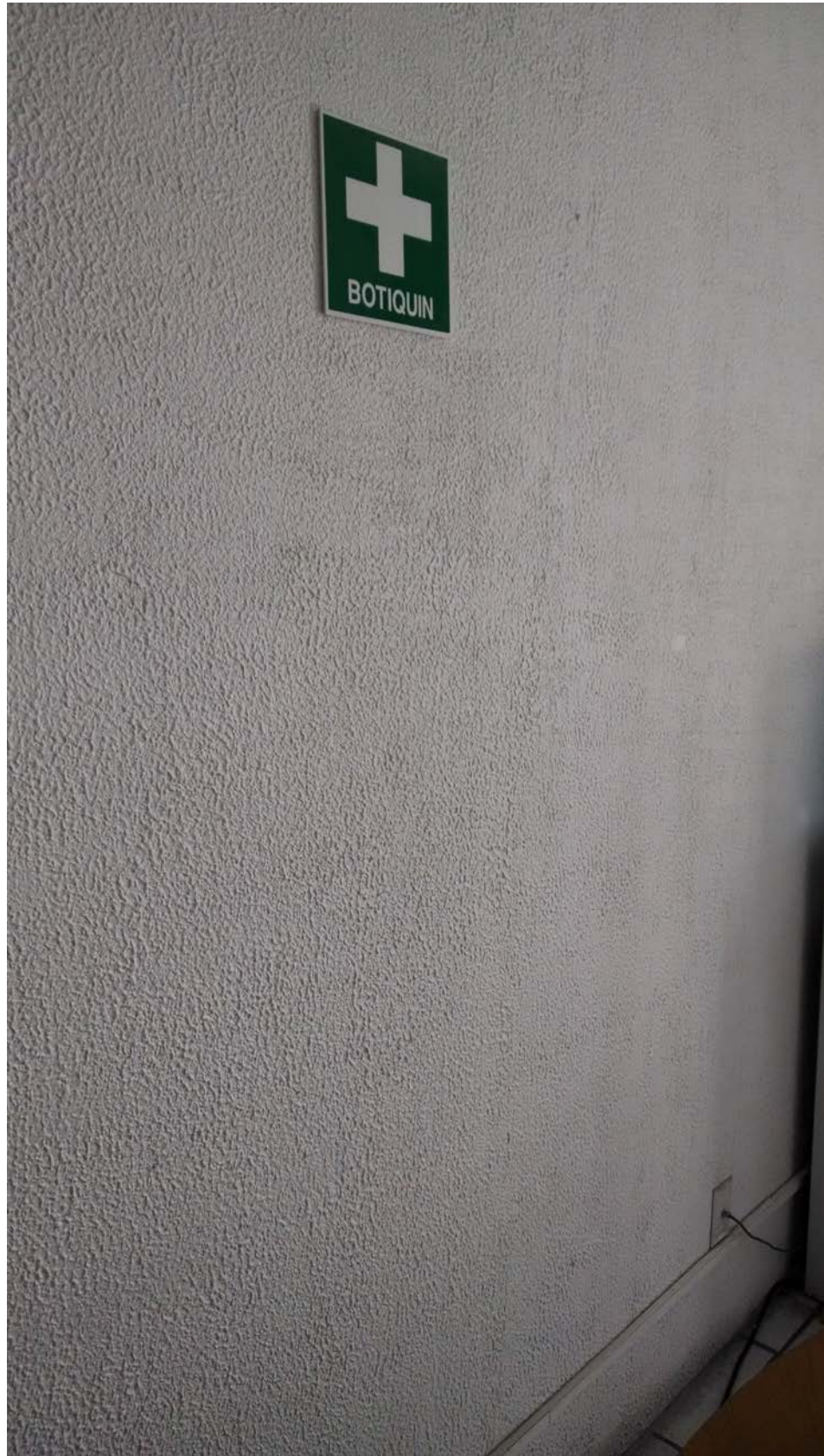
Foto 2. Sala de profesores tercer piso edificio T, no hay botiquín
