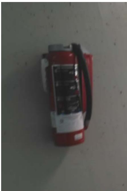
Foto. Extinguidor planta baja edificio U, sin válvula
