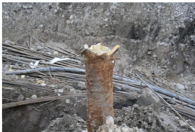
Figura 4.51. Pozo de inspección en condiciones desfavorables.
