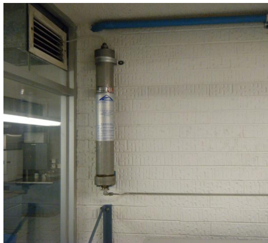
Figura 4. Destructor de Ozono
