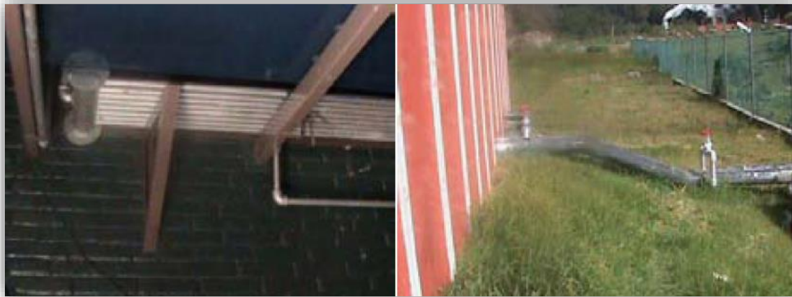
Fig. 1.20.- Intercambiadores de calor en la estufa de secado de madera y tubería de calefacción geotérmica en los Azufres Michoacán (Alejandro, 2009).
