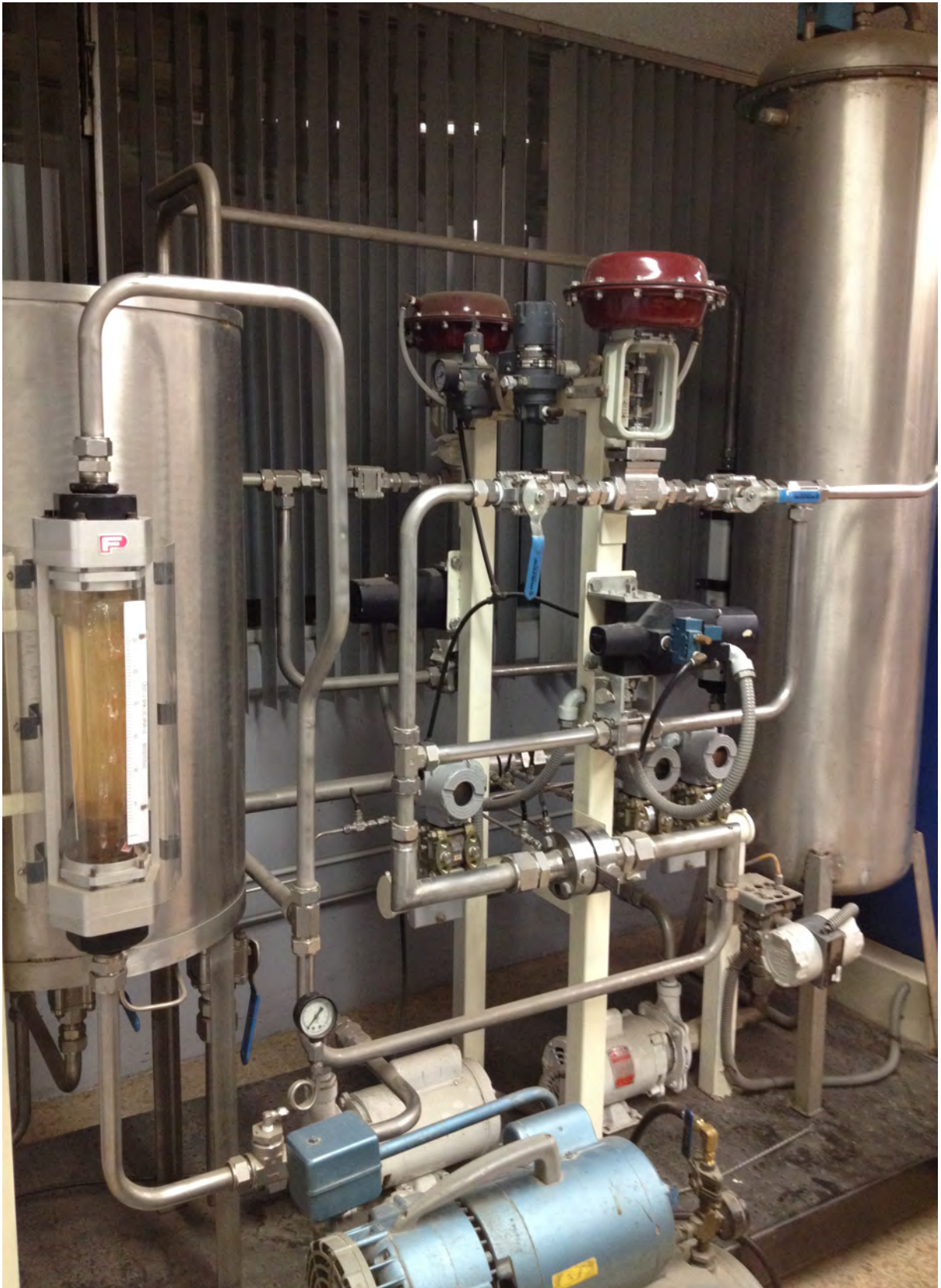
Figura 3.2: Foto de planta piloto. A la izquierda, el depósito de carga abierto; a la derecha, el depósito de carga cerrado; al centro, la instrumentación: válvulas, bombas, transmisores y tubería; y en la parte inferior, se encuentra el compresor para alimentar las válvulas. Foto en Laboratorio de Control y Robótica cortesía de la Facultad de Ingeniería, UNAM.
