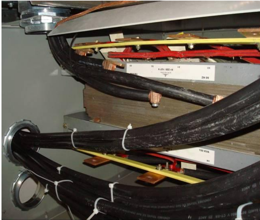
Figura 4.112. Muestra de alimentadores generales que se derivan del transformador reductor de tensión (Baselis, 2010)
