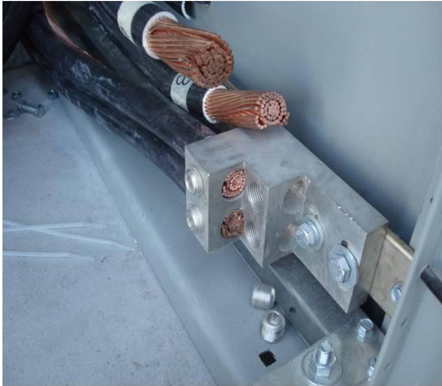
Figura 4.130. Muestra la colocación del cableado en todos sus hilos para establecer la referencia del neutro del sistema (Baselis, 2010)
