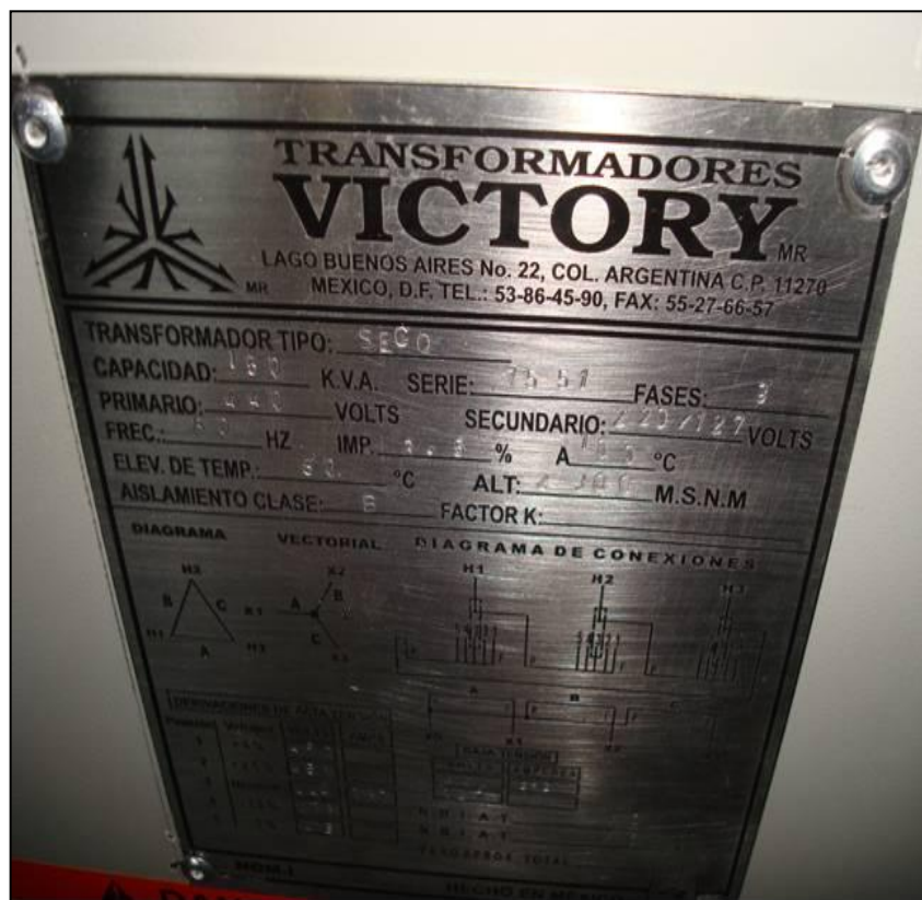
Figura 4.32. Placa de datos característicos del transformador reductor del sistema en baja tensión Victory de 150 kVA (Baselis, 2010)
