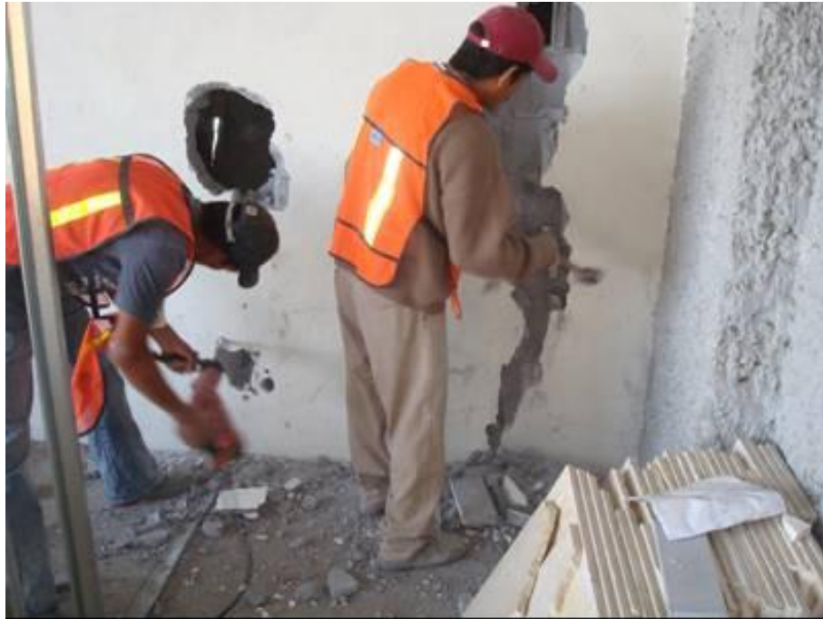
Figura 4.74. Demolición de muros, para el paso de bandas nuevas y para instalaciones del sistema (Baselis, 2010)
