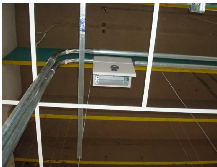
Figura 4.143. Muestra otra forma en que se realizan las canalizaciones eléctricas para alimentación de los equipos UPS y los detectores tipo “eXaminer” (Baselis, 2010)
