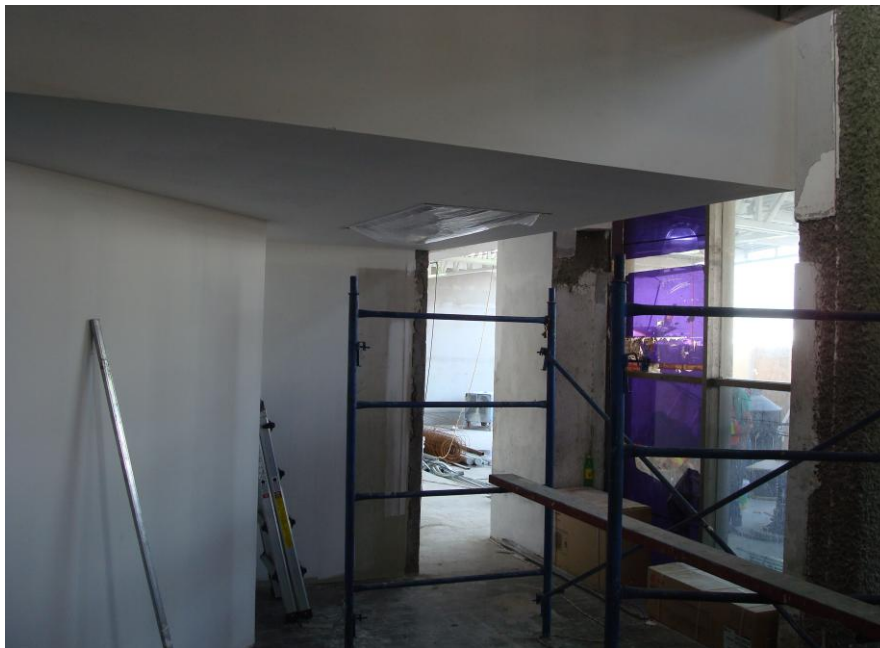
Figura 4.89. Terminado de diferentes acabados en muros de tablaroca, con pintura y resanes (Baselis, 2010)
