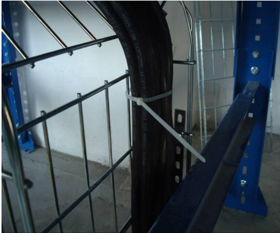
Figura 4.163. Cableado sobre la canalización tipo charola y sus trayectorias debajo de cada módulo conformante del sistema de bandas transportadoras (Baselis, 2010)
