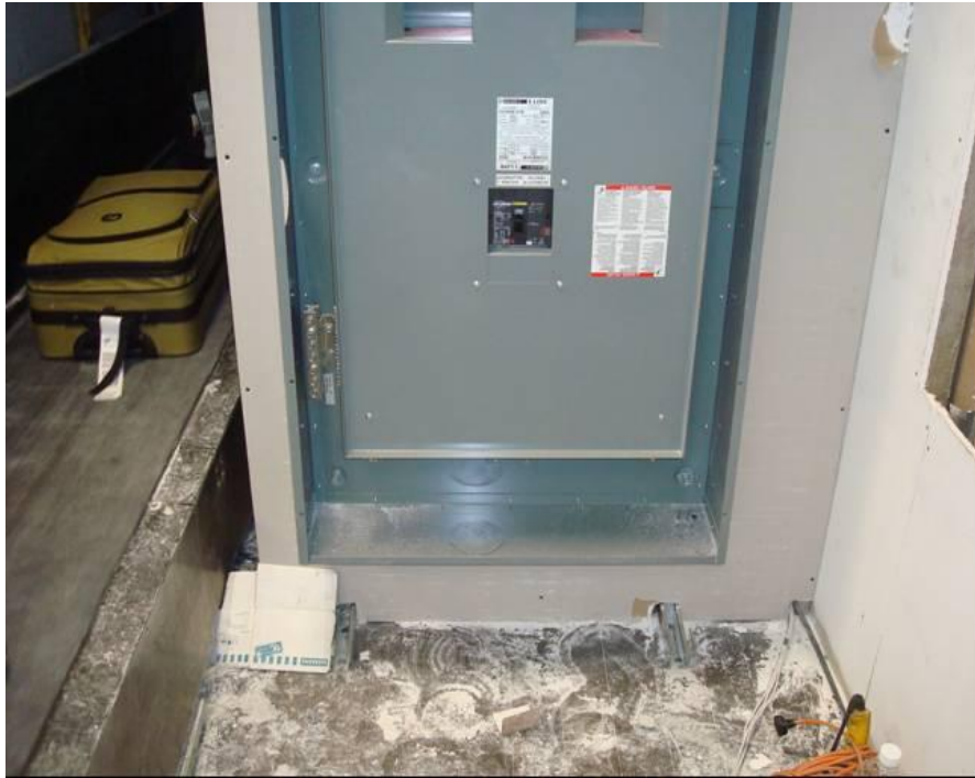
Figura 4.114. Muestra de la instalación del tablero “eXaminer” para los equipos detectores y su forma de soportarse (Baselis, 2010)
