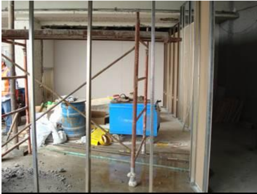
Figura 4.82. Colocación de muros de tablaroca para definición de las áreas comunes y las de bandas transportadoras (Baselis, 2010)
