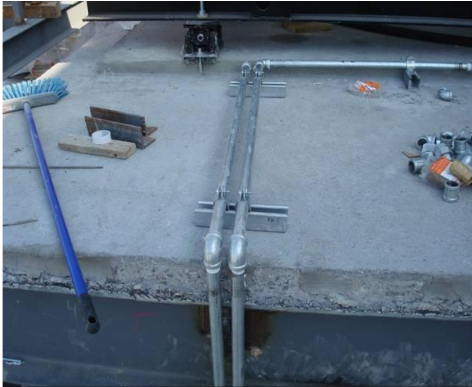
Figura 4.140. Muestra el sistema de líneas de llenado o de retorno del diésel para la planta de emergencia (Baselis, 2010)
