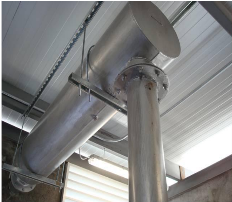
Figura 4.139. Muestra el sistema de escape de la planta de emergencia y el silenciador de la misma (Baselis, 2010)
