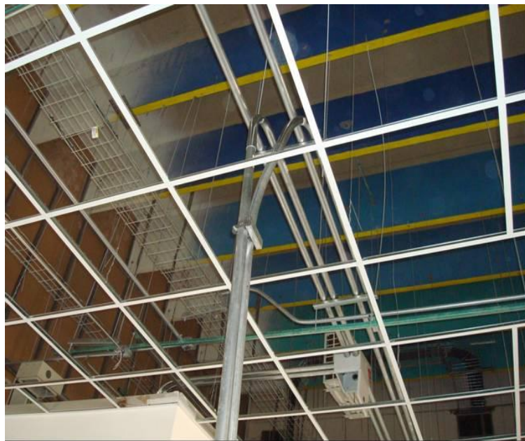
Figura 4.142. Muestra la forma en que se realizan las canalizaciones eléctricas para alimentación de los equipos UPS y los detectores tipo “eXaminer” (Baselis, 2010)
