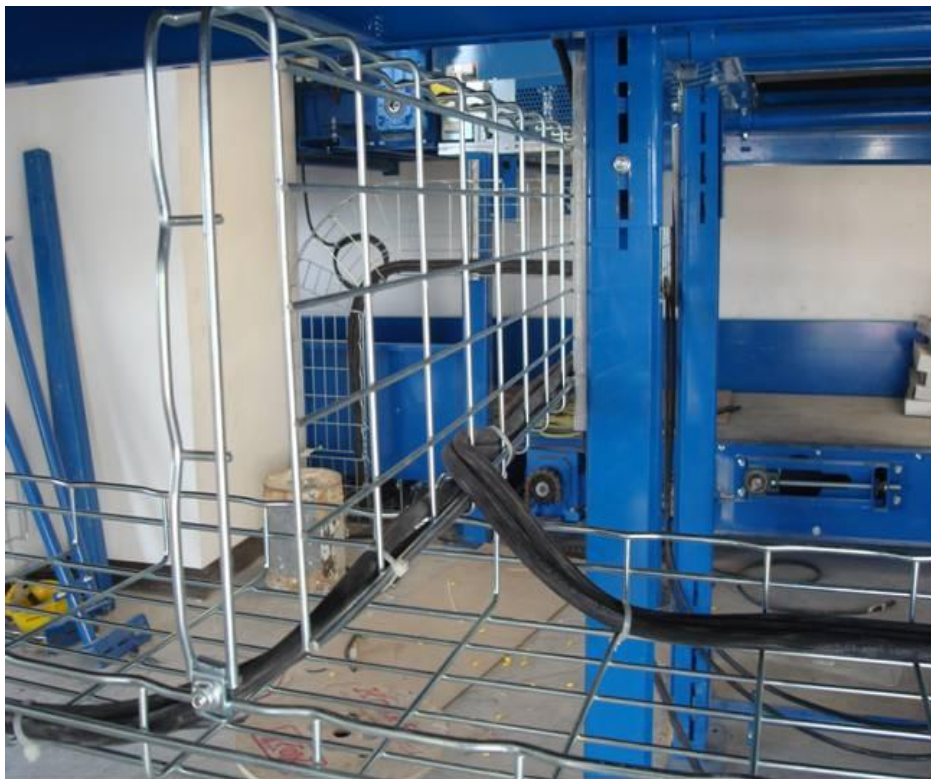
Figura 4.164. Otra forma de cableado sobre la canalización tipo charola y sus trayectorias debajo de cada módulo conformante del sistema de bandas transportadoras (Baselis, 2010)
