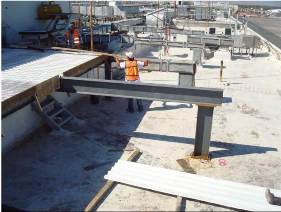
Figura 4.48. Proceso de realización de estructura para expansión de la misma, donde se ubicará la subestación del sistema de bandas transportadoras (Baselis, 2010)
