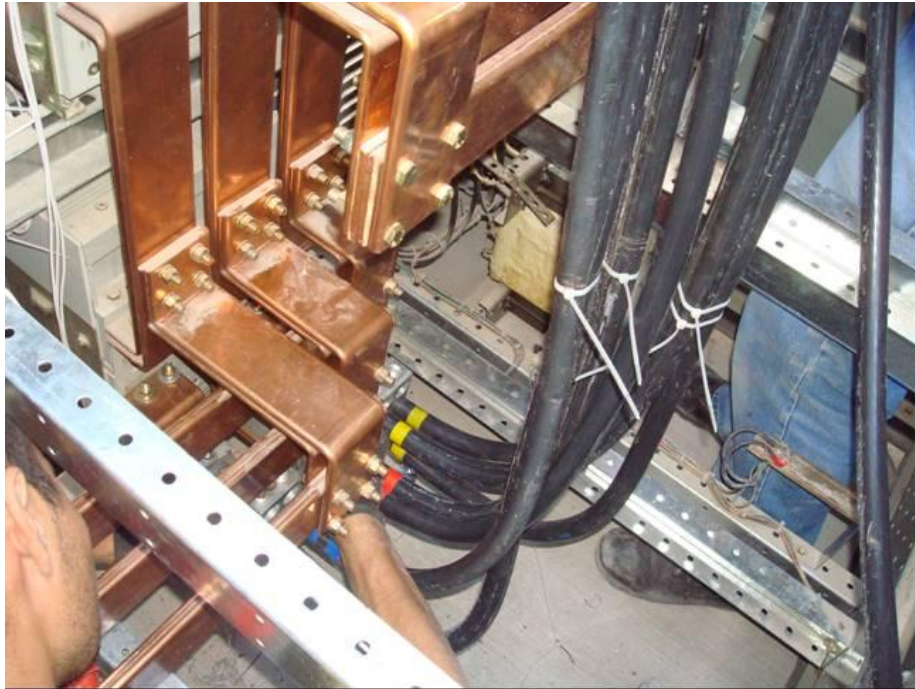
Figura 4.138. Muestra otra forma del arreglo interior del tablero de transferencia y su forma de cableado general en las barras hacia los interruptores (Baselis, 2010)
