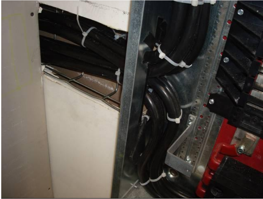
Figura 4.110. Alimentadores generales que se requieren para el tablero “P2” (Baselis, 2010)
