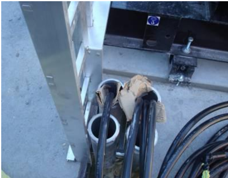
Figura 4.59. Muestra los pasos entre piso y loza a base de tubería conduit por la parte superior de la azotea (Baselis, 2010)
