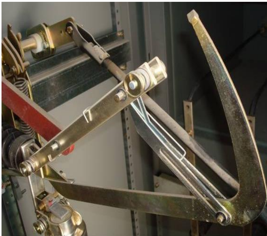
Figura 4.135. Muestra un ejemplo del tipo de cuchilla en media tensión para la subestación (Baselis, 2010)
