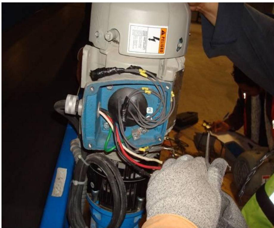
Figura 4.168. Conexión de la alimentación eléctrica del motor de engranes y banda para cada módulo conformante del sistema de bandas transportadoras (Baselis, 2010)
