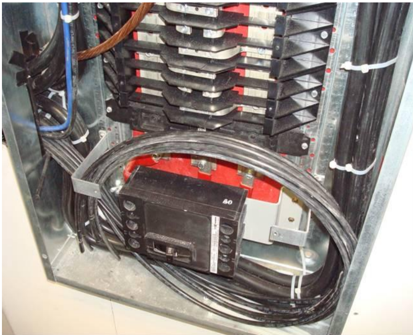
Figura 4.117. Muestra cercana de la instalación del tablero de servicios generales tipo “P2” (Baselis, 2010)
