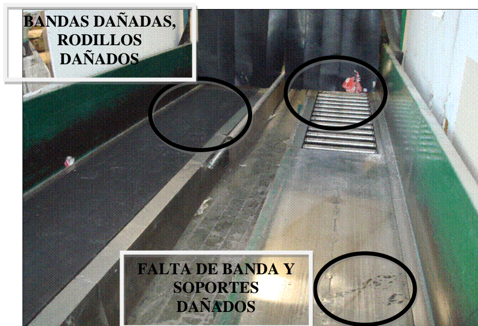
Figura 3.3. Otra vista del estado de la banda transportadora indicando la falta de banda de tela, diversos daños en su trayectoria y limpieza general (AMTY, 2010)
