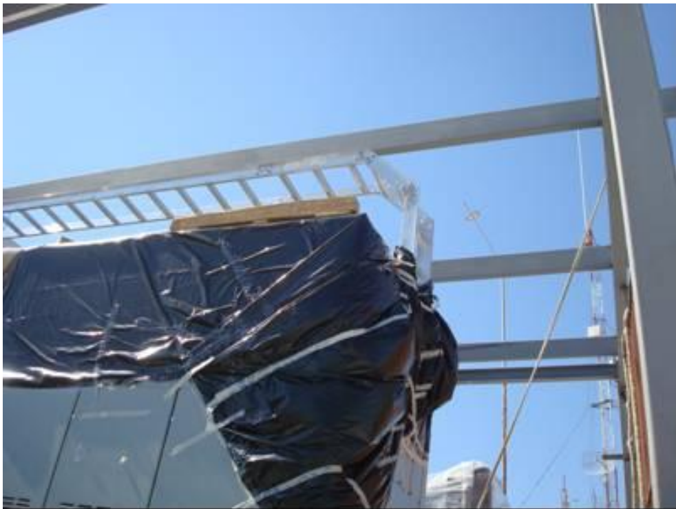
Figura 4.57. Muestra la trayectoria de la charola de aluminio para alimentaciones al gabinete del transformador (Baselis, 2010)
