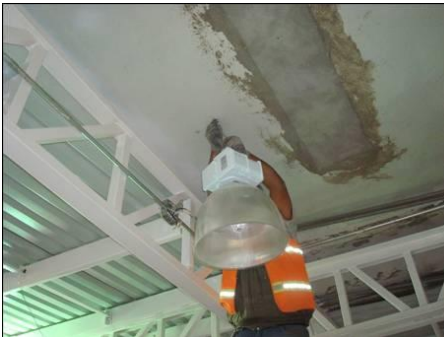
Figura 4.99. Colocación de luminarios de aditivos metálicos, para el área de la estructura exterior de las bandas transportadoras (Baselis, 2010)
