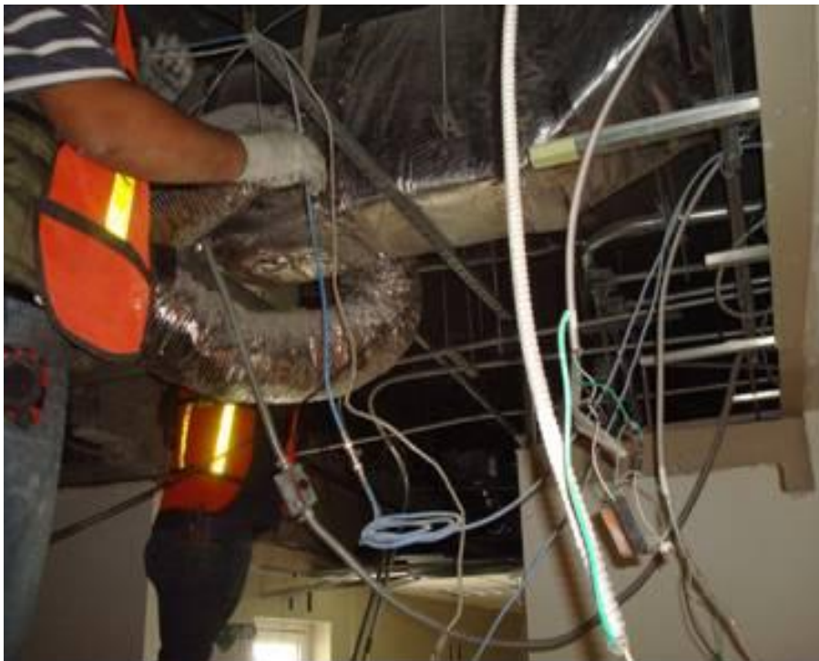
Figura 4.73. Desmantelamiento de instalaciones existentes de energía, de sistemas y de aire acondicionado (ductos y rejillas) (Baselis, 2010)
