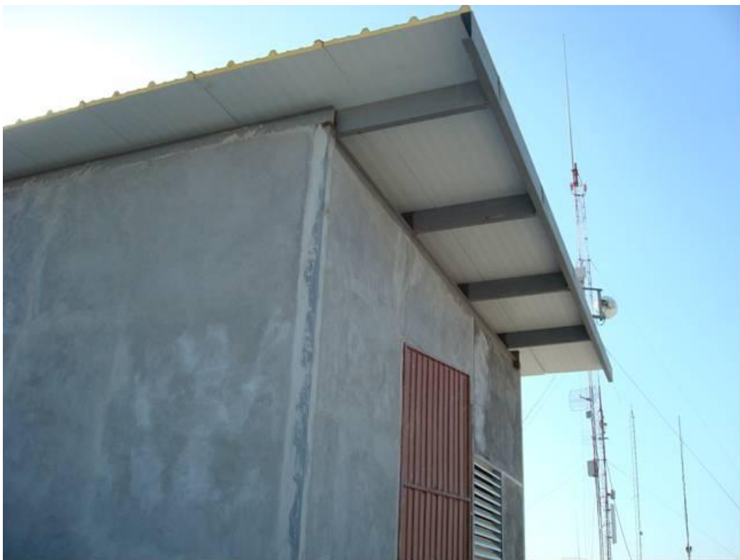
Figura 4.53. Una vez terminado la colocación de equipos, se procede a cerrar mediante el durock para los muros y el techo de lámina (Baselis, 2010)
