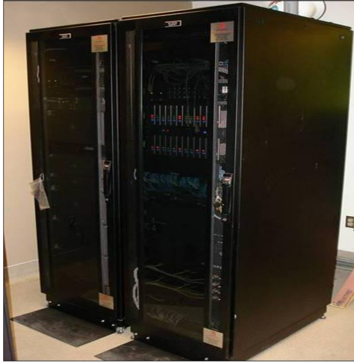
Figura 2.21. Rack de servicios para datos de la zona 2 (Baselis, 2010)
