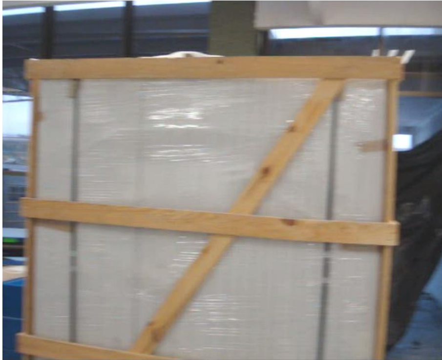
Figura 4.156. Acomodo de gabinetes de los tableros de control “PC” de las bandas transportadoras en las zonas de remodelación (Baselis, 2010)
