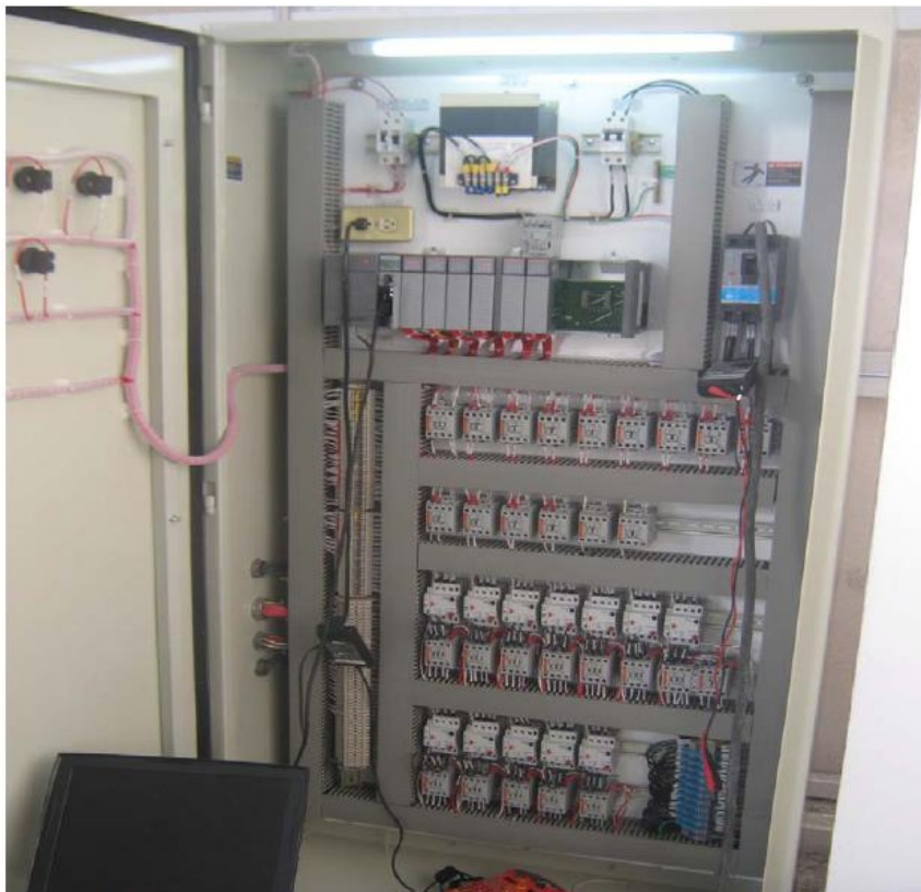
Figura 4.174. Vista de un tablero “PC” con su correspondiente programación mediante software de Siemens (Baselis, 2010)
