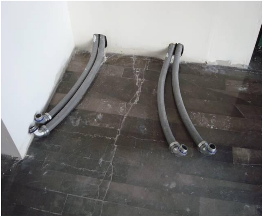
Figura 4.144. Muestra las canalizaciones eléctricas para alimentación de los equipos UPS para respaldo de los detectores tipo “eXaminer” (Baselis, 2010)
