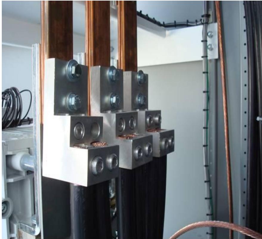
Figura 4.128. Muestra la colocación del cableado en todos sus hilos para alimentación de interruptores en la subestación y transferencia (Baselis, 2010)
