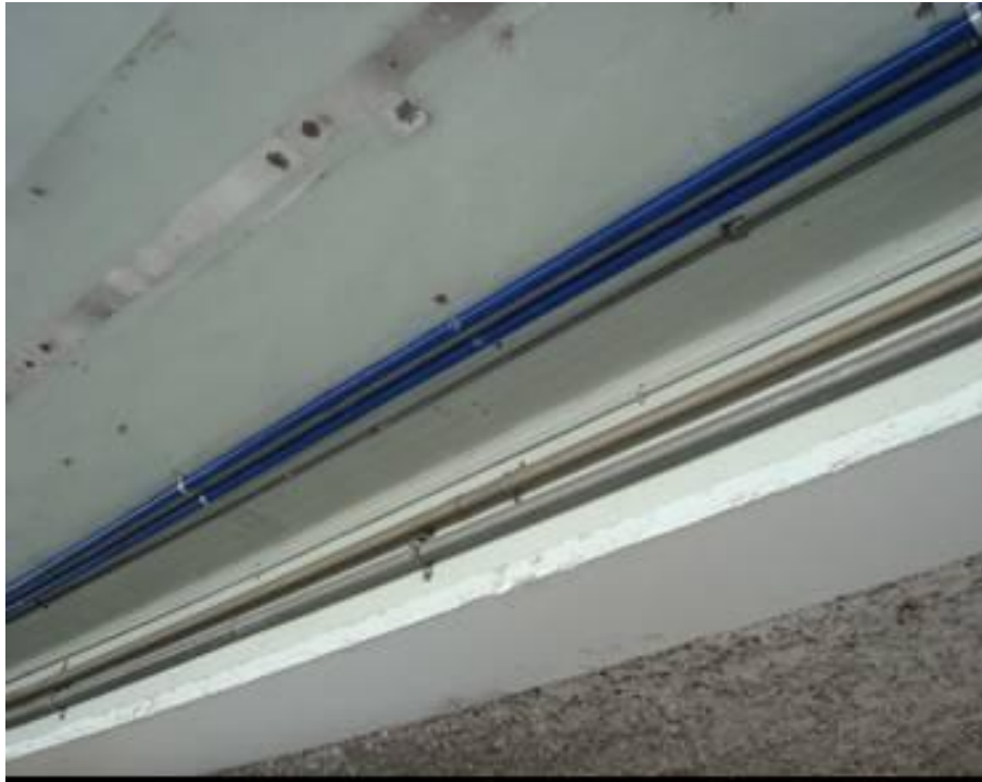
Figura 4.76. Canalizaciones existentes para instalaciones exteriores de la terminal A (Baselis, 2010)
