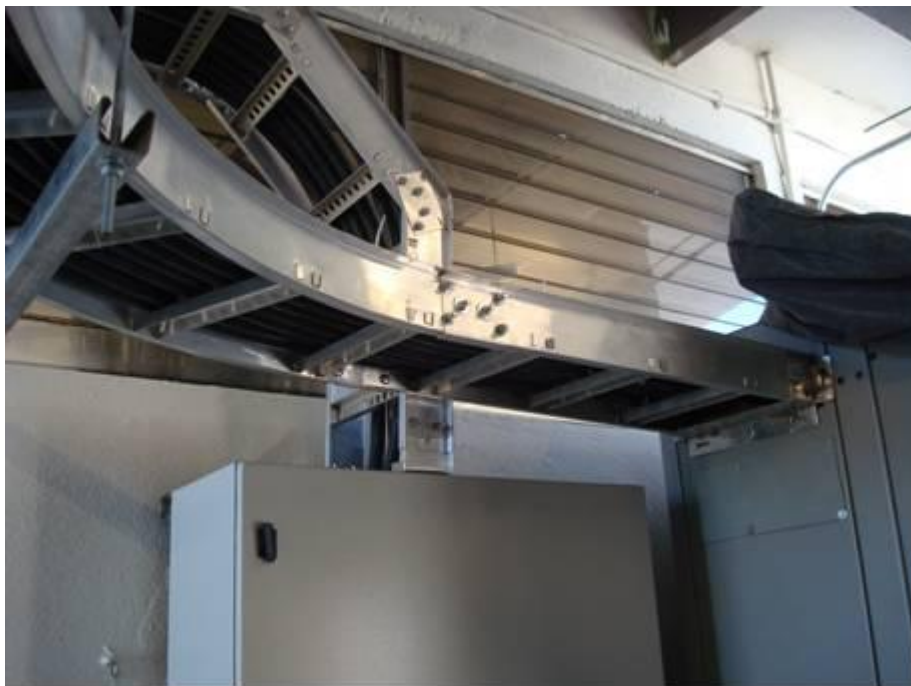
Figura 4.66. Arreglo de cableado para las dos charolas que llegan al tablero de transferencia (la de atrás viene de la subestación y la frontal viene de la planta de emergencia) (Baselis, 2010)
