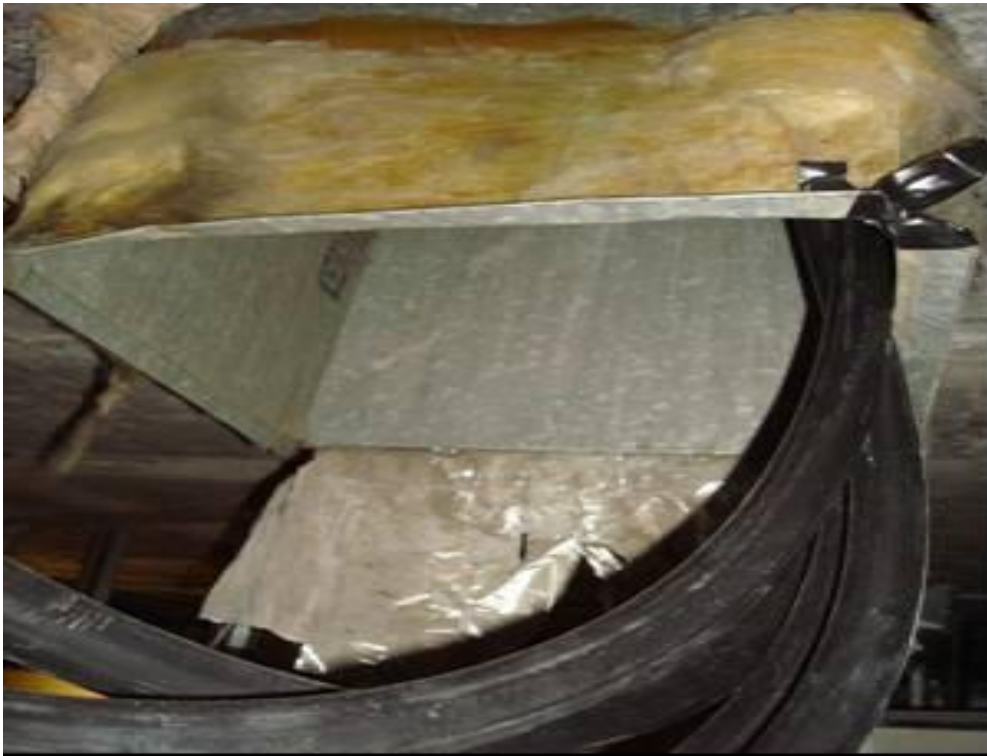
Figura 4.60. Muestra los pasos entre piso y loza a base de hueco dejado por un registro de lámina por la parte inferior de la azotea (Baselis, 2010)
