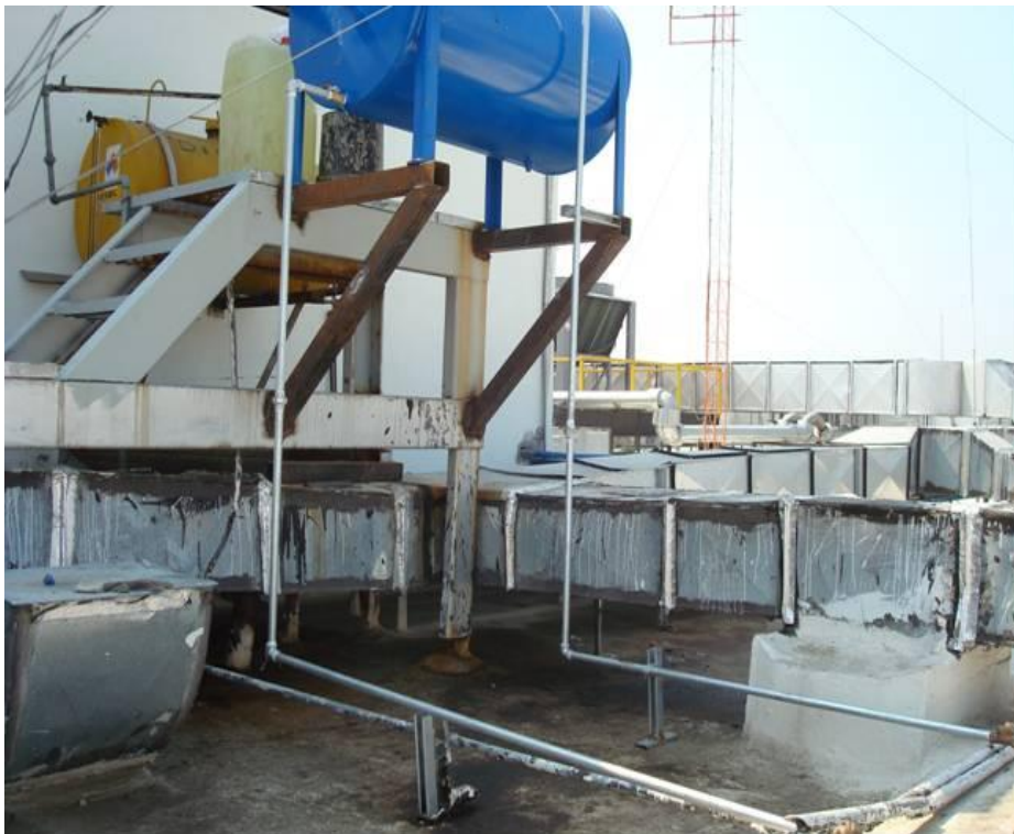
Figura 4.141. Muestra el sistema de líneas de llenado o de retorno del diésel que llegan al tanque de almacén, usado para la planta de emergencia (Baselis, 2010)
