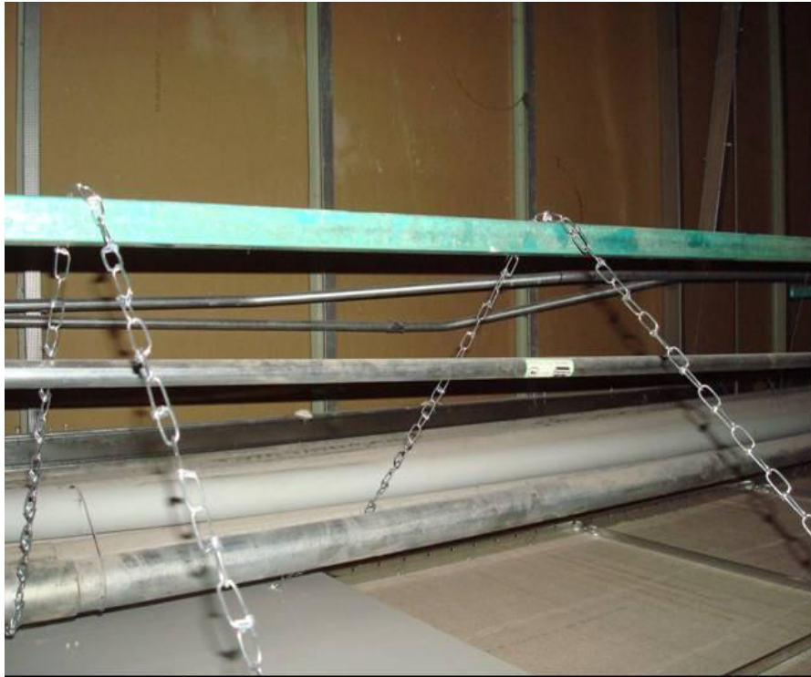
Figura 4.96. Ejemplo de la aplicación de la Figura 4.95, para la soportería en luminarios (Baselis, 2010)
