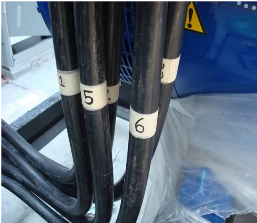
Figura 4.127. Muestra la colocación del cableado y sus marcas para identificación de fases para alimentación de equipos en la subestación (Baselis, 2010)
