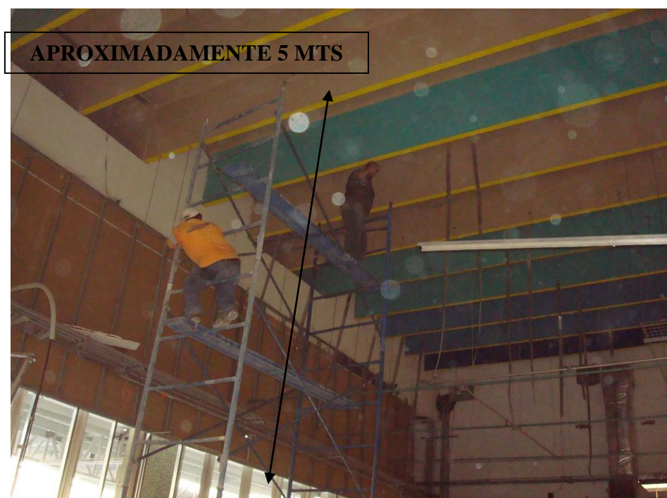
Figura 4.91. Muestra la diferencia de altura entre plafón nuevo y la loza de azotea en la terminal A del aeropuerto, según referencia de la Figura 4.90 (Baselis, 2010)
