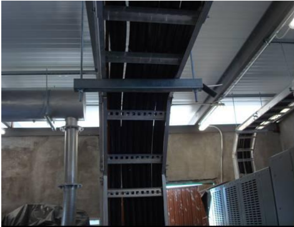
Figura 4.65. Arreglo de cableado para la planta de emergencia y al fondo a la derecha el cableado de la subestación eléctrica hacia la transferencia (Baselis, 2010)
