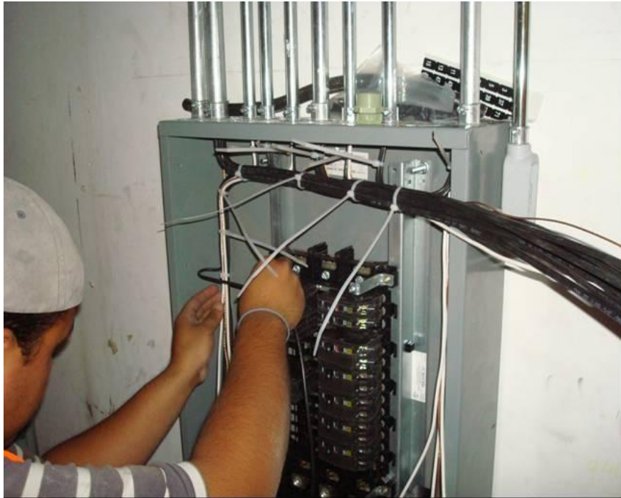
Figura 4.116. Muestra de la instalación del tablero de servicios generales (alumbrado, contactos y aire acondicionado) (Baselis, 2010)
