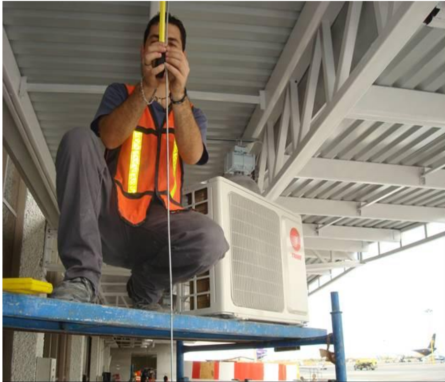
Figura 4.108. Colocación de equipo condensador, con su refrigeración, alimentación eléctrica y soportería (Baselis, 2010)
