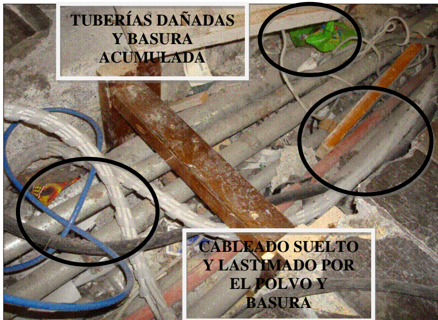
Figura 3.4. Estado de las instalaciones eléctricas de las bandas transportadoras, mostrando cables sueltos, tuberías rotas y basura (AMTY, 2010)
