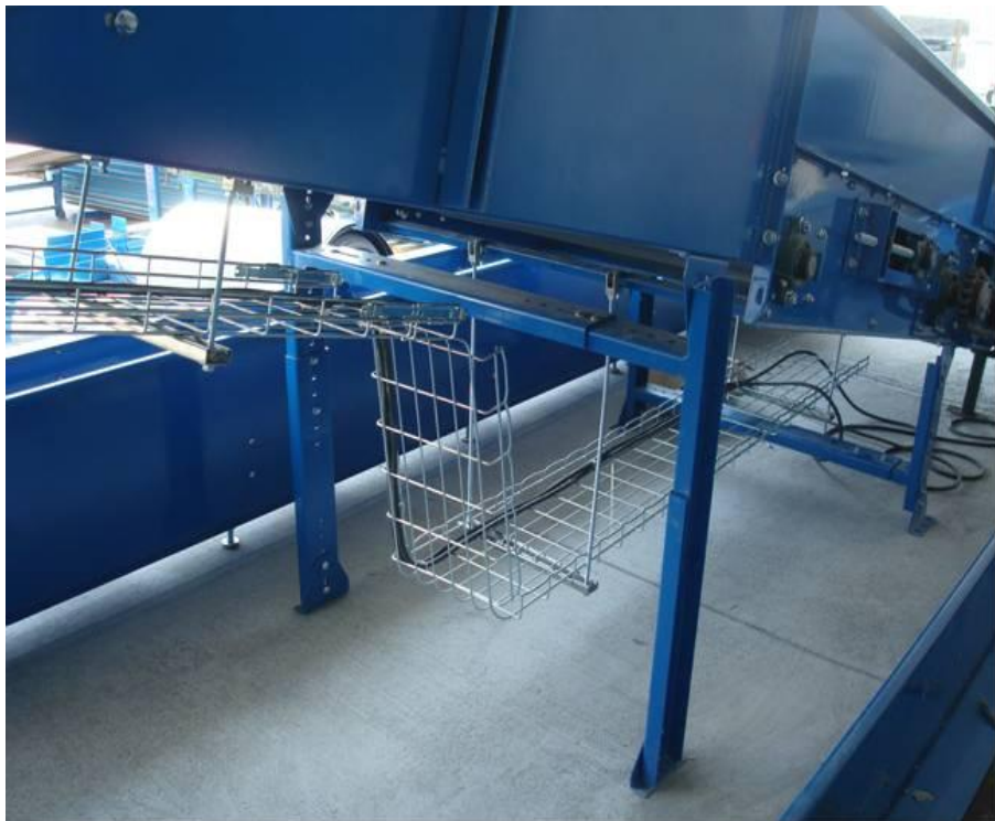
Figura 4.162. Otro esquema de la canalización tipo charola de malla y sus trayectorias debajo de cada módulo conformante del sistema de bandas transportadoras (Baselis, 2010)
