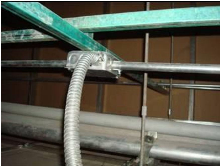
Figura 4.93. Acercamiento a la fijación de canalizaciones y cajas registro en la retícula de PTR de color verde (Baselis, 2010)
