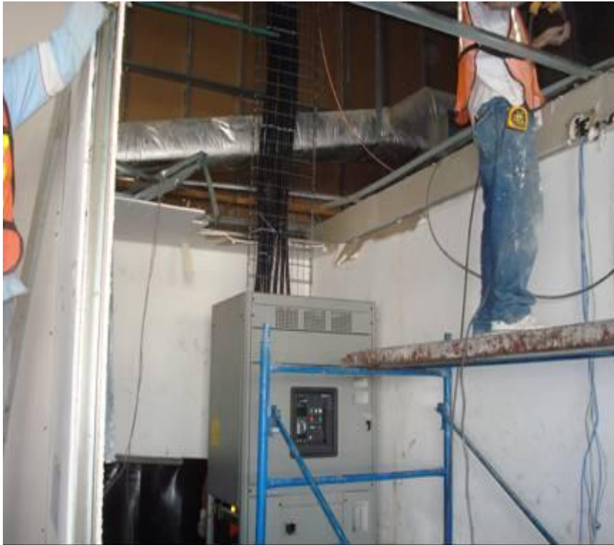
Figura 4.71. Llegada de la trayectoria eléctrica en charola tipo malla hacia el tablero de distribución “FCI” en la zona 2 (Baselis, 2010)
