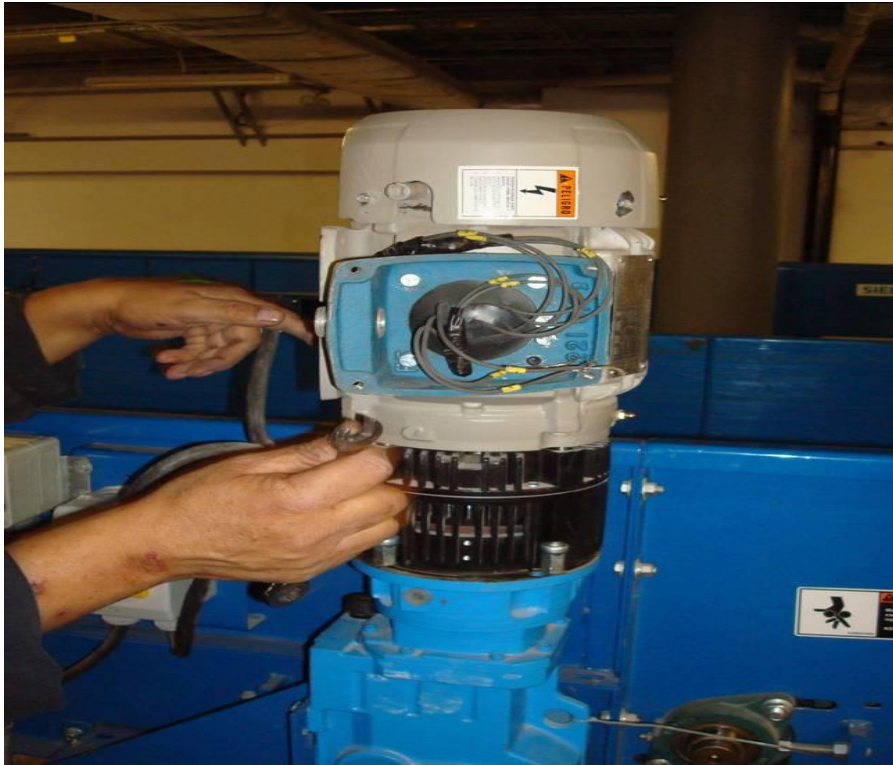
Figura 4.169. Otra conexión de la alimentación eléctrica del motor para cada módulo conformante del sistema de bandas transportadoras (Baselis, 2010)
