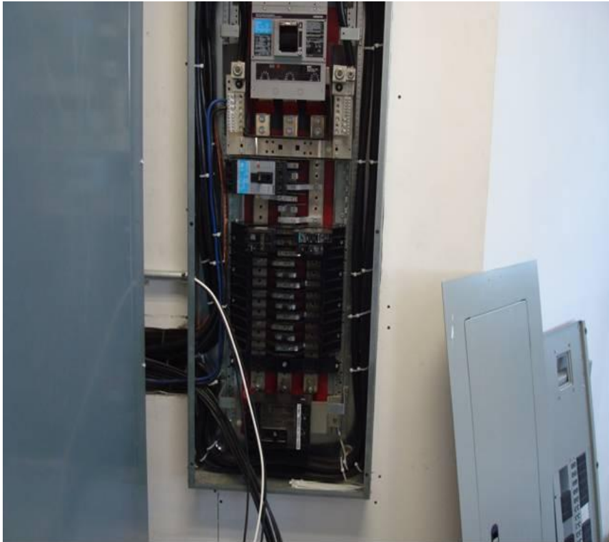
Figura 4.118. Muestra la instalación final del tablero de servicios generales tipo “P2” (Baselis, 2010)
