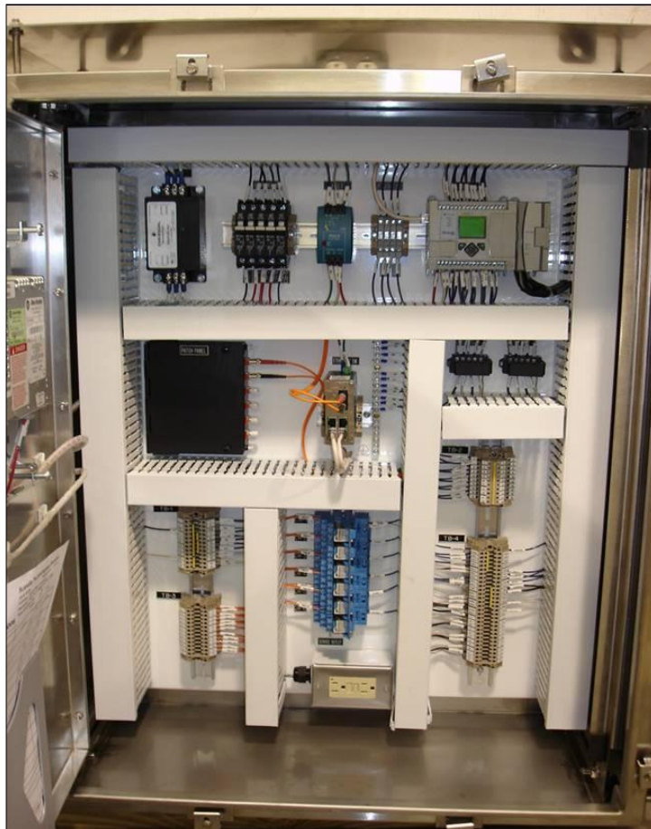
Figura 2.22. Tablero de control "PC" de las bandas transportadoras (Siemens, 2010)
