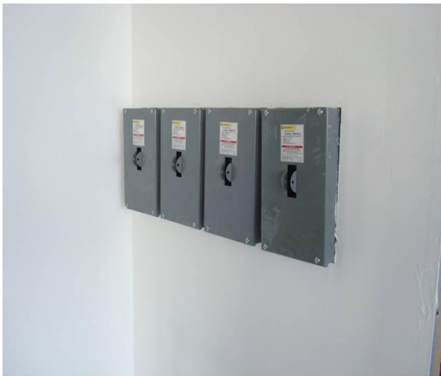
Figura 4.145. Muestra las protecciones eléctricas para alimentación de los equipos UPS para respaldo de los detectores tipo “eXaminer” (Baselis, 2010)
