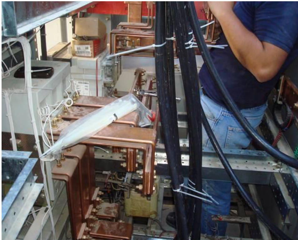
Figura 4.137. Muestra todo el arreglo interior del tablero de transferencia y su forma de cableado general en las barras (Baselis, 2010)
