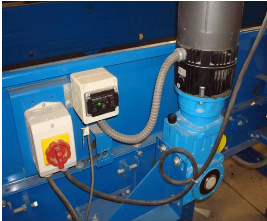
Figura 4.167. Alimentación del motor de engranes y banda, junto a su control para cada módulo conformante del sistema de bandas transportadoras (Baselis, 2010)
