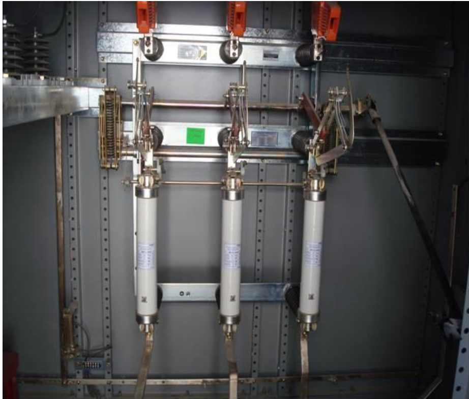
Figura 4.136. Muestra todo el arreglo de las cuchillas en media tensión junto a los fusibles para la subestación del sistema (Baselis, 2010)
