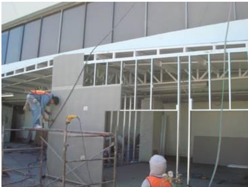
Figura 4.83. Cerrado de muros para las extensiones de oficinas, a base de durock (Baselis, 2010)
