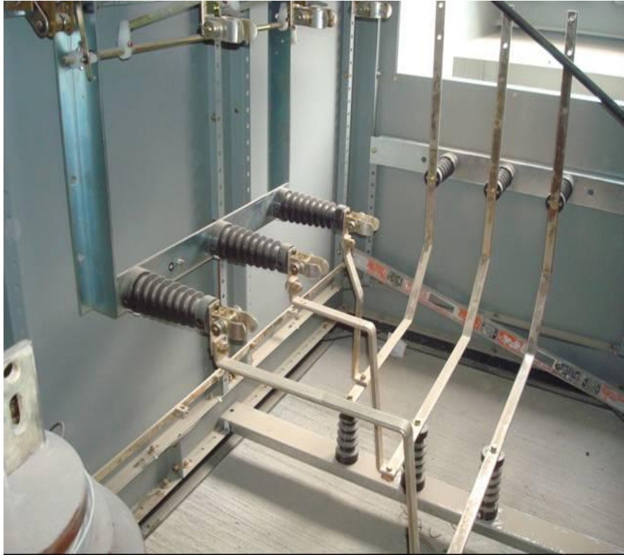
Figura 4.134. Muestra el arreglo de barras para media tensión de la subestación y los huecos para fusibles (Baselis, 2010)
