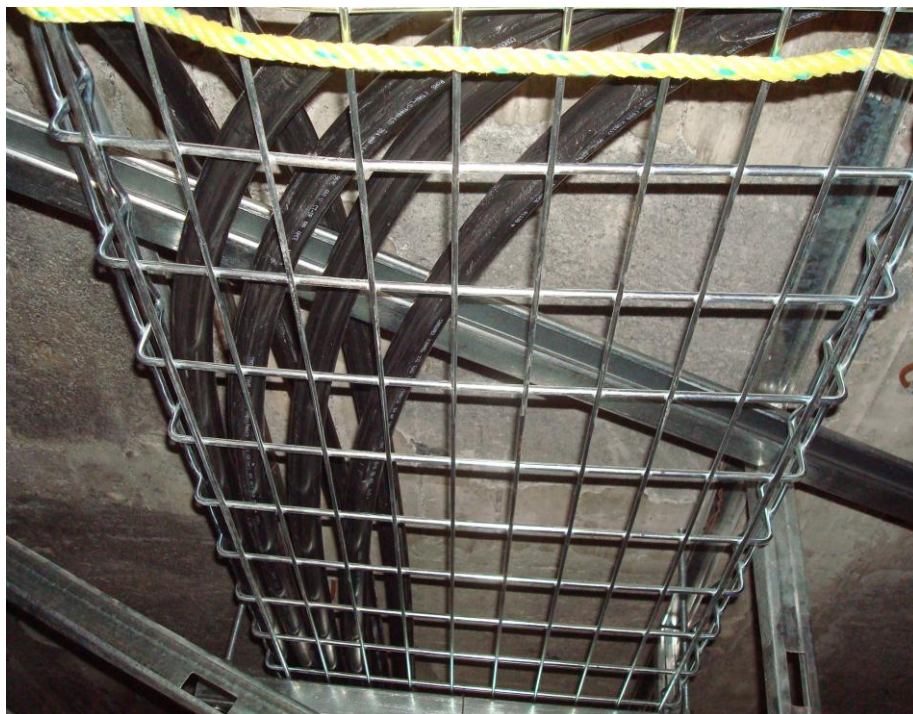
Figura 4.68. Otra parte del arreglo de cableado para la charola que baja hasta zona 2 para el tablero de distribución “FCI” (Baselis, 2010)
