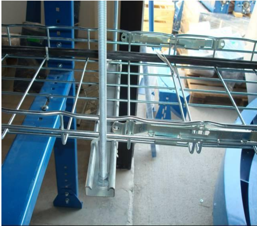
Figura 4.161. Esquema de la canalización tipo charola de malla que va debajo de cada módulo conformante del sistema de bandas transportadoras (Baselis, 2010)
