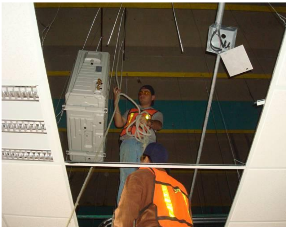
Figura 4.109. Otra colocación de equipo condensador y evaporador, con su refrigeración, alimentación eléctrica y soportería arriba en plafones (Baselis, 2010)
