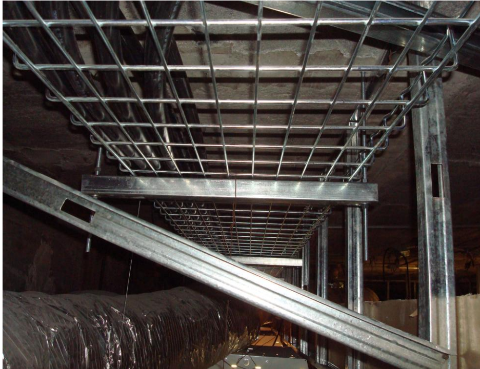
Figura 4.67. Arreglo de cableado para la charola que baja hasta zona 2 en el tablero de distribución “FCI” (cruzando área de oficinas) (Baselis, 2010)
