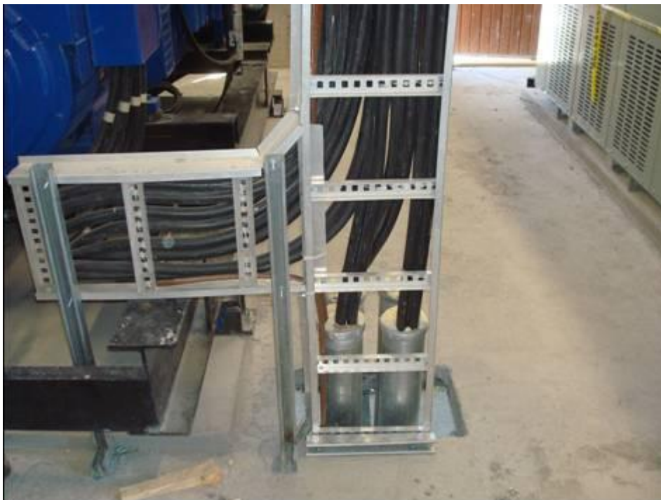
Figura 4.64. Arreglo de cableado para la planta de emergencia y el cableado que va hacia la zona 2 para el tablero “FCI” (Baselis, 2010)
