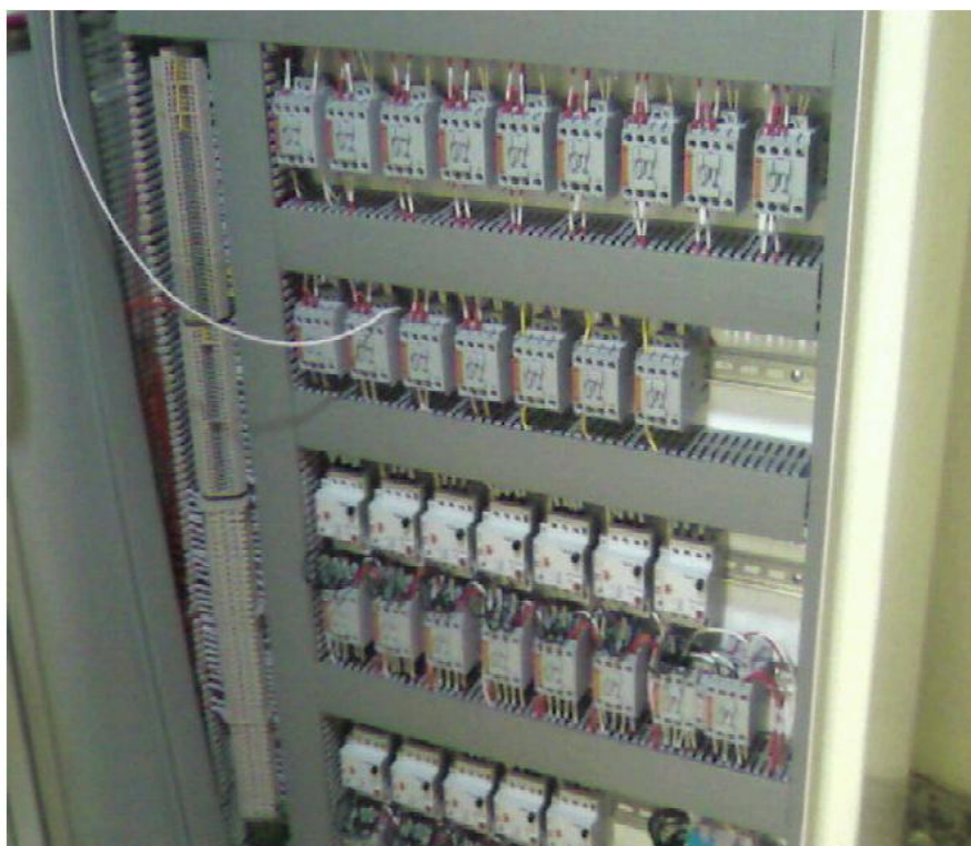
Figura 4.172. Tablero de control “PC” con interruptores derivados a cada módulo individual de las bandas transportadoras (Baselis, 2010)
