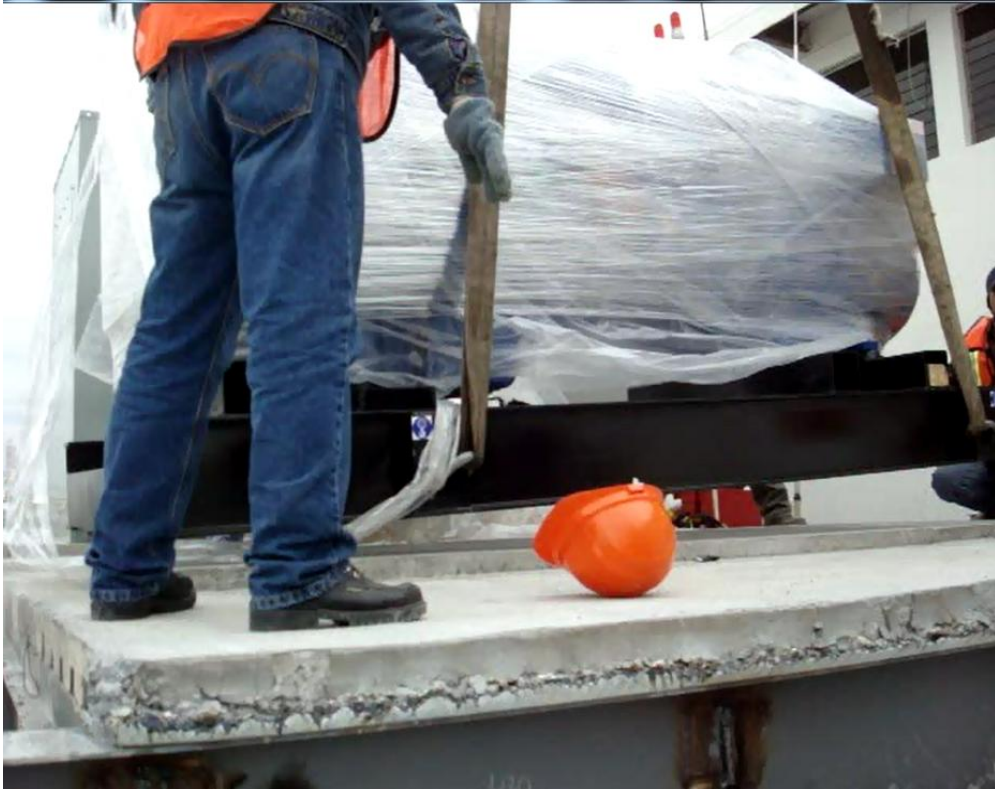
Figura 4.56. Acomodo de equipos (planta de emergencia) según la Figura 4.45, para su Lay Out final (Baselis, 2010)
