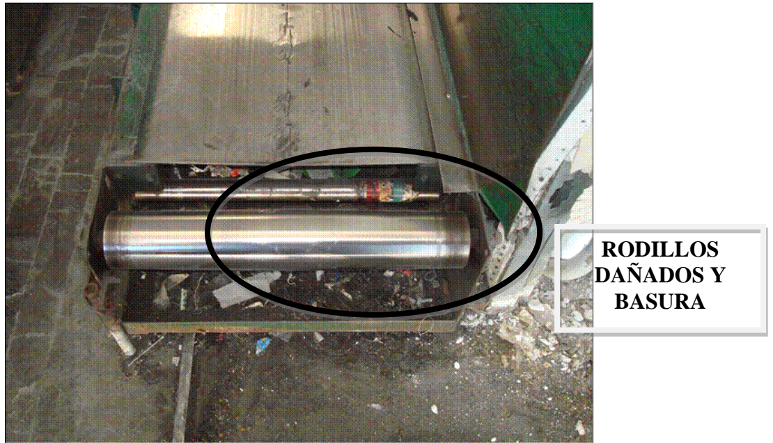
Figura 3.2. Vista física del estado de la banda transportadora donde se nota el daño a los rodillos y el escaso mantenimiento (AMTY, 2010)
