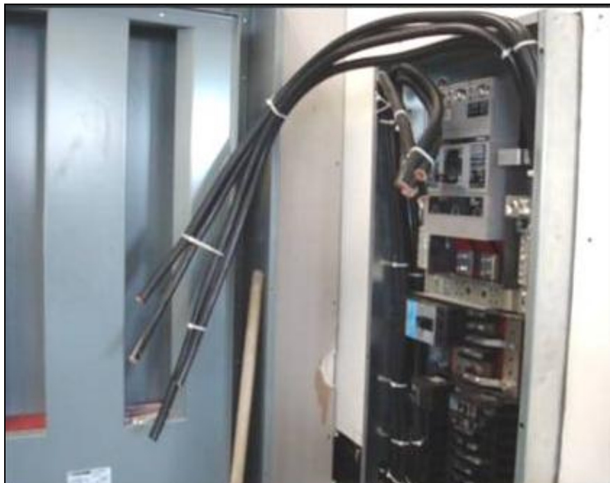
Figura 4.115. Muestra de la instalación del tablero “eXaminer” para los equipos detectores y a su lado el tablero “P2” de servicios (Baselis, 2010)
