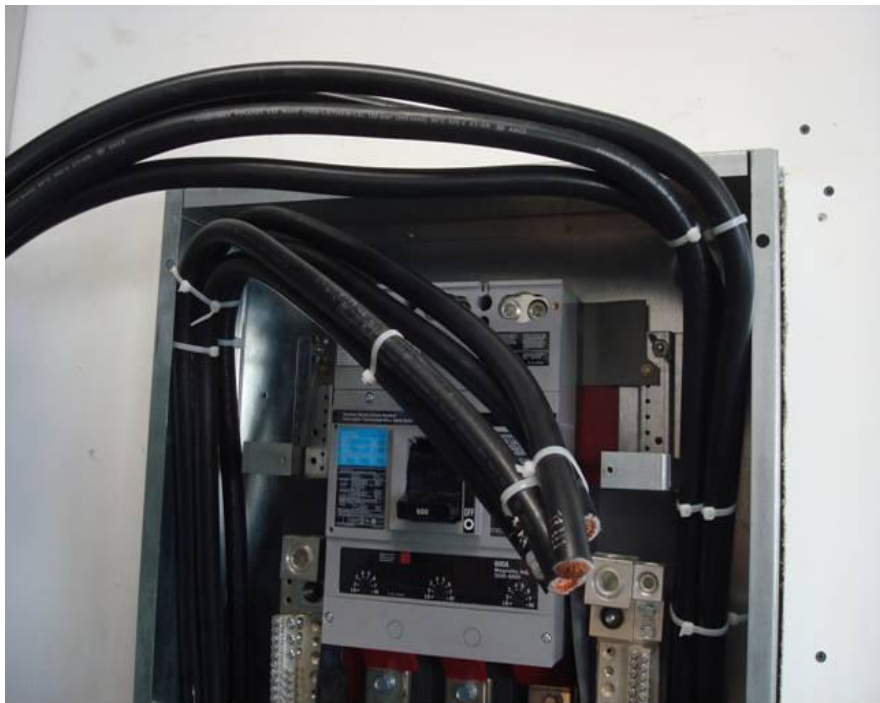
Figura 4.111. Muestra de otros alimentadores generales del tablero “P2” (Baselis, 2010)
