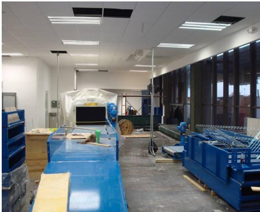
Figura 4.151. Muestra el conjunto de las alimentaciones de los equipos detectores, sus respaldos al fondo a la izquierda y algunos módulos de las bandas (Baselis, 2010)
