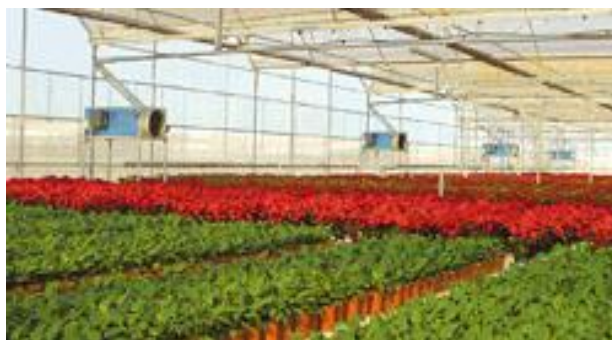
Fig. 2.9 Generador de aire caliente en un invernadero. 19
