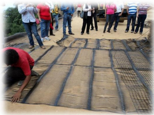
Figura 1.6. Geomalla tipo uniaxial en la construcción de un muro mecánicamente estabilizado en el Libramiento de Jalapa, Veracruz.
