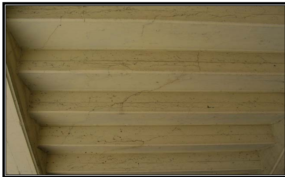
Figura 1.4.4 Fisuras en la estructuras de escaleras.
