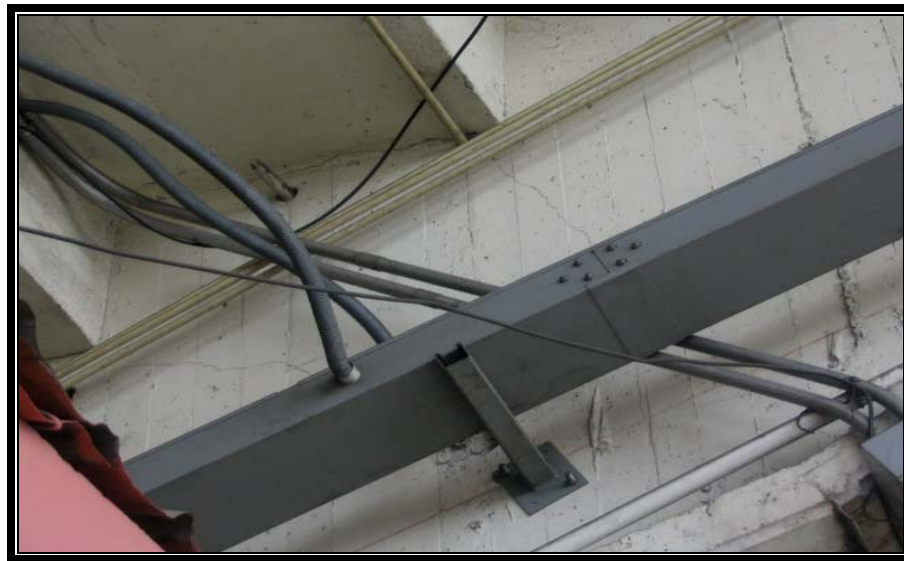
Fig. 2.56. Fisuras en la estructura del estadio Nemesio Camacho el Campín.
