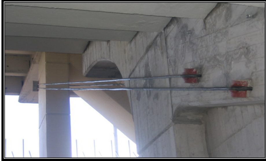
Figura 2.61. Cables de tensionamiento en tribuna oriental.
