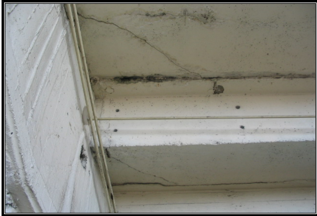
Figura 1.15. Fisuras diagonales en placas de tribunas.
