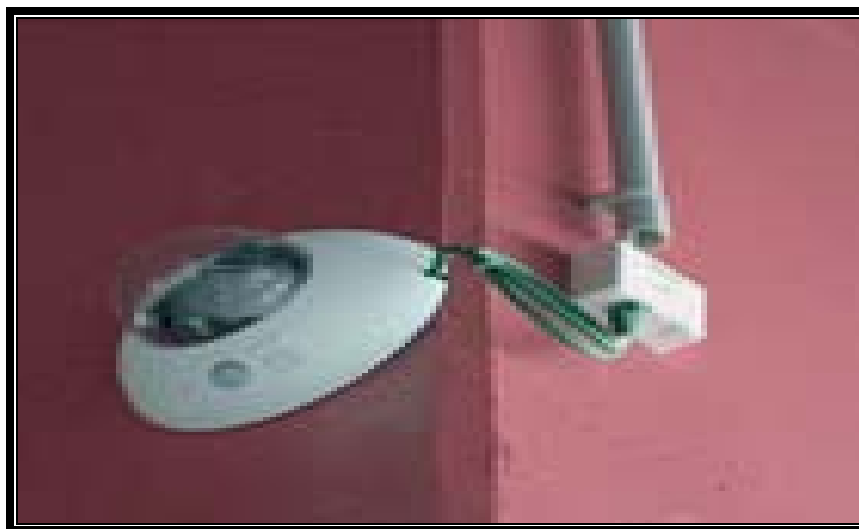
Figura 3.5. Cámara tipo domo para exteriores.
