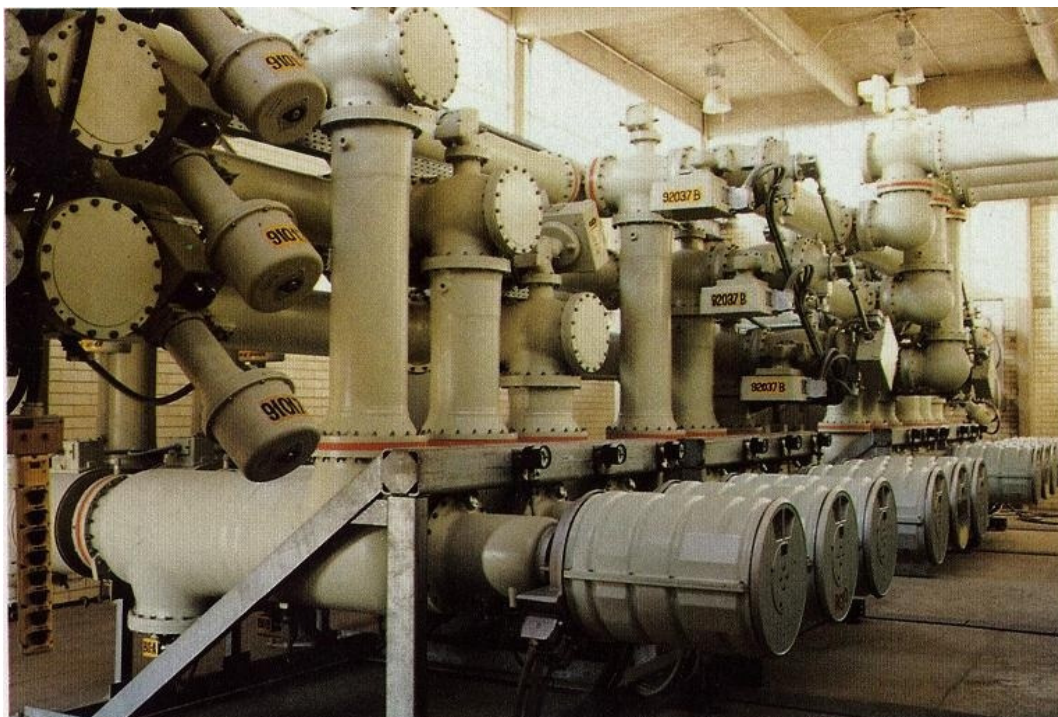
Imagen 3.6. Subestación encapsulada en SF 6
