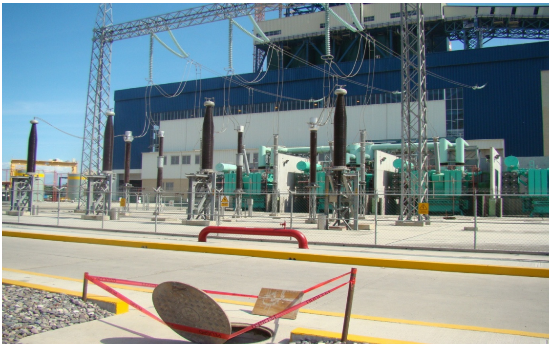
Imagen 3.8.Toma del enlace subterráneo entre el transformador principal del generador No.7 y la subestación LCP.
