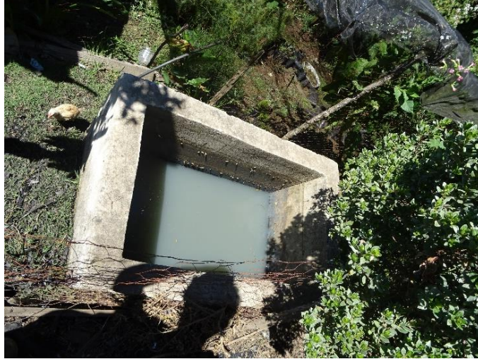
Figura 3.5 Tanque de almacenamiento para reuso de las aguas grises, Joltojtik, municipio de Chamula (Elaboración propia, 2019)
