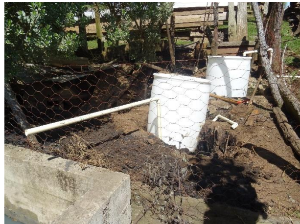
Figura 3.25 Segundo y tercer filtro instalados (Elaboración propia, 2019)
