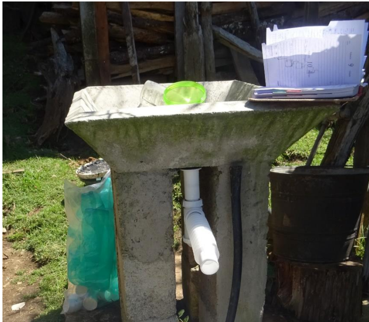
Figura 3.27 Sistema de tubo para fregadero y céspol en batea exterior de vivienda beneficiada (Elaboración propia, 2019)
