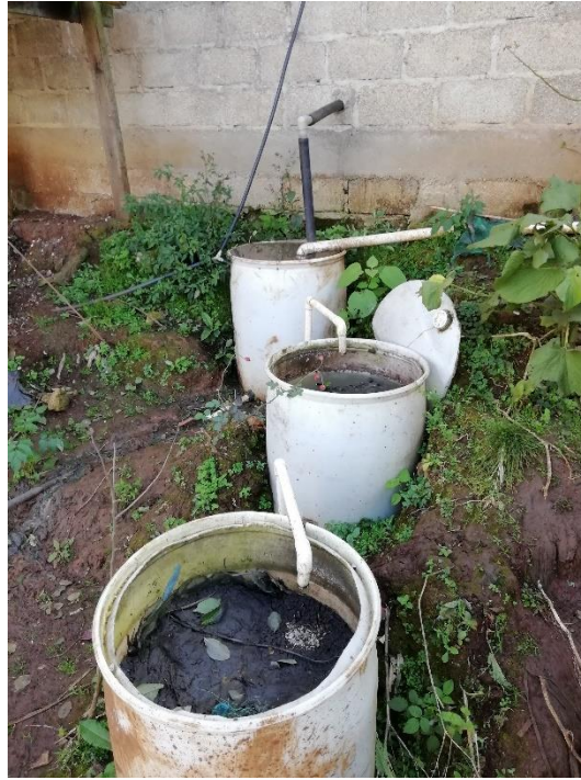
Figura 3.30 Estado del filtro de aguas grises de Don Tumín (Elaboración propia, 2019)
