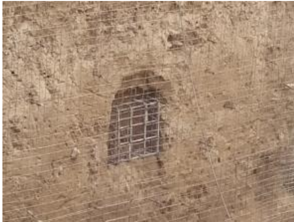
Figura 4.4: Pared de la excavación perfilada, con armado de zapata de reacción de las anclas y con malla de refuerzo.
