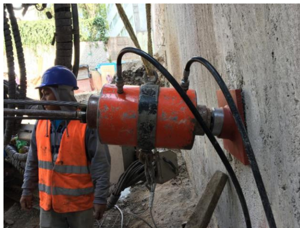
Figura 4.12: Gato hidráulico con capacidad de 300 ton utilizado para el tensado de los torones.
