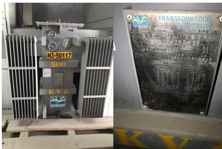
Ilustración 6. Transformador VOLTRAN en aceite. Placa de datos.
