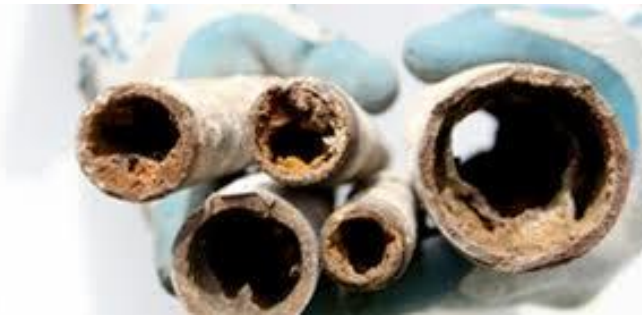
Figura 41. Incrustaciones en tuberías de distribución de agua geotérmica.
