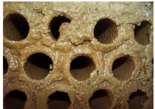
Figura 42. Incrustaciones en Intercambiador de calor de tubos aletados
