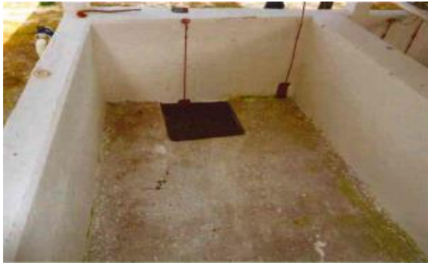
Figura 7. Tanque de cemento utilizado para la fermentación del café. (Caballero Pérez Juan Francisco, 2015)
