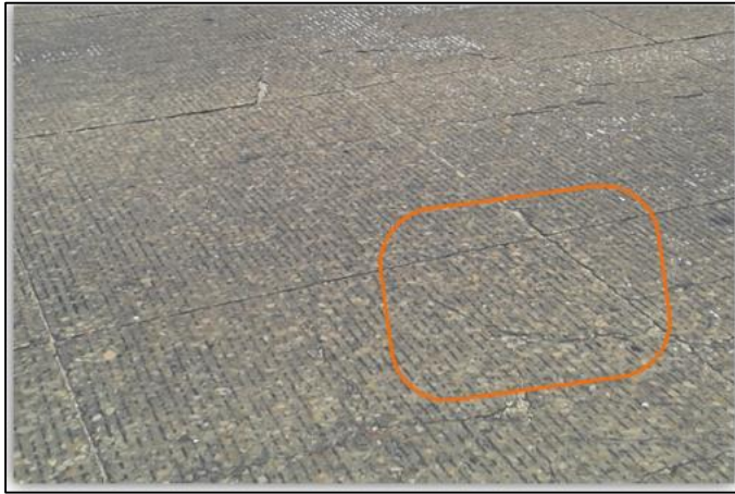
Fig. 2 Falla de colapso en la orilla de una losa de concreto (Recuperado de : https://es.slideshare.net/henryj20/diseo-pavimento-rigido , s.f.)
