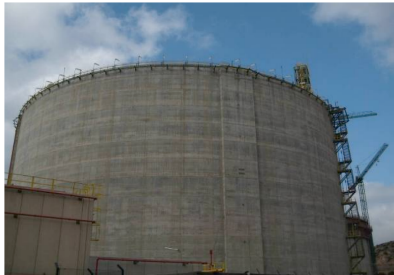
Imagen 20 .- Tanque de gas licuado.
