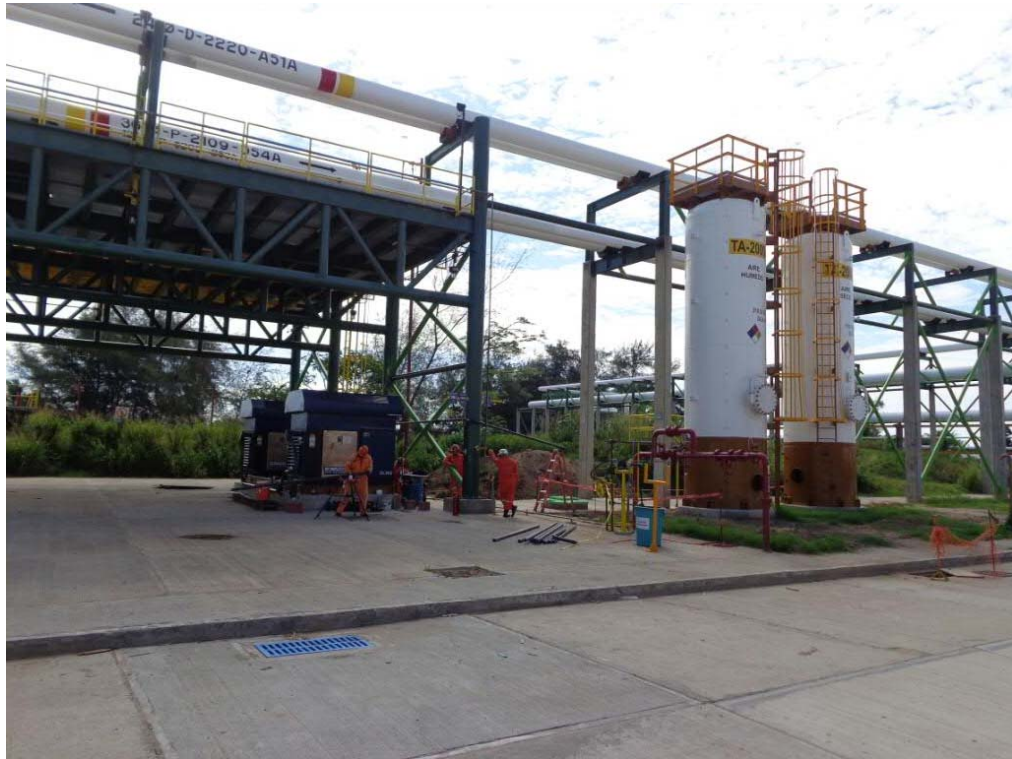
Figura 1.8 Vista del montaje de tuberías para un sistema de compresión y almacenamiento de aire de servicios.
