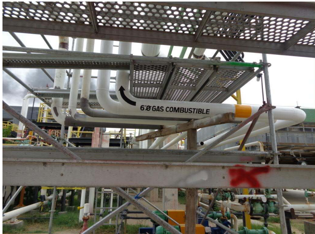
Figura 1.7 Vista de un rack de tuberías en una estación de compresión de gas.
